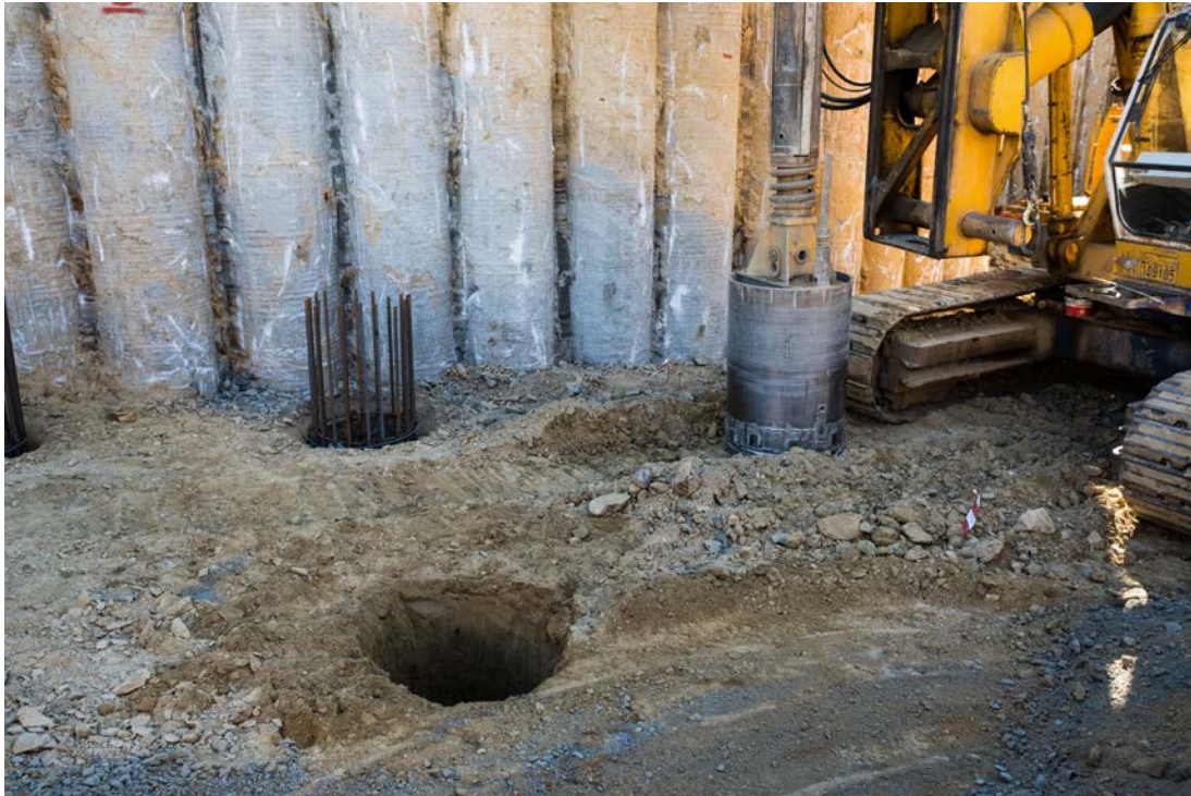
Σχήμα 3.45 Διάνοιξη οπών για την κατασκευή των δύο σειρών πασσάλων που χρησιμοποιήθηκαν για την θεμελίωση του τοίχου.
