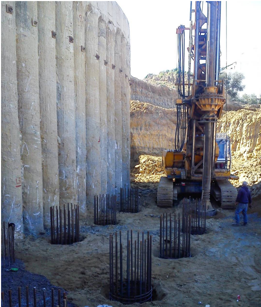
Σχήμα 3.12 Κομμάτι των δύο σειρών πασσάλων στο δεύτερο επίπεδο εργασίας και διάτρηση πασσάλου.
