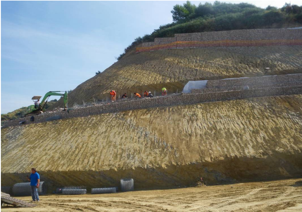
Σχήμα 5.13 Διαδικασία λιθοπλήρωσης στο τμήμα 2 της οδού με εμφανέστατη την πρώτη ήδη κατασκευασμένη σειρά σαρζανέτ
