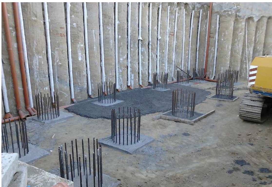
Σχήμα 3.48 Δύο σειρές πασσάλων (θεμέλια τοίχου) ο οποίοι έχουν περάσει και την διαδικασία τσιμεντένεσης.
