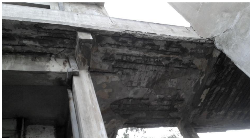
Εικόνα 64. Εμφάνιση οπλισμού σκυροδέματος στην εξωτερική πλάκα του νεότερου κτίσματος
