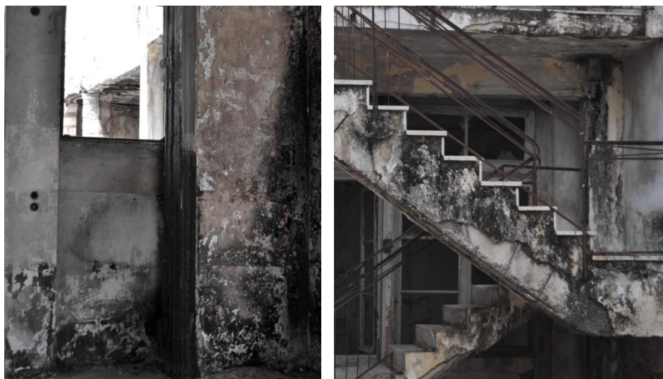
Εικόνες 67 – 68. Αποσάθρωση καμένου επιχρίσματος και εμφάνιση μούχλα και μικροχλωρίδας
