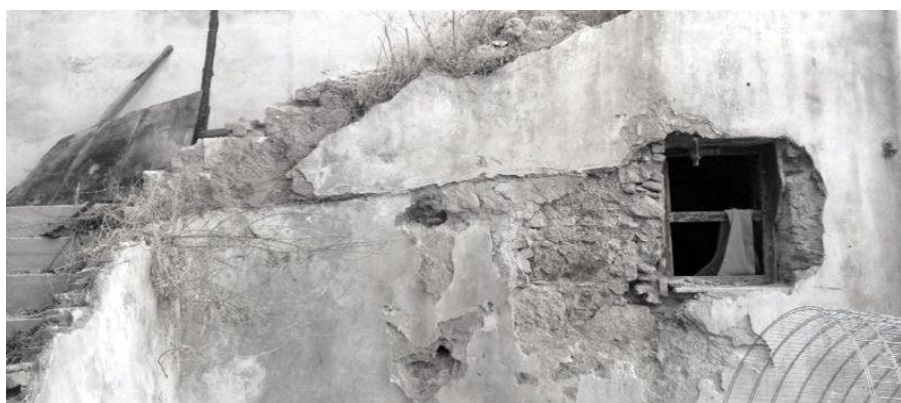
Εικόνες 62 – 63. Κατάρρευση ξύλινων δαπέδων και αποκολλήσεις και αποσαθρώσεις επιχρίσματος
