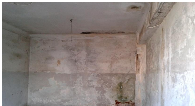
Εικόνες 91 – 92. Ξέπλυμα χρώματος στις τοιχοποιίες
