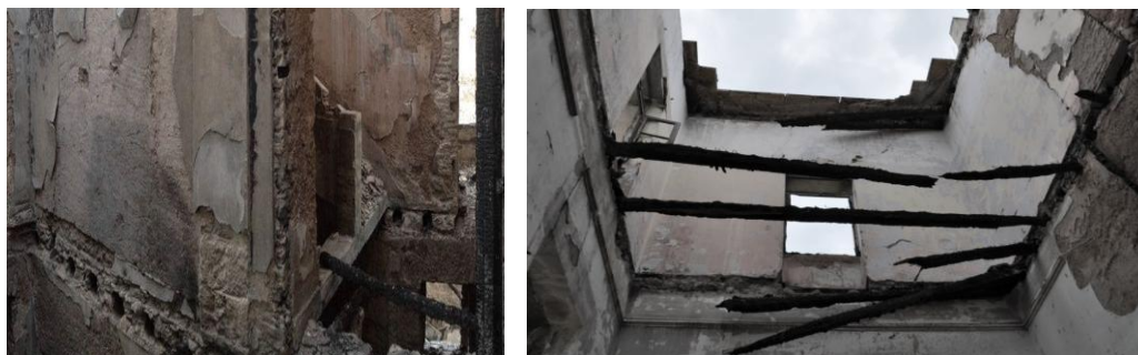
Εικόνες 69 – 70. Εμφανείς δοκοθήκες στην τοιχοποιία και καμένα ξύλινα δοκάρια
