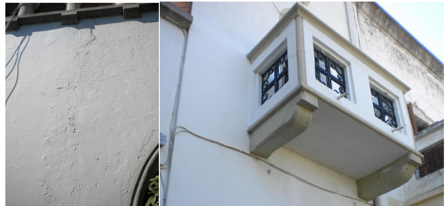
Εικόνα 70. Αποσάθρωση επιχρίσματος όψης (εξωτερικά τμήματος Κ.3). Εικόνα 71. Τριχοειδής ρηγμάτωση δοκαριών εξώστη (ανατολικός εξώστης Δ.3.). Παρουσιάζεται και αποσάθρωση επιχρίσματος και ανάπτυξη μικροοργανισμός (εξωτερικά του Δ.4).
