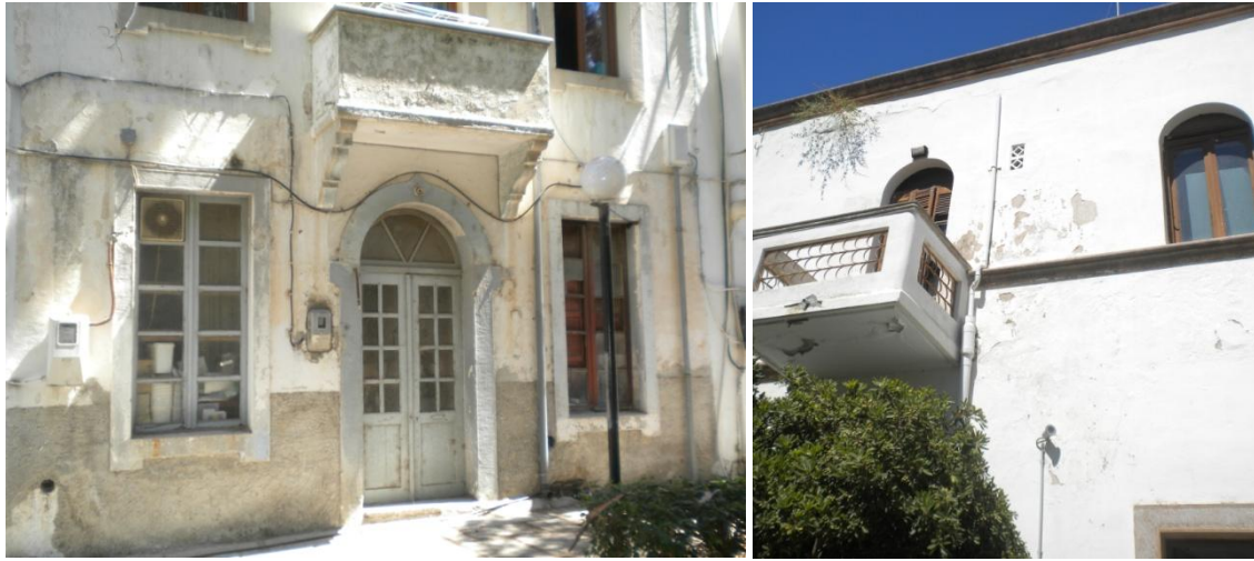
Εικόνα 74. Απόσπασμα δυτικής όψης του τμήματος Κ.4-Δ.4. Παρουσιάζει πολύ εντονότερη φθορά από τα άλλα τμήματα και εξωτερικά. Εικόνα 75. Νότια Όψη τμήματος 2, αποσάθρωση επιχρίσματος, αποκόλληση επιχρίσματος και αποφλοίωση χρώματος. Υπάρχει ακόμα ανάπτυξη χλωρίδας στο στηθαίο(στέψη) και έντονη ρηγματώση στον εξώστη(στην πλάκα).
