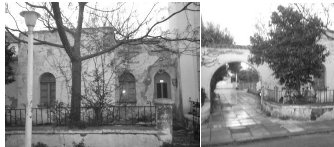
Εικόνα 91 και 92. 394 Όμοια ανάπτυξη μορφολογίας, η κάτοψη αναπτύσσεται σε σχήμα Γ και σημαντικό στοιχείο είναι η καμάρα που σχηματίζεται αριστερά της κατοικίας αυτής (και μιας ακόμα που δεν διατηρείται στην πρωταρχική της μορφή) που σηματοδοτεί την διαμόρφωση κοινόχρηστου χώρου στο εσωτερικό του οικοδομικού τετραγώνου.
