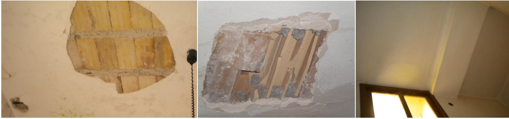
Εικόνα 7. Από το Τμήμα 2. Λόγω φθορών είμαστε σε θέση να διακρίνουμε τα κατασκευαστικά στοιχεία της πλάκας. Βλέπουμε τις καπιζάνες αλλά και τον σπλισμό. 5 Εικόνα 8. Από το τμήμα 1. Ομοίως. 6 Εικόνα 9. Χώρος διαδρόμου Δ.4., κρέμαση εγκάρσιου δοκαριού. 7
