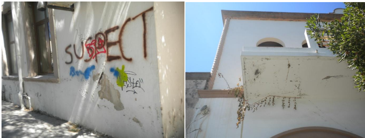
Εικόνα 76. Απόσπασμα δυτικής όψης τμήματος 2. Υπάρχει αποσάθρωση επιχρίσματος, αποκόλληση επιχρίσματος και αποφλοίωση χρώματος και στις ζημιές κατατάσσουμε το graffiti(βανδαλισμός). Εικόνα 77. Έχει αφαιρεθεί επιμελώς τμήμα του στηθαίου του εξώστη, πιθανότατα να ήταν ιδιαίτερα σαθρό και άρα υπήρχε κίνδυνος να καταρρεύσει στο δρόμο.
