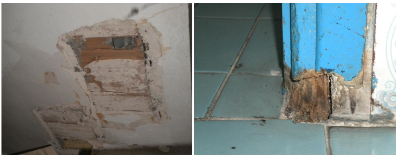
Εικόνα 21. Η αποκόλληση επιχρίσματος στην οροφή μας επιτρέπει να διαπιστώσουμε και την κατασκευαστική δομή του καθώς αποκαλύπτονται οι καπιζάνες. (Διαπιστώνεται στον χώρο του w.c. που διαμορφώνεται ως πατάρι από την εγκατάσταση της ψευδοροφής.) Εικόνα 22. Κάσωμα ,στον χώρο 030, που βρίσκεται σε σήψη. 5
