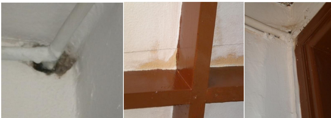
Εικόνα 23. Διαμπερής οπή στην τοιχοποιία για εγκατάσταση σωληνώσεων (χώρος 030). Εικόνα 24. Ανάπτυξη μικροοργανισμών στην ψευδοροφή του χώρου 026 που είναι ο άμεσα επηρεαζόμενος από τη ζημιά που παρουσιάζει ο χώρος 016. Λόγω της ψευδοροφής δεν έχουμε σαφή εικόνα. Εικόνα 25. Αποσάθρωση τοιχοποιίας , εμφάνιση ρηγματώσεων (φθορές) και διάτρηση τοιχοποιίας για εγκατάσταση σωληνώσεων -η κακή συντήρηση των οποίων ευθύνεται για την σημειακή εμφάνιση υγρασίας- (ζημιά) στο χώρο 027. 6
