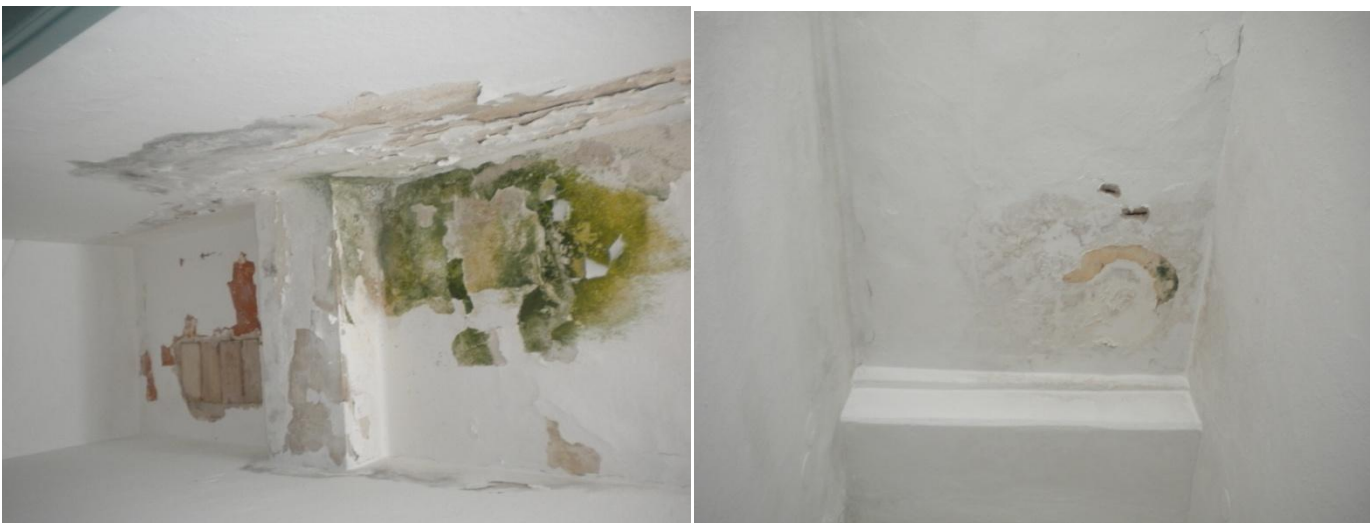
Εικόνα 59 και Εικόνα 60. Αποσάθρωση , αποκόλληση επιχρίσματος , αποφλοίωση χρώματος, ανάπτυξη μικροοργανισμών. Έχει αποκαλυφθεί η πλήρωση της πλάκας με καπιζάνες και μέρος του σπλισμού(χώρος 160).
