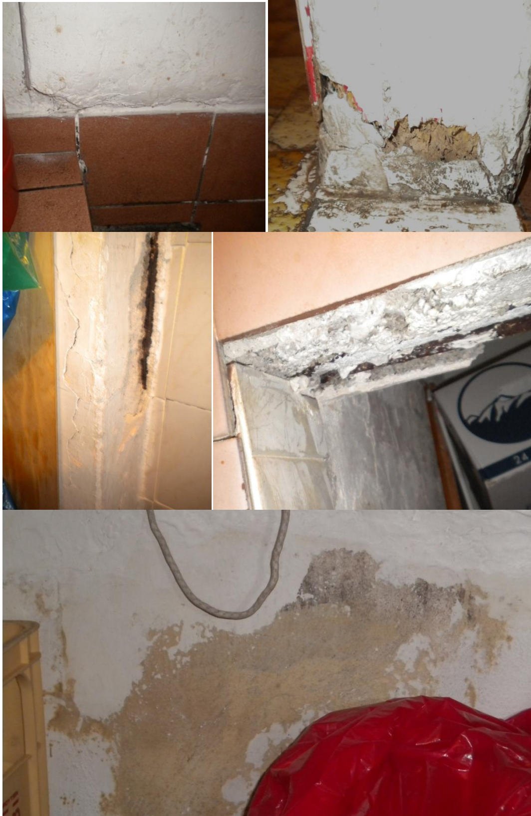
Εικόνα 4. Αποσάθρωση τοιχοποιίας χώρου 012. Εικόνα 5. Κατάσταση αποσύνθεσης κουφωμάτων βοηθητικών χώρων, χώρος 015. Εικόνα 6 και Εικόνα 7 Αποκάλυψη οπλισμού, λόγω αποσάθρωσης που προκαλείται από την οξείδωση τους. Λόγω διάβρωσης παρατηρείται και η εμφάνιση ρηγματώσεως. Εικόνα 8. Αποκόλληση σαθρού επιχρίσματος. 2
