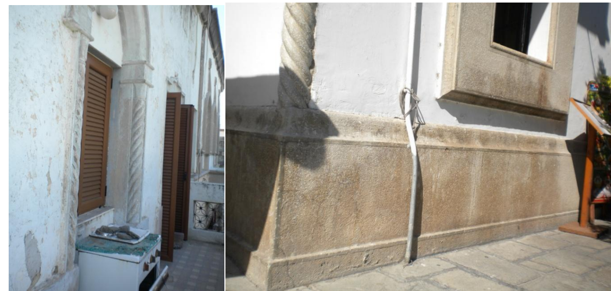
Εικόνα 72. Αποσάθρωση επιχρίσματος, αποκόλληση τμήματος επιχρίσματος, τριχοειδής ρηγμάτωση και ανάπτυξη μικροοργανισμών (ανατολική όψη Δ.4). Εικόνα 73. Ανάπτυξη μικροοργανισμών και αποσάθρωση επιχρίσματος (εξωτερικά του Κ.1).
