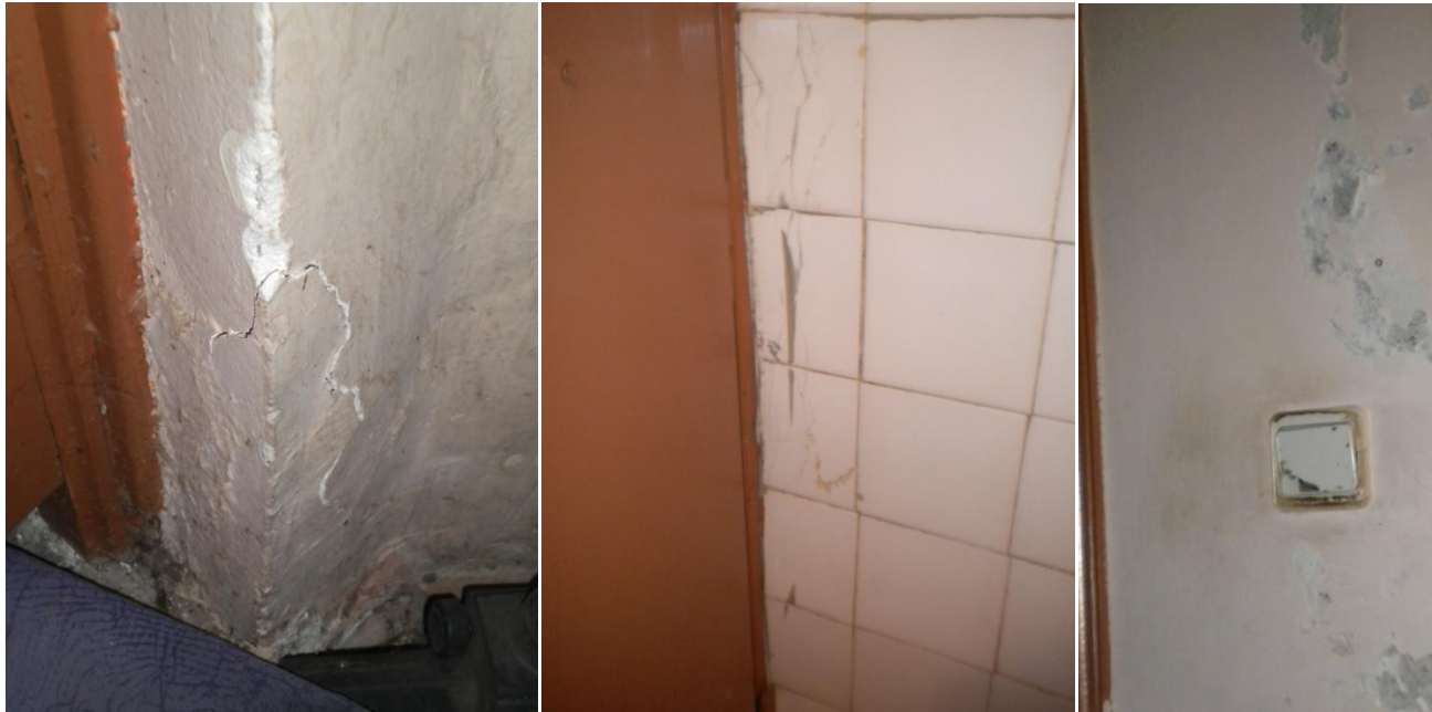
Εικόνα 12. Αποσάθρωση επιχρίσματος λιθοδομής, χώρος 023. Εικόνα 13. Η αποσάθρωση επιχρίσματος με επέκταση στο συνδετικό κονίαμα ,οδηγεί εδώ, σε θραύση των πλακιδίων w.c.(χώρος 025) Εικόνα 14. Ανάπτυξη μικροοργανισμών, αποκόλληση επιχρίσματος, χώρος 022. 3
