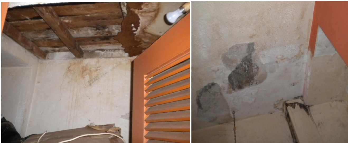
Εικόνα 15. Ανάπτυξη μικροοργανισμών, εμφάνιση ρωγμών, αποσάθρωση και τμηματική αποκόλληση επιχρισμάτων. Το ξύλινο μεσοπάτωμα που χωρίζει ,κάθετα, τους δύο αποθηκευτικούς χώρους είναι σε κατάσταση αποσύνθεσης (χώρος 018). Ζημιά που προκύπτει από την απώλεια νερού των σωληνώσεων του λουτρού. Εικόνα 16. Ανάπτυξη μικροοργανισμών, εμφάνιση ρωγμών, αποσάθρωση και τμηματική αποκόλληση επιχρισμάτων και ενανθράκωση του σκυροδέματος(χώρος 022). Ζημιά που προκύπτει από την απώλεια νερού των σωληνώσεων της κουζίνας.
