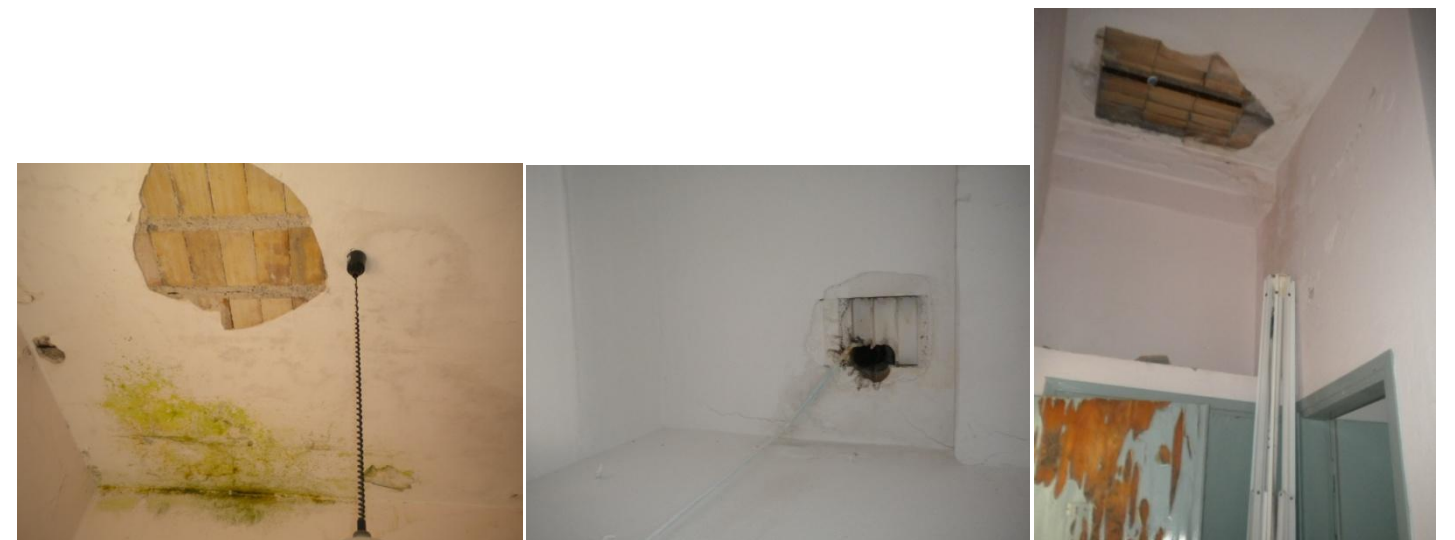
Εικόνα 62. Αποσάθρωση , αποκόλληση επιχρίσματος , αποφλοίωση χρώματος, ανάπτυξη μικροοργανισμών. Έχει αποκαλυφθεί η πλήρωση της πλάκας με καπιζάνες και μέρος του σπλισμού(Δωμάτιο 4) Εικόνα 63. Διαμετρής οπή στην πλάκα , εμφάνιση πλήρωσης με καπιζάνες , ανάπτυξη μικροοργανισμών και αποσάθρωση επιχρίσματος(ζημιά),(χώρος 140). Εικόνα 64. Αποσάθρωση και αποκόλληση επιχρίσματος, τριχοειδής ρωγμές στο δοκάρι(λόγω οξειδωσης του σπλισμού) , ανάπτυξη μικροοργανισμών και αποφλοίωση χρώματος κουφώματος. Έχουν αποκαλυφθεί οι καπιζάνες και μέρος του σπλισμού(Δωμάτιο 1).
