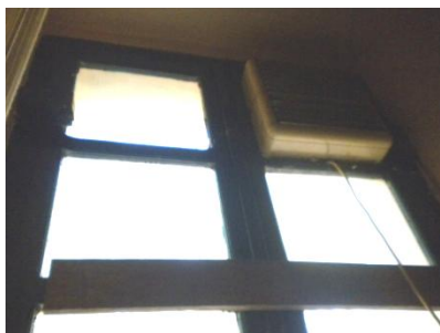
Εικόνα 17. Ζημιά σε αρχικά κουφώματα λόγω τοποθέτησης εγκαταστάσεων εξαερισμού (χώρος023). 4
