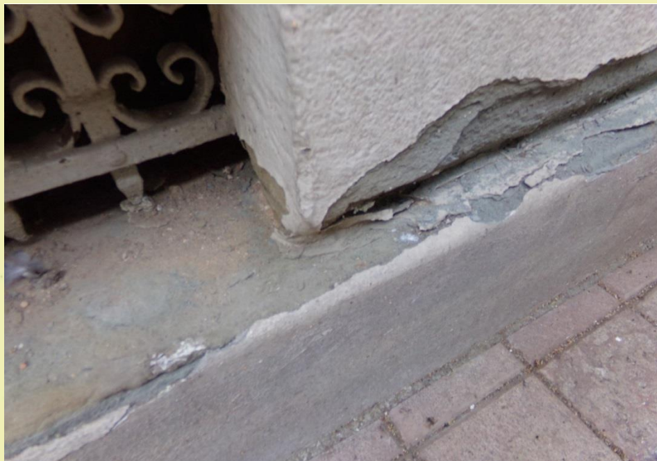
Εικόνα 54: Αποσάθρωση του λίθου και αποφλοίωση του χρωματισμού
