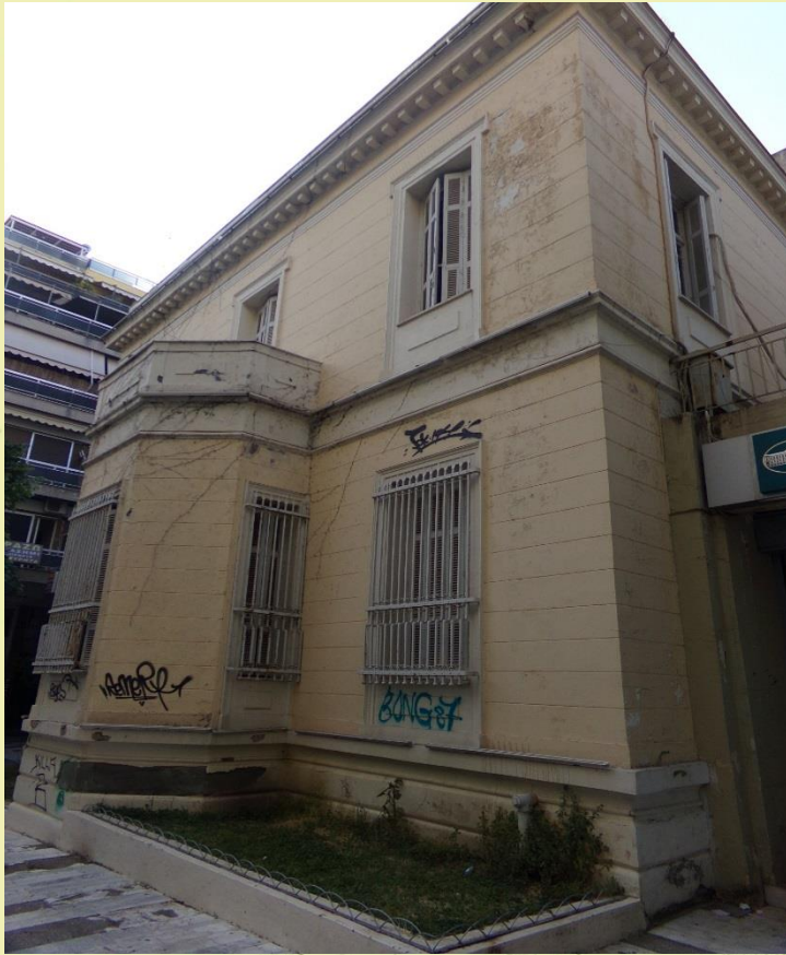
Εικόνα 68: Αποφλοίωση περιμετρικά των ανοιγμάτων και καφέ κηλίδες συσσωρευμένης υγρασίας.
