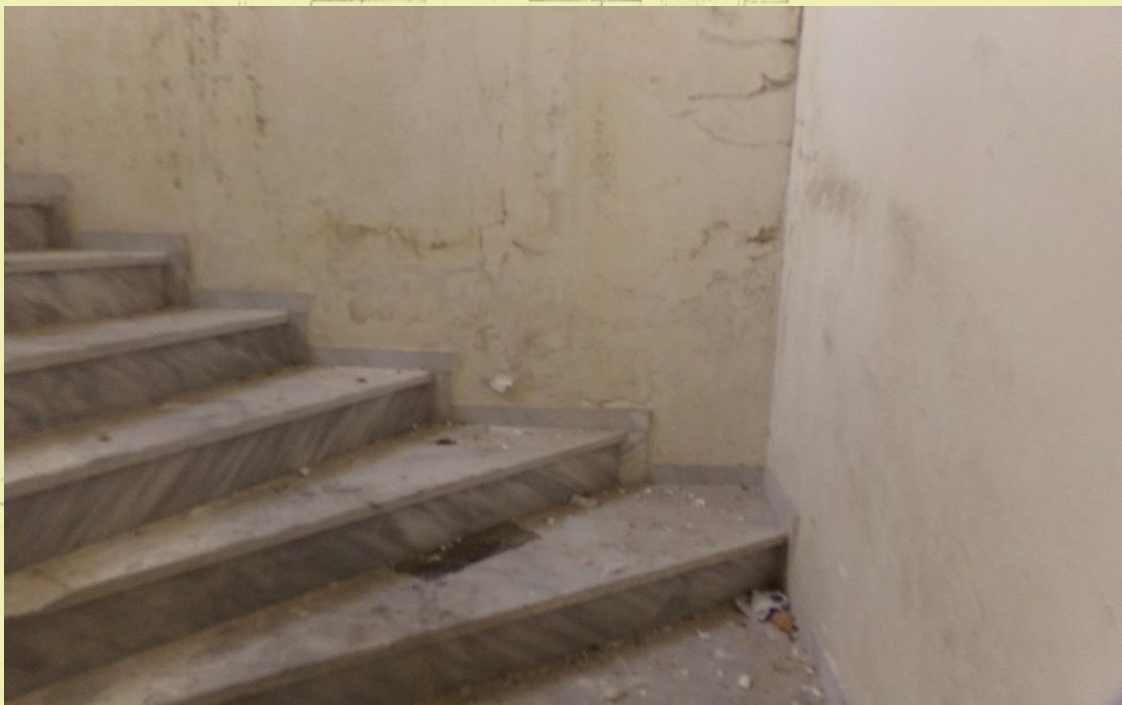
Εικόνα 24: Κηλίδες μούχλας και αποχρωματισμός της τοιχοποιίας στο κλιμακοστάσιο.
