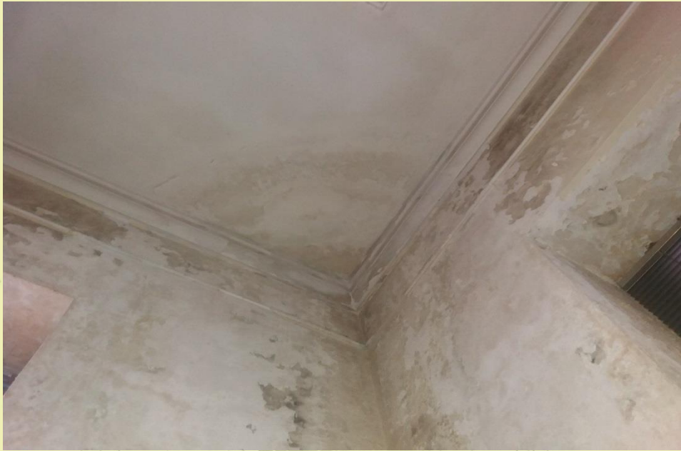
Εικόνα 34: Η οροφή του αναψυκτήριου εμφανίζει μεγάλα στίγματα που υποδεικνύουν την ύπαρξη υγρασίας.
