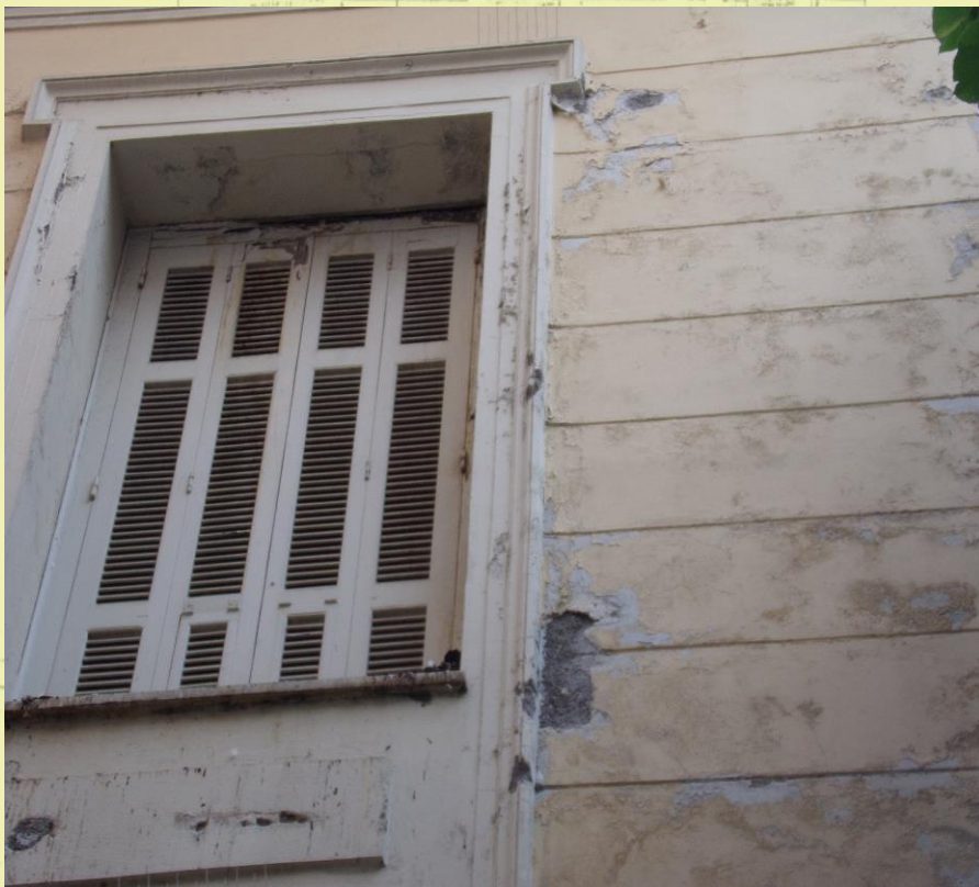
Εικόνα 65: Τοπική κατάρρευση των γύψινων στοιχείων περιμετρικά του παραθύρου και αποσάθρωση της τοιχοποιίας στο δεξί άνοιγμα του ορόφου στη βόρεια όψη.
