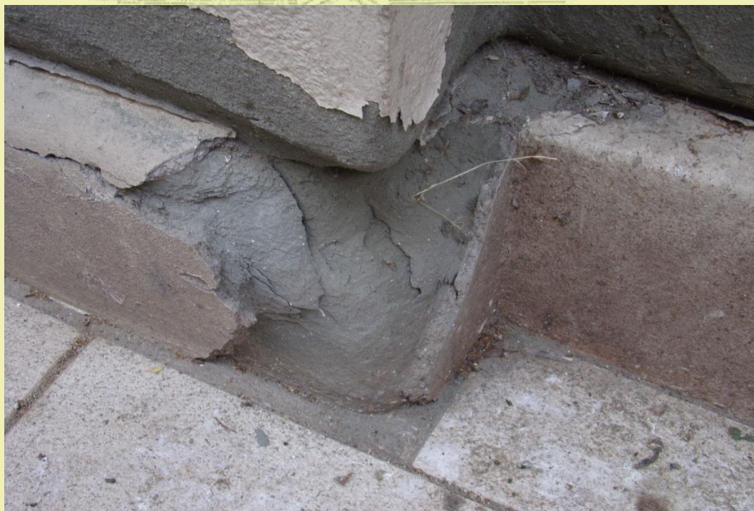
Εικόνα 53: Τοπική κατάρρευση του στοιχείου και ρωγμές που τείνουν να θρημματίσουν το στοιχείο.
