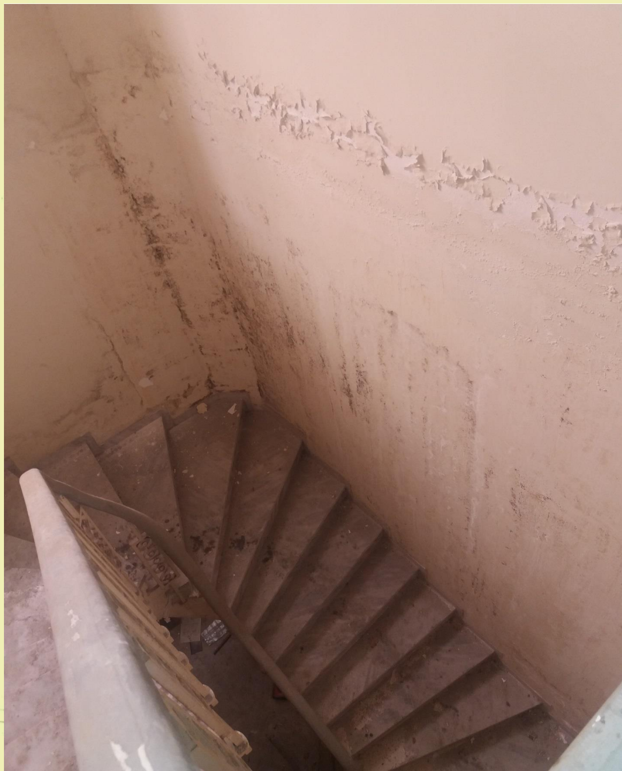
Εικόνα 40: Άλωση του κλιμακοστασίου και των επιπτώσεων της υγρασίας στην τοιχοποιία.
