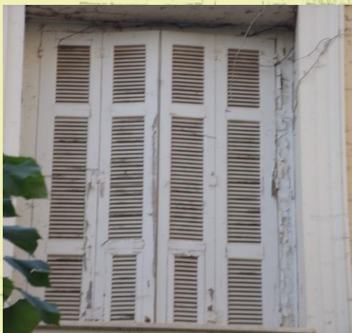
Εικόνα 69: Τα γαλλικά παντζούρια παρουσιάζουν αποφλοίωση του χρώματος και ρωγμές που τείνουν να θρυμματίσουν το ξύλο.
