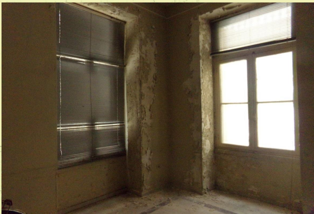
Εικόνα 8: Η παθολογία των ανοιγμάτων αφορά αποφλοίωση του χρωματισμού, ζαχαροειδή φθορά και σκούρες κηλίδες.
