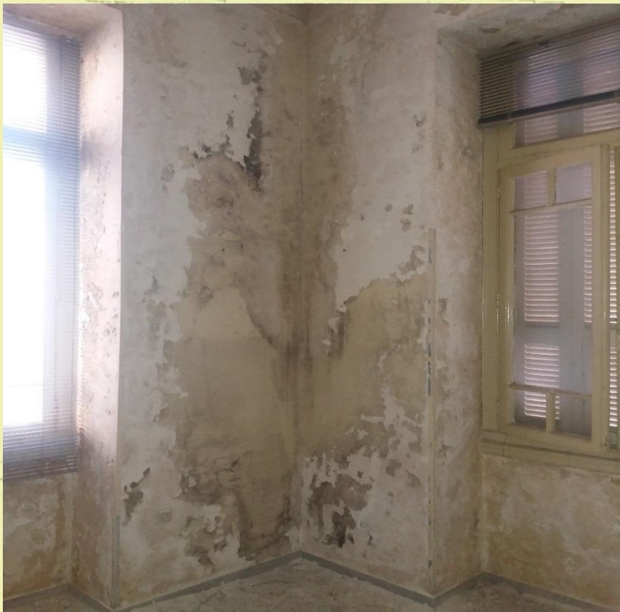
Εικόνα 30: Αποβολή του χρωματισμού και μαύρα στίγματα πούλας με συνδυασμό με ζαχαρωσιδή φθορά περιμετρικά των παραθύρων.
