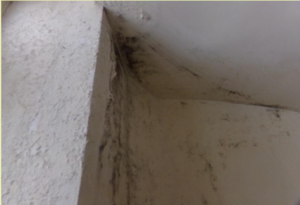
Εικόνα 25: Κάθετα μάρμα στίγματα μούχλας σε συνδυασμό με ζαχαροειδή φθορά στον ουρανό της κλίμακας.
