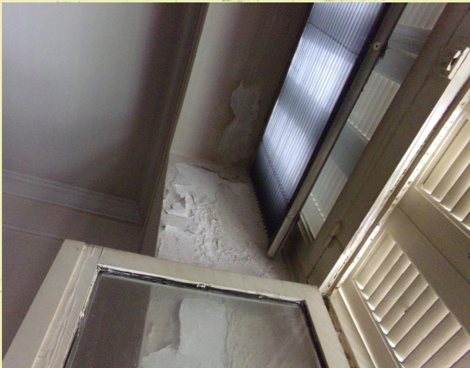
Εικόνα 16: Οι φθορές έχουν εξαπλωθεί περιμετρικά στο άνοιγμα.
