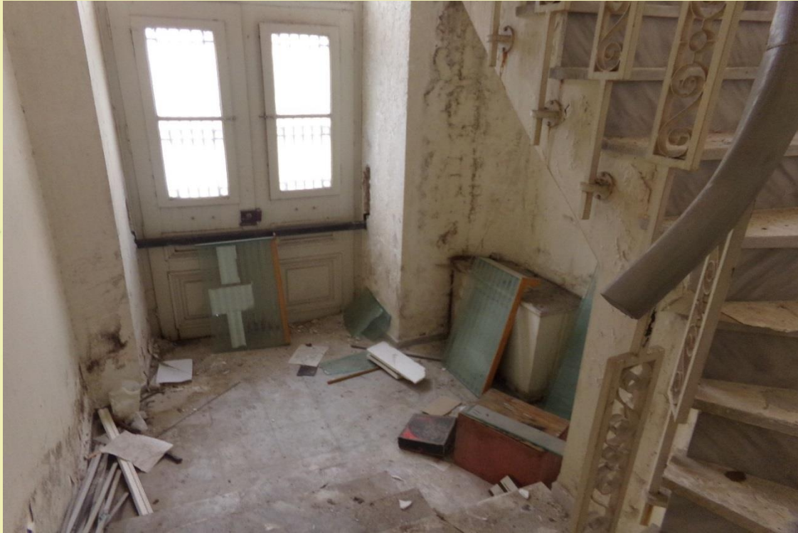
Εικόνα 23: Ο χώρος του κλιμακοστασίου με εμφανή την επίδραση της αμοιικής υγρασίας.
