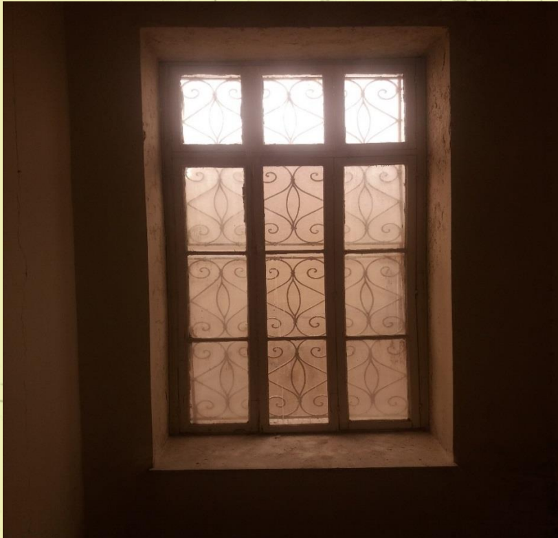
Εικόνα 39: Το βόρειο άνοιγμα του κλιμακοστασίου με τα μεταλλικά κιγκλιδώματα εξωτερικά και το μεταλλικό κούφωμα εσωτερικά.
