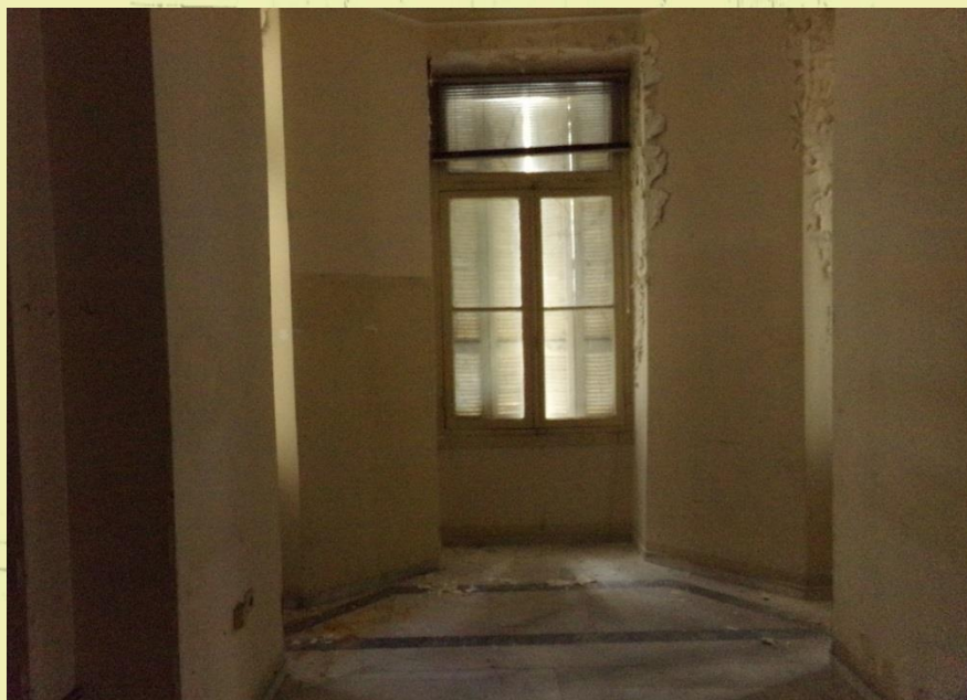
Εικόνα 12: Το κεντρικό άνοιγμα του έρκερ εμφανίζει περιμετρικά σημάδια ζαχαρωδούς φθοράς.
