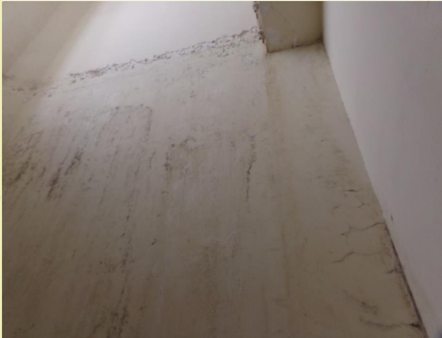
Εικόνα 27: Η παθολογία της τοιχοποιίας σταματά στο ύψος της πλάκας του ορόφου.
