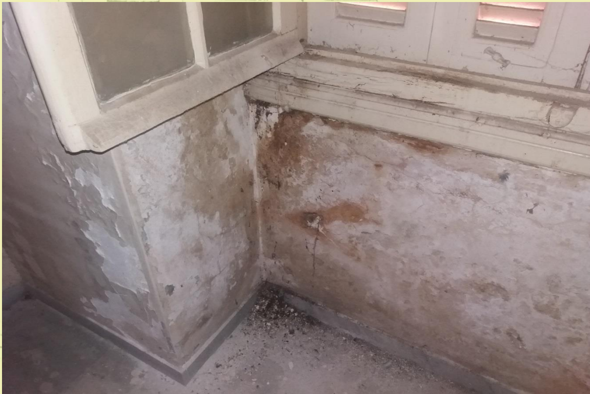
Εικόνα 35: Η ποδιά του ανώματου της νότιας πλευράς παρουσιάζεται ερισσώς παραμορφωμένη.
