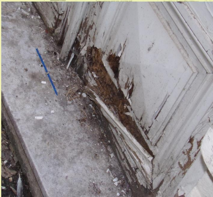
Εικόνα 59: Η διαβρωμένη εύλιγη ταπλοδοσμή θάρα της βόρειας όψης.
