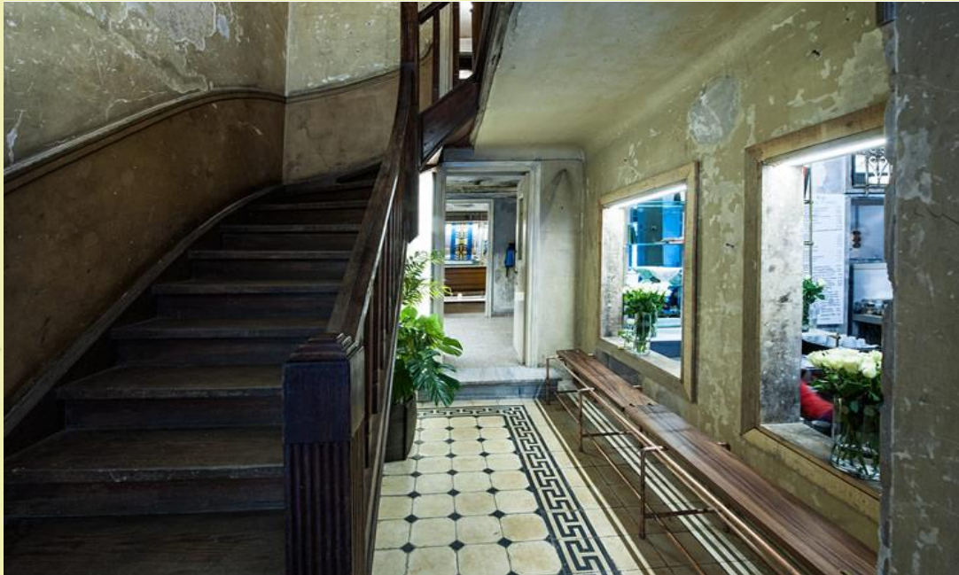
Αποψη της ξύλινης σκάλας με εμφανείς τις φθορές στην τοιχοποιία.
