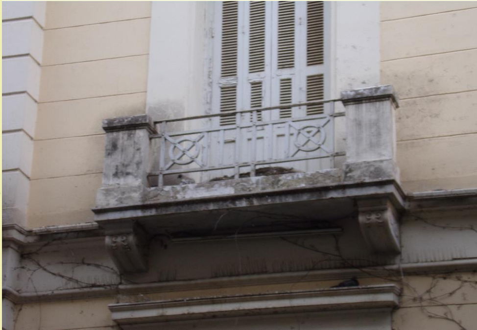
Εικόνα 56: Το δεξί άνοιγμα της προσόψεως και οι ενδείξεις υγρασίας περιμετρικά του εξώστη.
