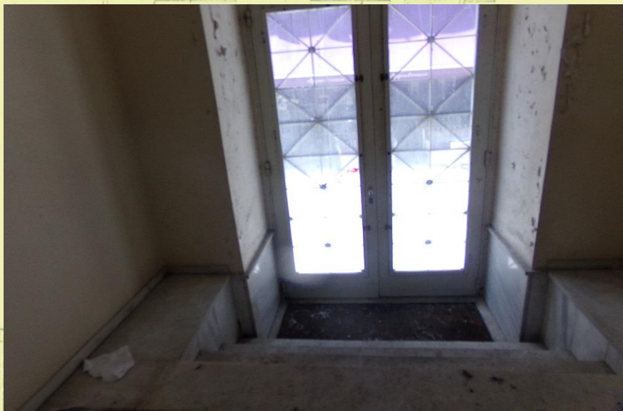
Εικόνα 2: Αποφλοίωση του χρώματος περιμετρικά του ανοίγματος της εισόδου.
