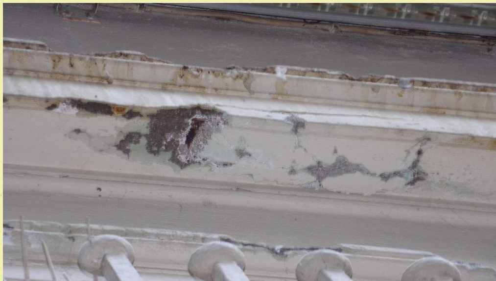
Εικόνα 52: Αποσάθρωση των γείσων.
