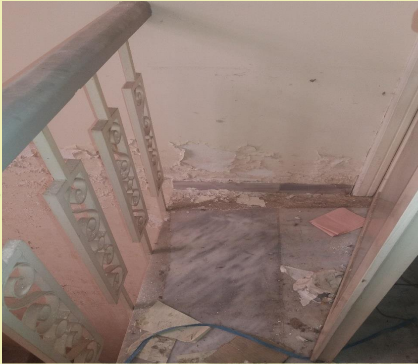
Εικόνα 38: Αποφλοίωση του χρωματισμού στην ένωση της πλάκας με την τοιχοποιία.
