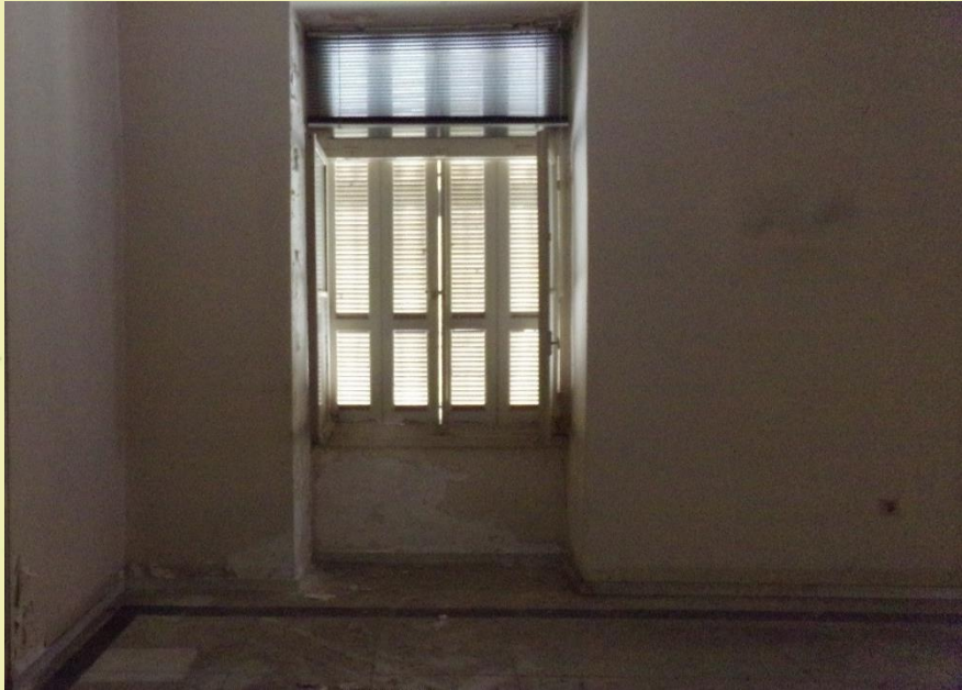
Εικόνα 15: Το νότιο άνοιγμα εδώ εμφανίζει αποσάθρωση του επιχρίσματος ενώ το ξύλινο κούφωμα έχει εξογκωθεί σε σημεία.
