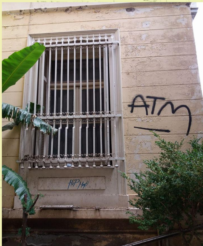
Εικόνα 61: Αποφλοίωση του χρώματος, κηλίδες μούχλας και τοπική κατάρρευση των γείσεων περιμετρικά του δεξιού παραθύρου στη βόρεια όψη.
