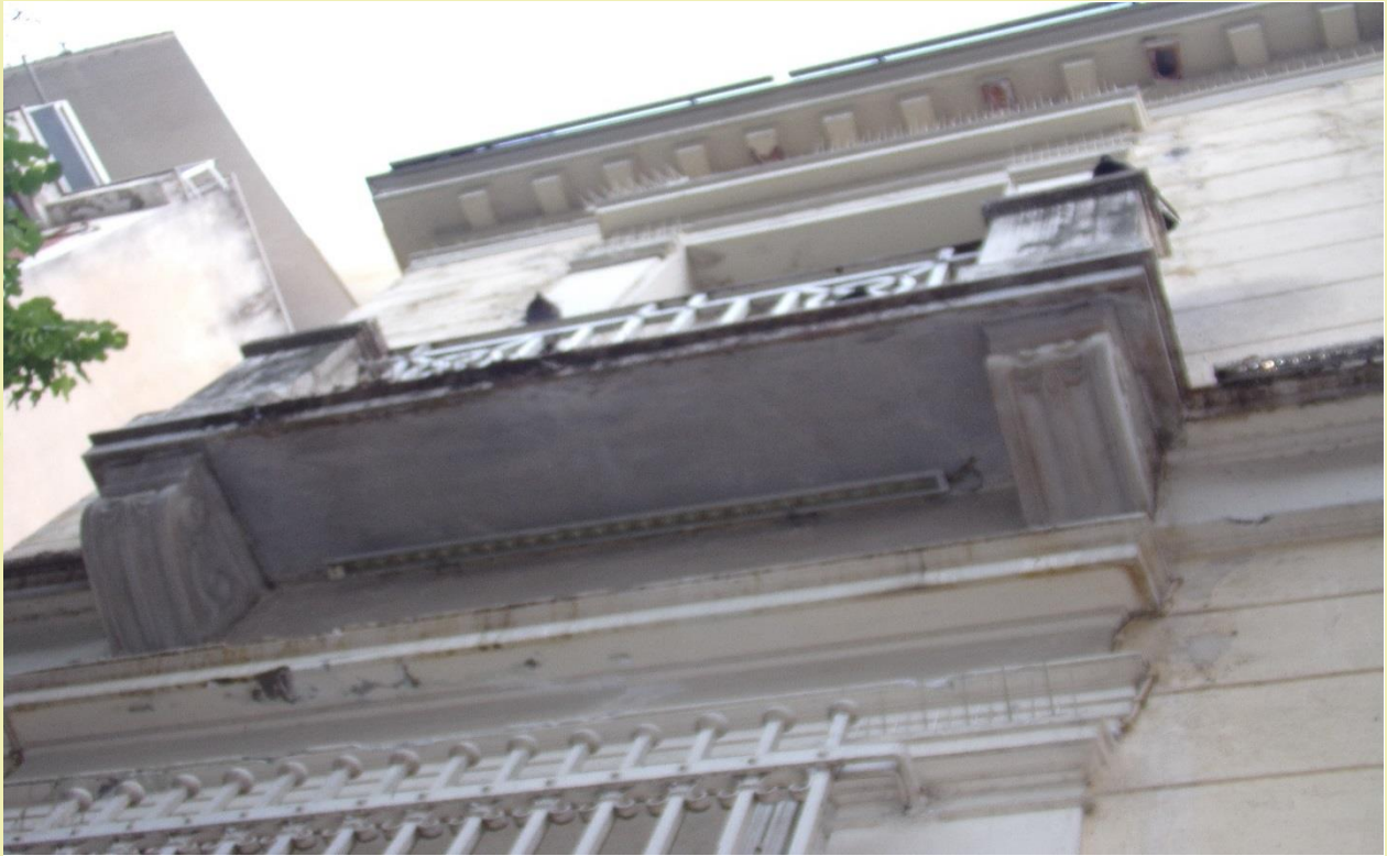
Εικόνα 48: Ο αριστερός εξώστης με εμφανή τα σημάδια της απόπλυσης των μαρμάρινων στοιχείων.
