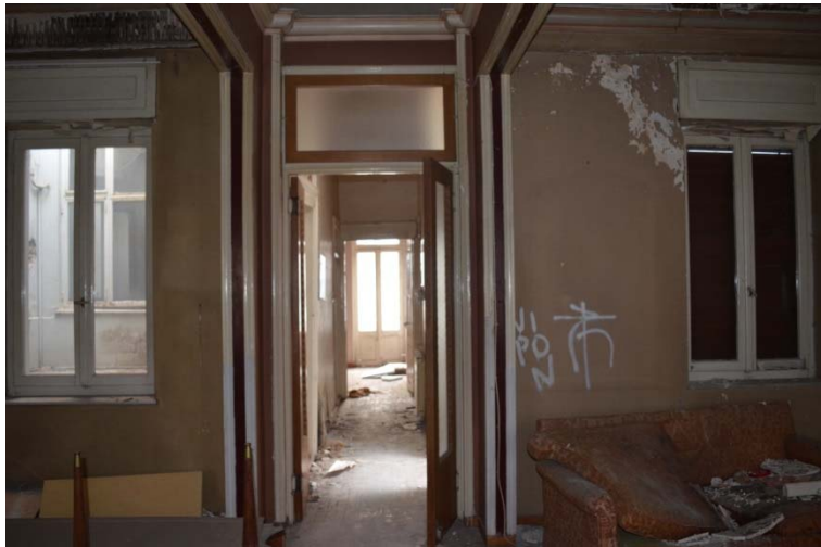
Άποψη διαδρόμου με εμφανείς φθορές
