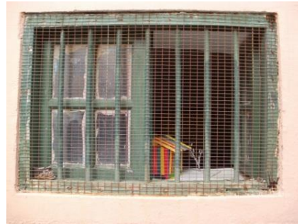
Εικόνα 34: Αποσάθρωση ξύλινου κουφώματος.
