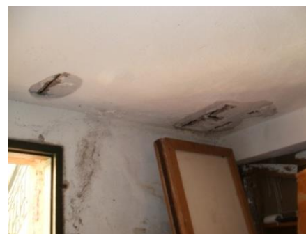
Εικόνα 13: Κατάρρευση επιχρίσματος, εμφάνιση οπλισμού.
