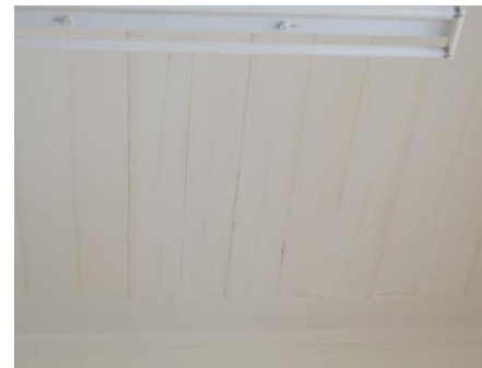
Εικόνα 29: ξύλινη οροφή με εμφανές ρωγμές
