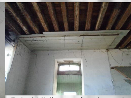
Εικόνα 86: Υπόλειμμα ψευδοροφής στο πρώτο επίπεδο
