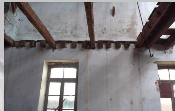
Εικόνα 62: Δολώθηκες ξύλινων δοκών
