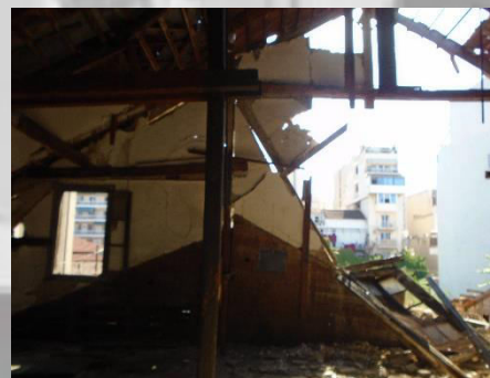
Εικόνα 5: Κατάρρευση τοιχοποιίας πίσω όψης δεύτερου επιπέδου
