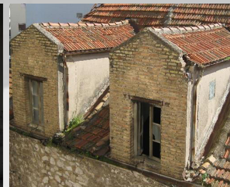
Εικόνα 4: Αποκόλληση κάθετων τοίχων σοφίτων
