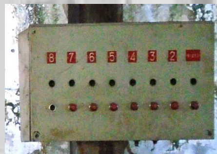
Εικόνα 101: Πίνακας στο πρώτο επίπεδο
