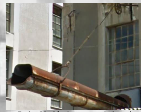
Εικόνα 27: Φθορές στον αγωγό εξαγωγής δεμάτων
