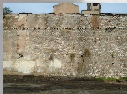
Εικόνα 57: Σφραγισμένα ανοίγματα στη μεσοτοιχία των κτηρίων 1 και 2
