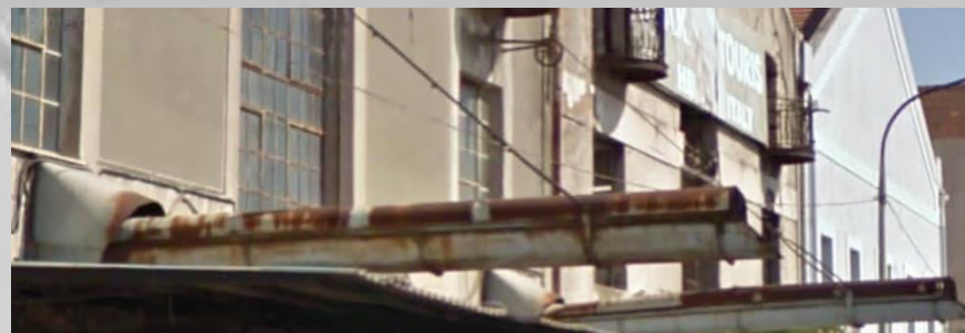
Εικόνα 91: Αγωγοί εξαγωγής δεμάτων πρόσοψης
