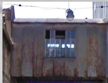
Εικόνα 24: Φθορές εξωτερικά της γέφυρας
