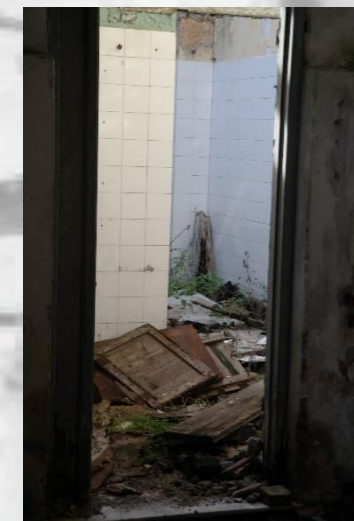
Εικόνα 6: Μερική κατάρρευση τοιχοποιίας λουτρών
