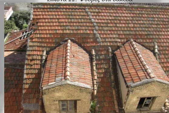
Εικόνα 23: Φθορές στη επικεράμωση
