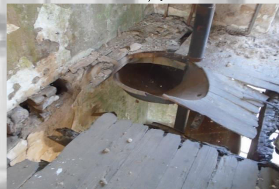
Εικόνα 22: Φθορές στα δάπεδα
