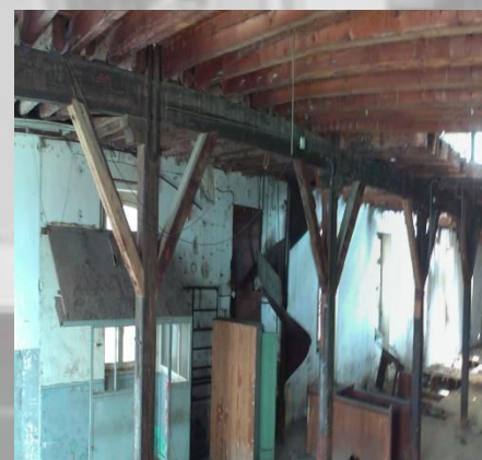
Εικόνα 9: Φθαρμένες ξύλινες δοκοί
