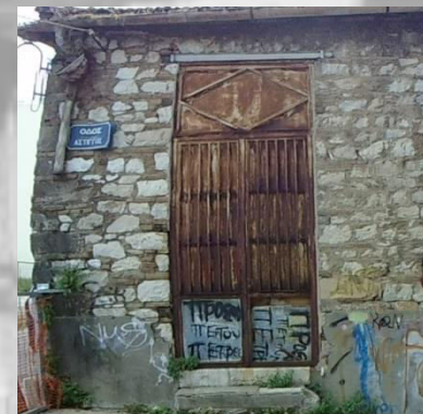
Εικόνα 32: Φθορές στα κουφώματα τα μεταλλικά
