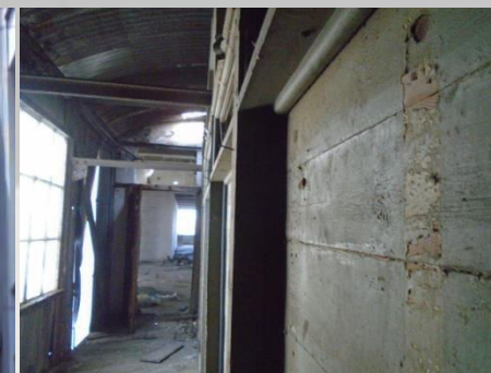
Εικόνα 25: Φθορές στο εσωτερικά της γέφυρας
