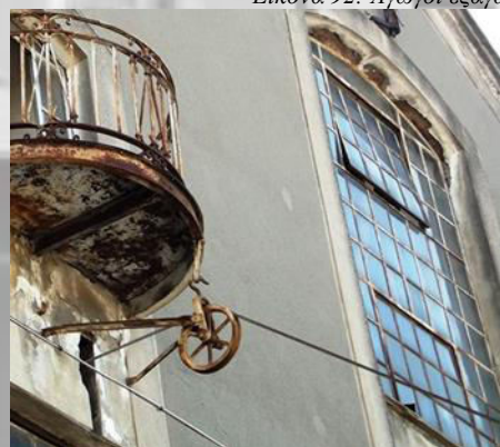
Εικόνα 93: Τροχαλία και συρματόσχοινο αγωγού εξαγωγής δεμάτων
