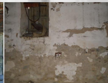
Εικόνα 18: Αποκολλήσεις και ρηγματώσεις στο επίχρισμα
