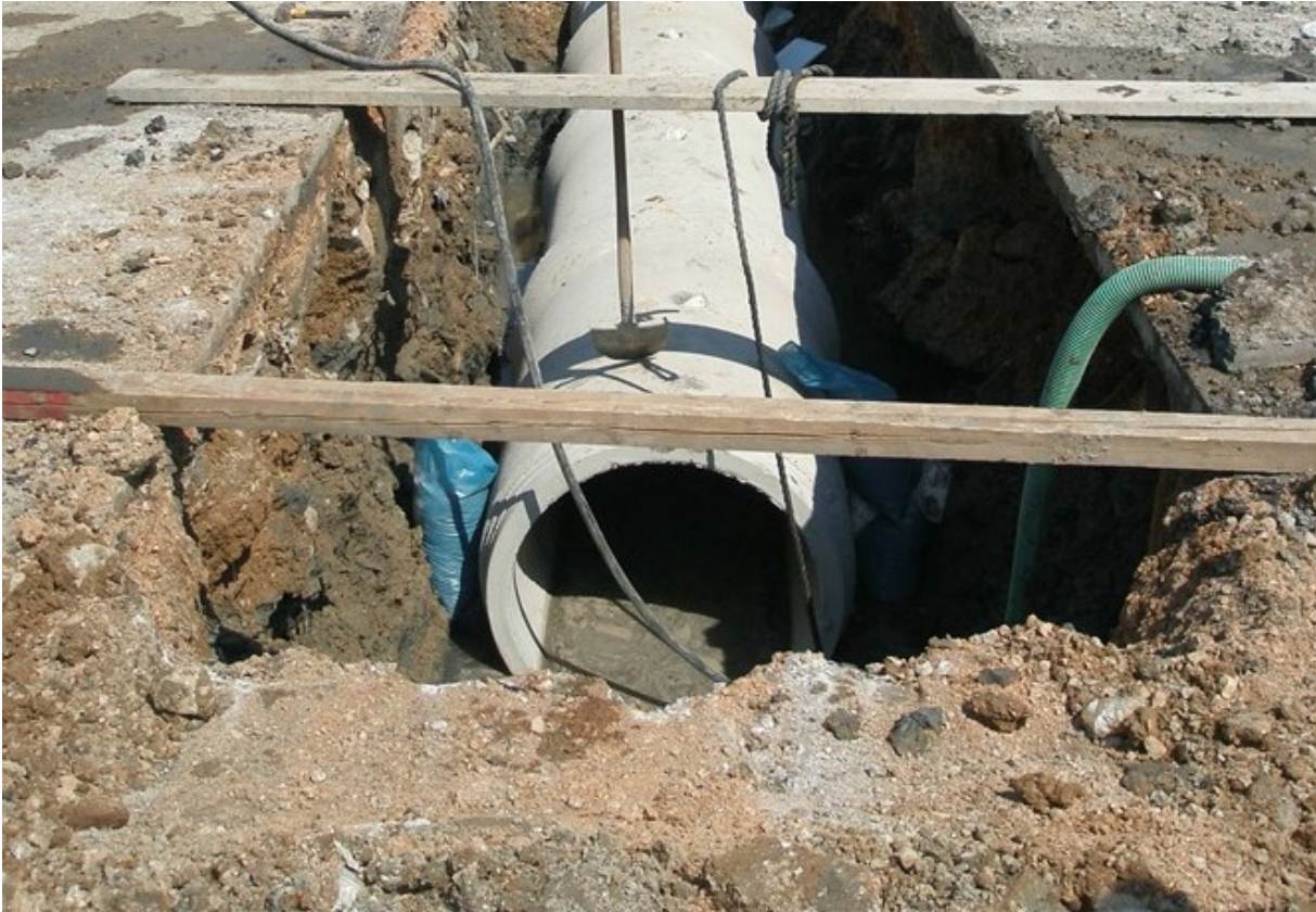
Εικόνα 1: Άποψη τμήματος δικτύου αποχέτευσης όμβριων στη φάση της κατασκευής. [Τροποποιημένη από: Διαδίκτυο 1]
