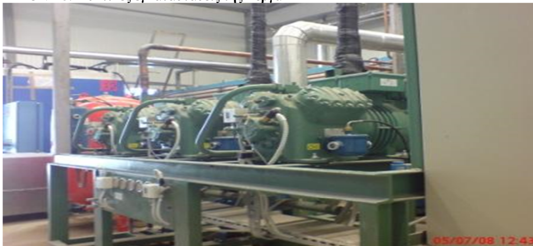
ΕΙΚΟΝΑ 8: Ψυκτικές εγκαταστάσεις της Σεργαλ
