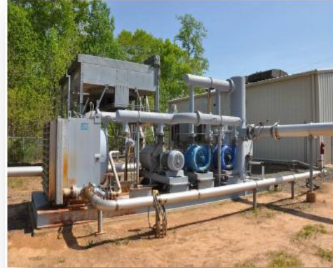
Εικόνα 4.8β: Κεντρικός σταθμός συλλογής και διανομής αερίου [68]
