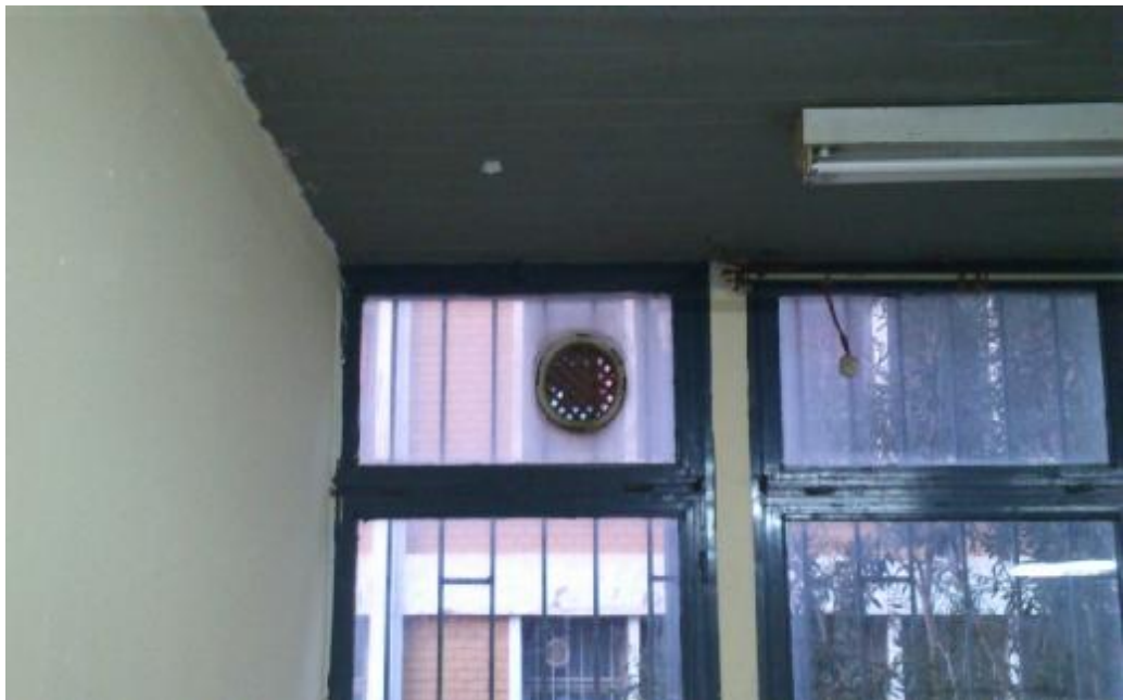
ΕΙΚΟΝΑ 3.5: ΑΛΛΟ ΑΝΟΙΓΜΑ ΑΕΡΑΓΩΓΟΥ ΣΕ ΠΑΡΑΘΥΡΟ ΑΙΘΟΥΣΑΣ ΣΤΟ ΙΣΟΓΕΙΟ ΤΟΥ ΚΤΙΡΙΟΥ Ζ
