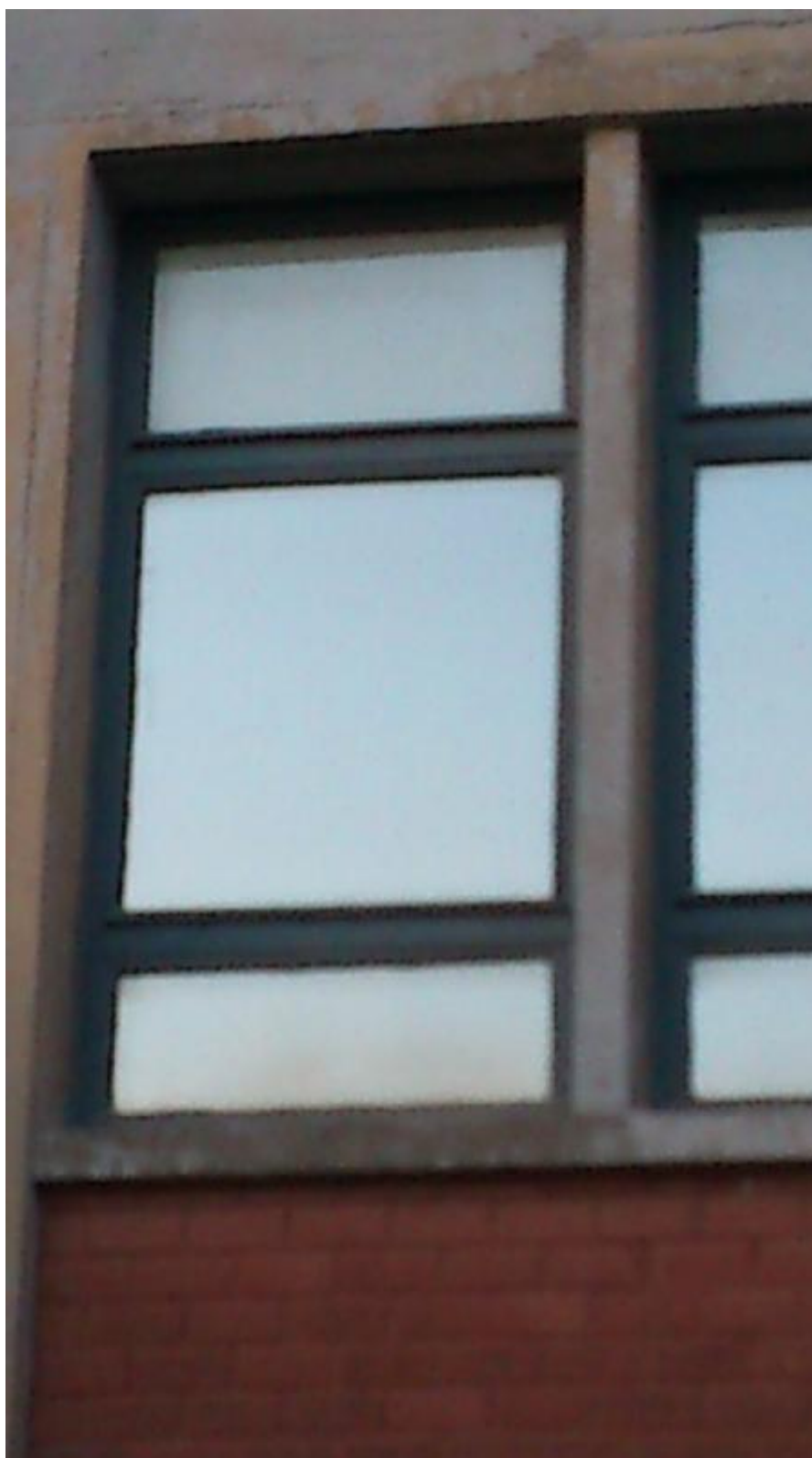
ΕΙΚΟΝΑ 1.4: ΠΑΡΑΘΥΡΟ ΝΟΤΙΑΣ ΠΛΕΥΡΑΣ ΚΤΙΡΙΟΥ Ζ
