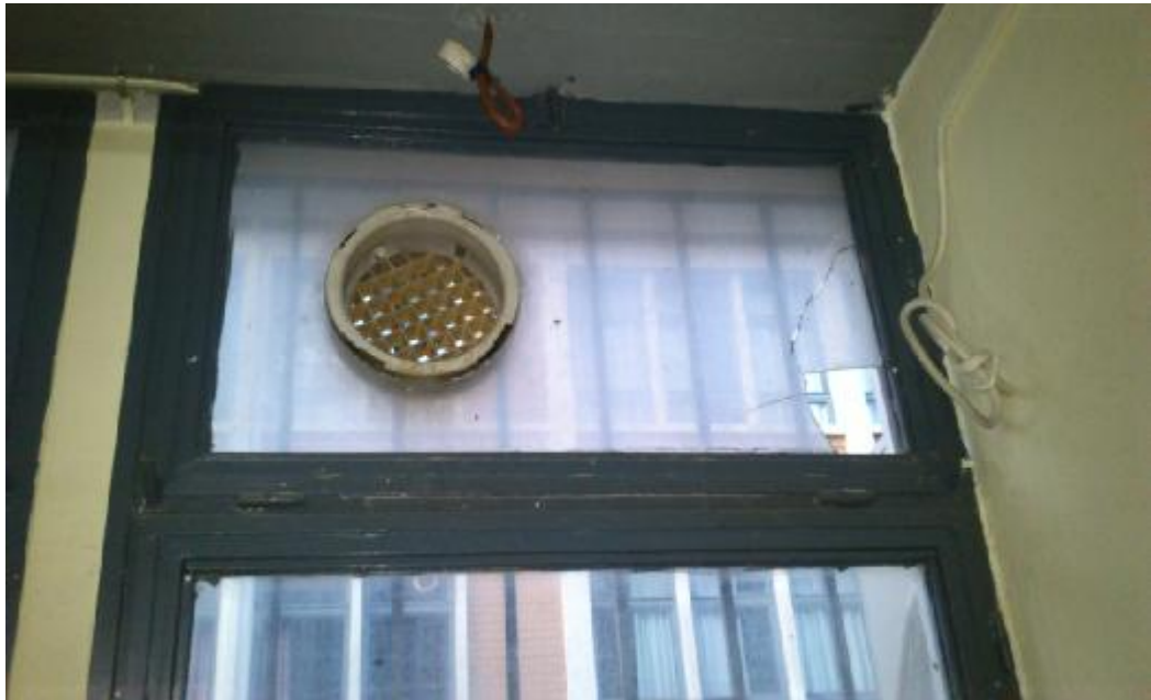
ΕΙΚΟΝΑ 3.6: ΝΕΟ ΑΝΟΙΓΜΑ ΑΕΡΑΓΩΓΟΥ ΣΕ ΠΑΡΑΘΥΡΟ ΑΙΘΟΥΣΑΣ ΣΤΟ ΙΣΟΓΕΙΟ ΤΟΥ ΚΤΙΡΙΟΥ Ζ
