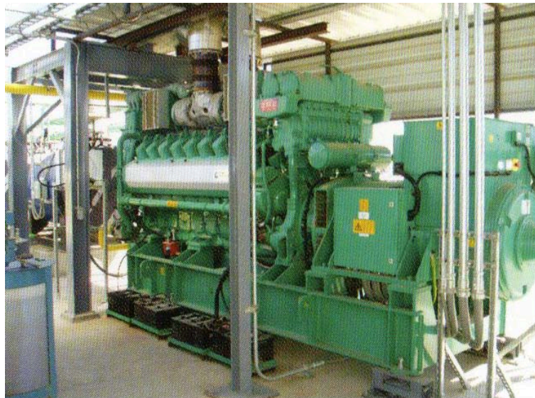
Μονάδα συμπαραγωγής θερμικής και ηλεκτρικής ενέργειας
