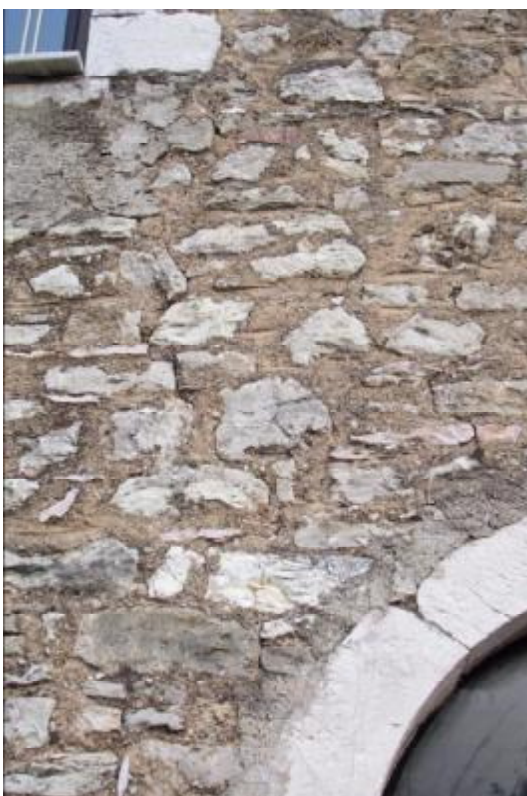
Εικόνα 26 Ρωγμές στα υπέρθυρα
