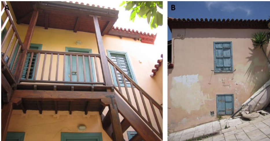
Εικόνα 61. Α. Το ανοιχτό ξύλινο χαγιάτι του κτηρίου Β. Το ισόγειο του κτηρίου Β είναι χτισμένο, κατά το ήμισυ, κάτω από την επιφάνεια της γης.
