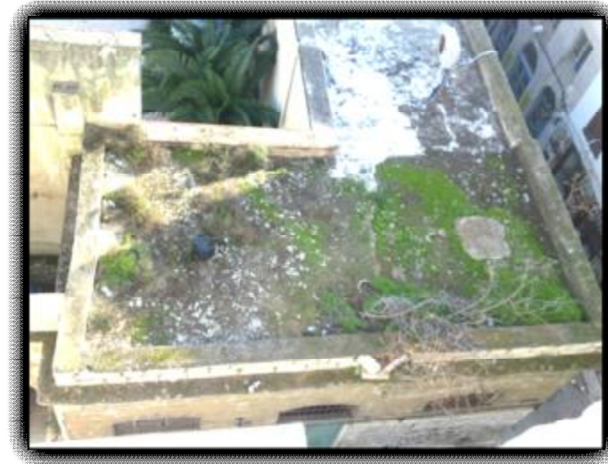
Εικόνα 27: Εμφάνιση μικροχλωρίδας στο δώμα του κτιρίου.
