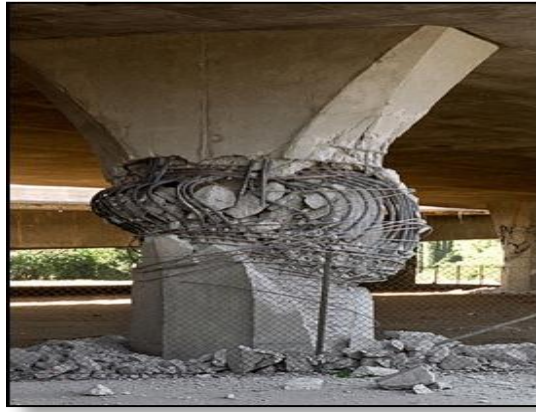
Εικόνα 31: Αστοχία χαλύβδινων βεργών και συνεπώς, του σκυροδέματος
