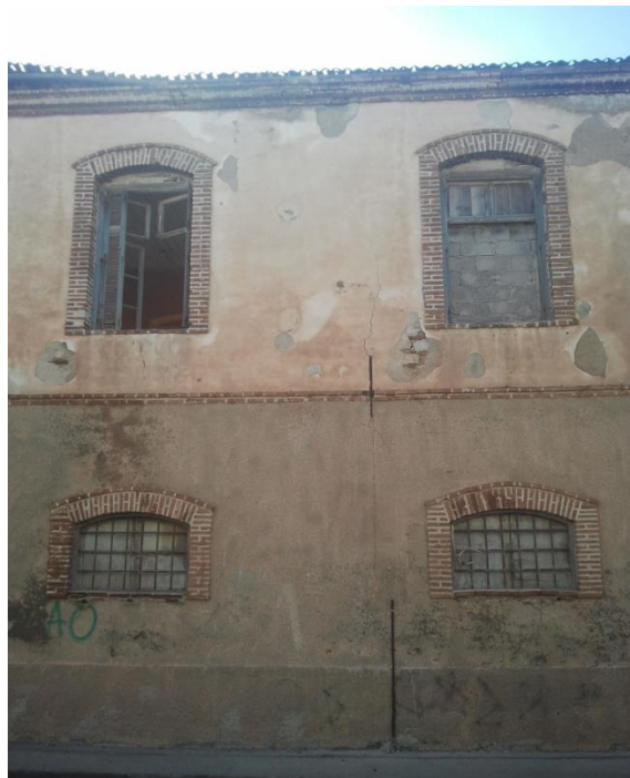
Εικόνα 108: Κλειστά ανοίγματα που σώζονται μόνο τα ξύλινα πλαίσια και οι προστατευτικές σιδεριές, αποκόλληση επιχρίσματος, υγρασία και αλλοίωση χρωματισμών εμφανίζονται στην όψη.
