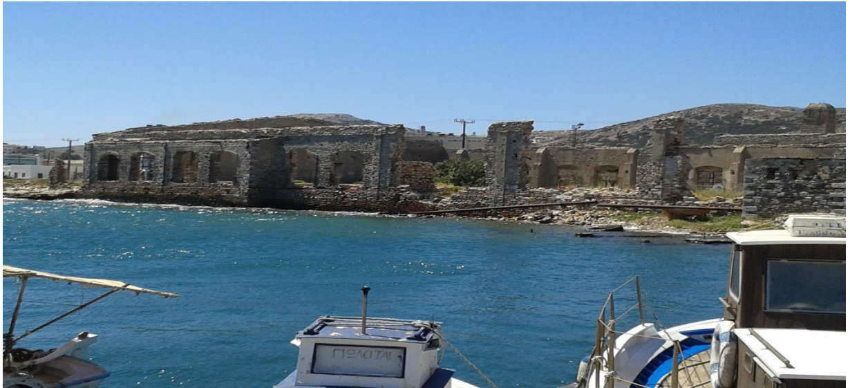
Εικόνα 68: Γενική άποψη της όψης επί της θάλασσας. Δίλοβα ανοίγματα με πλαίσια από τούβλα. Τμήματος τους έχει καταρρεύσει, καθώς και τμήμα του τοίχου επί της θάλασσας.
