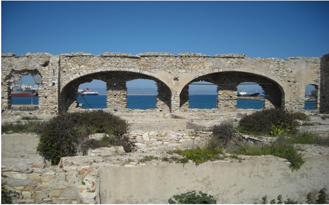
Εικόνα 95: Εμφανή η ημιλαξευτή λιθοδομή. Ίχνη επιχρίσματος που έχει αποκολληθεί.
