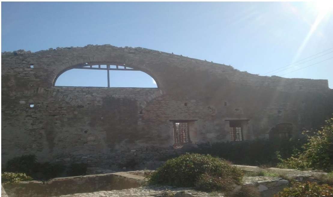
Εικόνα 76: Γενική άποψη πλευράς διαχωριστικού τοίχου. Επιχρισμένος, όμως τμήμα του επιχρίσματος έχει αποκολληθεί και είναι ορατή η λιθοδομή του.
