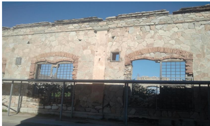
Εικόνα 57: Αποκοπή τμητός Πάο της σιδεριές. Επιχρισμένες προστατευτικές παραστάδες με επίκρανα εμφανίζονται ανά 10μ. στην όψη με αλλοίωση στον χρωματισμό τους.
