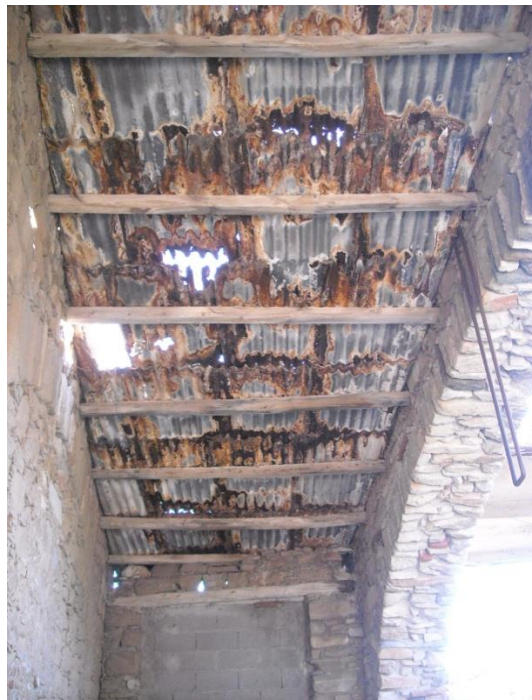
Εικόνα 134: Στέγη από πρόχειρη κατασκευή.
