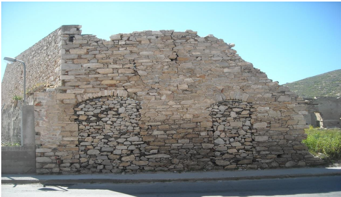
Εικόνα 112: Κλειστά ανοίγματα με τοξωτό υπέρθυρο από πέτρα στην ανατολική πλευρά του συγκροτήματος. Κατάρρευση τοιχοποιίας στο άνω μέρος και στο δυτικό κομμάτι.
