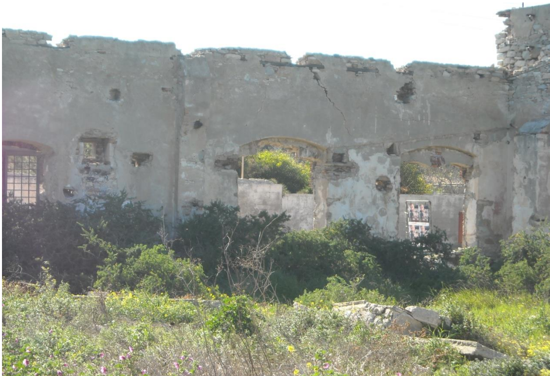
Εικόνα 90: Αποκόλληση επιχρίσματος , ρωγμές και αλλοίωση χρωματισμών.
