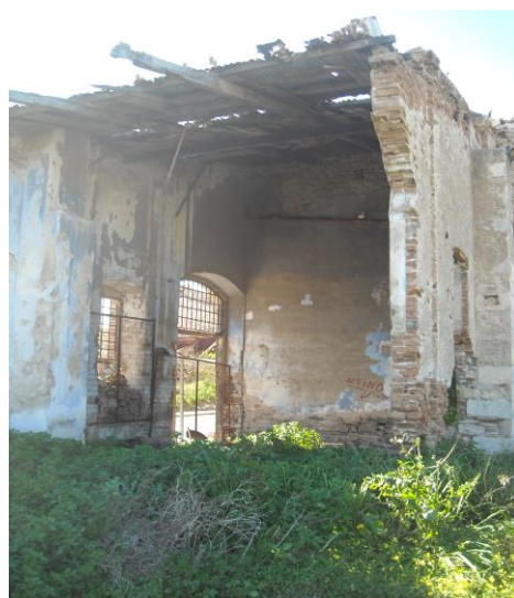
Εικόνα 8: Στέγη από ελενίτ στο διαχωριστικό τοίχο.
