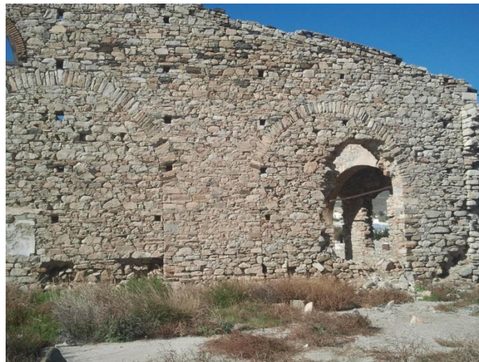
Εικόνα 74: Κατάρρευση τμήματος από κλειστή καμάρας. Τοιχοποιία από λίθους σε άτακτη τοποθέτηση.
