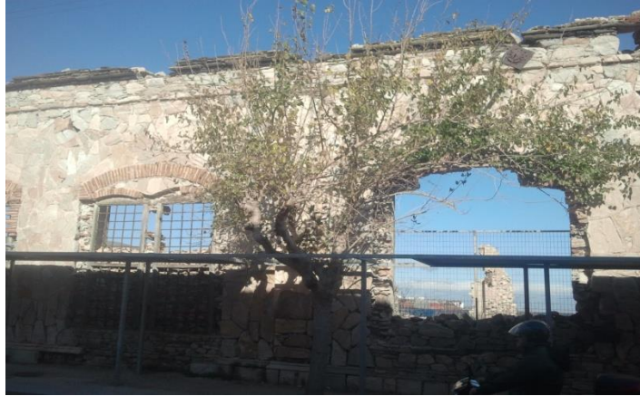
Εικόνα 56: Κατάρρευση του πλαισίου και των προστατευτικών σιδεριών στο δίλοβο άνοιγμα.
