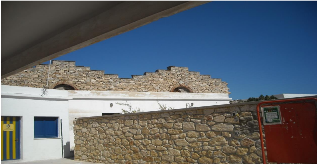
Εικόνα 117: Δυο τριγωνικά αετώματα με στρόγγυλα παράθυρα με πλαίσια από τούβλα. Λίθινη τοιχοποιία με εμφανή την ημιλαξευτή λιθοδομή τους.
