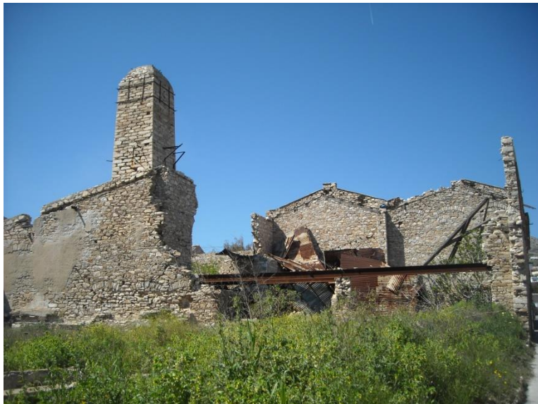
Εικόνα 17: Κατέρρευση στέγης και πατώματος.
