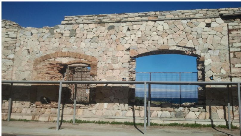
Εικόνα 50: Αποκόλληση τμήματος του πλαισίου από τούβλα στα ανοίγματα. Κλειστό το ένα άνοιγμα και κατάρρευση λιθοδομής στο άνω διάζωμα του τοίχου.
