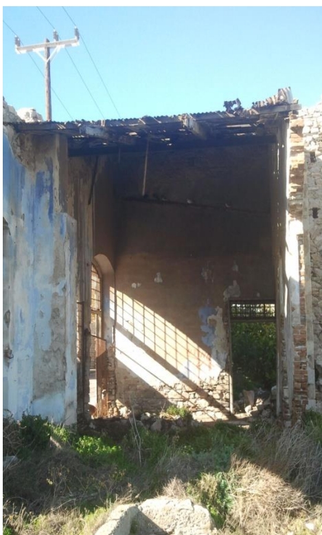
Εικόνα 71: Μεταγενέστερη μεταλλική κατασκευή. Στέγαση από ελενίτ πάνω σε μεταλλικά δοκάρια. Στον τοίχο παρατηρείται αποσάθρωση. Αποκόλληση τμήματος επιχρίσματος και αλλοίωση χρωματισμού.
