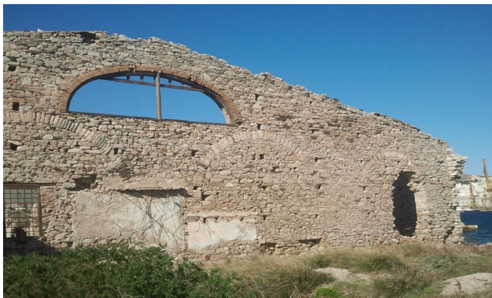
Εικόνα 72: Τριγωνικό αέτωμα που σ αυτό δημιουργείται ανακουφιστικό άνοιγμα ελλειπτικής μορφής. Κλειστές καμάρες και ίχνη μεταγενέστερης κατασκευής παρατηρούνται σ αυτό τον τοίχο.
