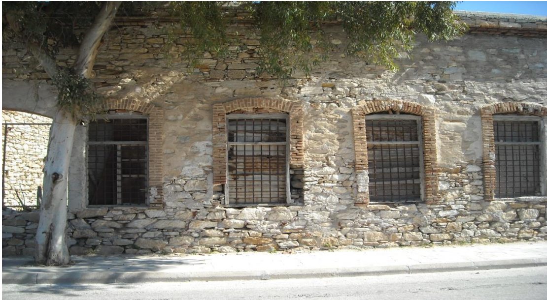
Εικόνα 123: Κλειστά τοξωτά ανοίγματα με πλαίσιο από τούβλα και προστατευτικές σιδεριές που έχουν οξειδωθεί. Τμήμα τους έχει αποκολληθεί .
