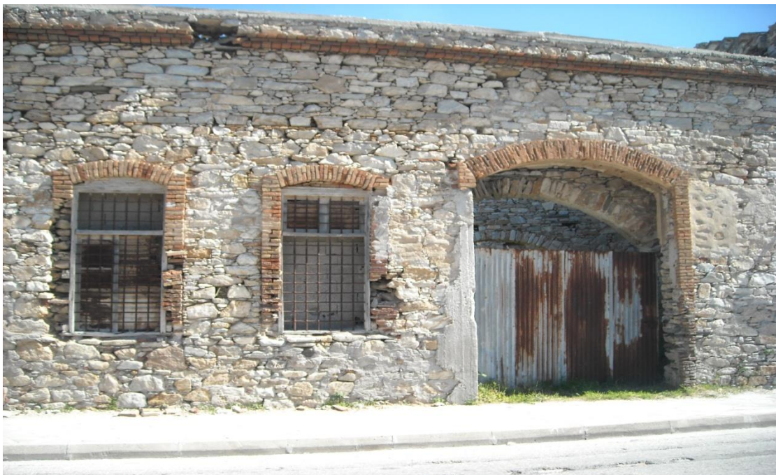
Εικόνα 124: Τοξωτά ανοίγματα με πλαίσιο από τούβλα και προστατευτικές σιδεριές. Τμήμα τους έχει αποκολληθεί. Δευτερεύον είσοδος κλειστή με ελενίτ που έχει οξειδωθεί.
