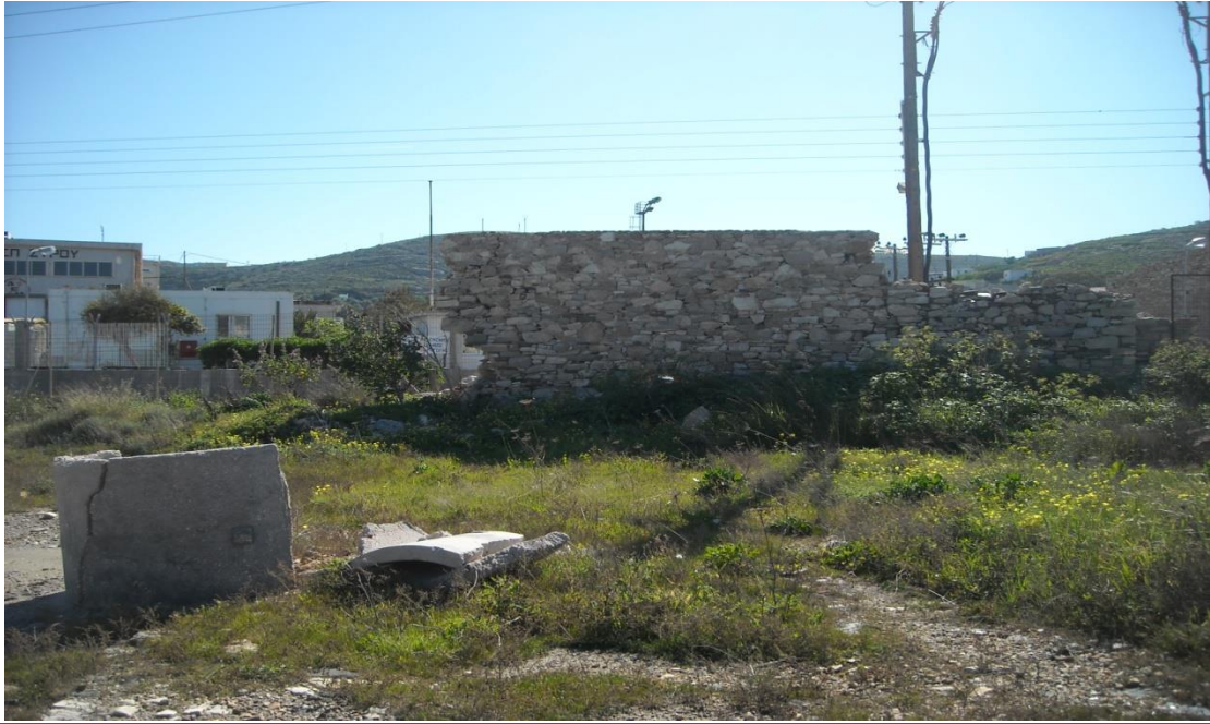
Εικόνα 79: Υπόλειμμα τοίχου νότιας όψης παραθαλάσσιου κτίσματος.
