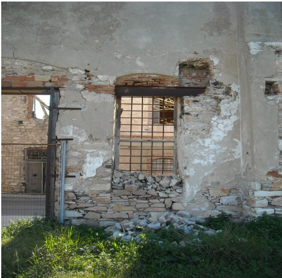
Εικόνα 21: Φθορά εσωτερικής τοιχοποιίας
