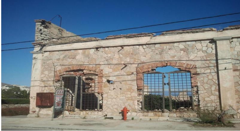
Εικόνα 61: Αποκόλληση των πλαισίων από τα τούβλα στα δίλοβα ανοίγματα. Τριχοειδής ρωγμή στο άνω διάζωμα του τοίχου. Αποκόλληση επιχρίσματος και αλλοίωση των χρωματισμών στην παραστάδα.
