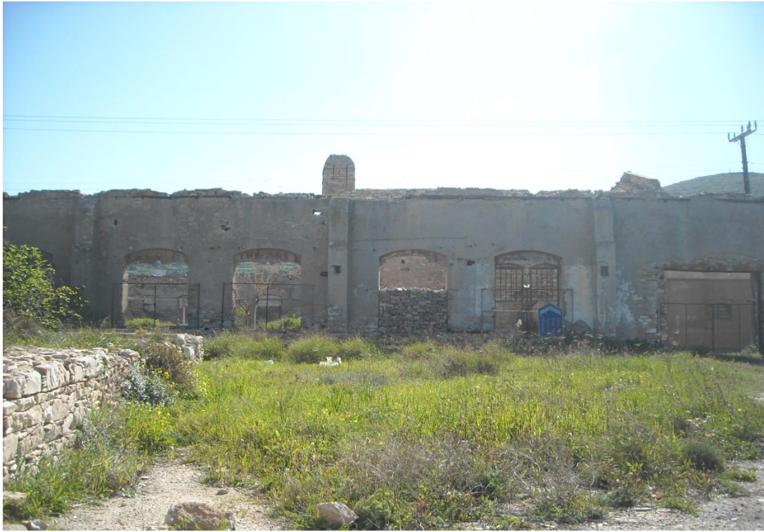
Εικόνα 83: Νότια όψη, επιχρισμένη. Αποκόλληση επιχρίσματος και αλλοίωση χρωματισμών.
