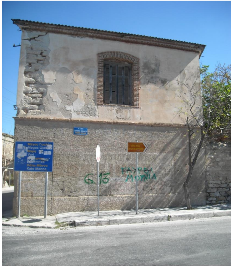
Εικόνα 119: Η μικρή πλευρά του κτίσματος των χώρων διοίκησης. Επιχρισμένη, αλλά τμήμα του επιχρίσματος έχει αποκολληθεί και φαίνεται η λιθοδομή. Διαμπερή ρωγή εμφανίζεται στο άνω τμήμα, καθώς και υγρασία και αλλοίωση των χρωματισμών .
