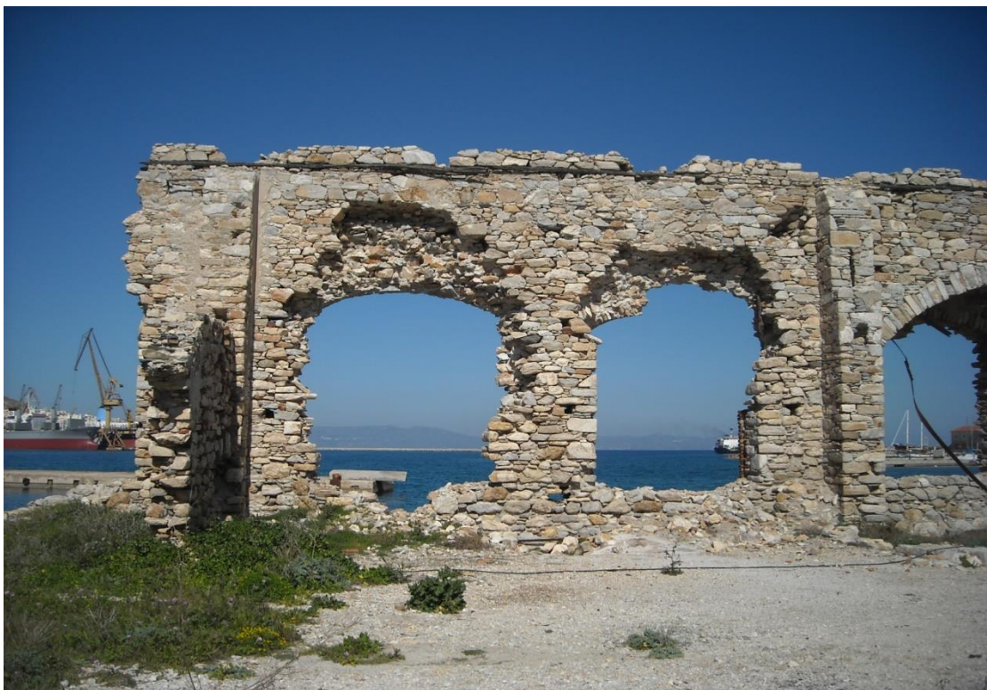
Εικόνα 96: Δίλοβα ανοίγματα. Αποκόλληση λιθοδομής.
