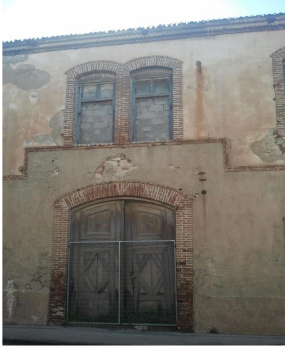
Εικόνα 107: Σαθρά κουφώματα. Διακοσμητική ταινία στο μέσο του κτίσματος δημιουργεί ένα σπάσιμο πάνω από την πόρτα. Κλειστά ανοίγματα . αποκόλληση επιχρίσματος, αλλοίωση χρωματισμών και υγρασία παρατηρούνται στην όψη.
