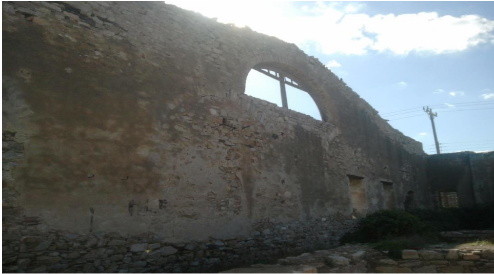
Εικόνα 75: Γενική άποψη του τοίχου. Ύπαρξη επιχρίσματος σε μεγάλο τμήμα του, όμως σε σημεία του έχει αποκολληθεί.
