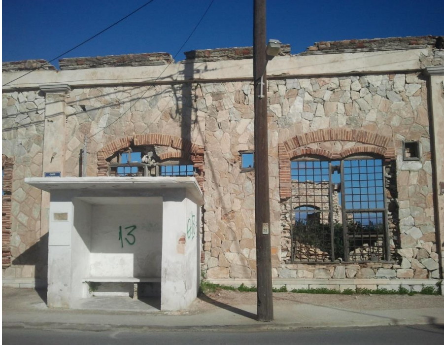
Εικόνα 59: Δίλοβα ανοίγματα με πτώση των πλαισίων τους. Αποκόλληση τμήματος του γείσου.
