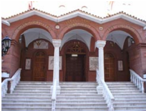
Ι.Ν. Μεταμορφώσεως και Γεννήσεως του Σωτήρος (1986), Θεσσαλονίκη. Οι εξωτερικές πόρτες ανοίγουν προς τα μέσα (!) The temple of the Transfiguration and Nativity of the Saviour (1986), Thessaloniki. The doors open inwards (!) Πηγή: Αρχείο συγγραφέων / Source: Authors' Archive
