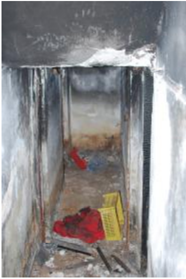
Εικόνα 43: Ο Διάδρομος για το Λεβητοστάσιο
