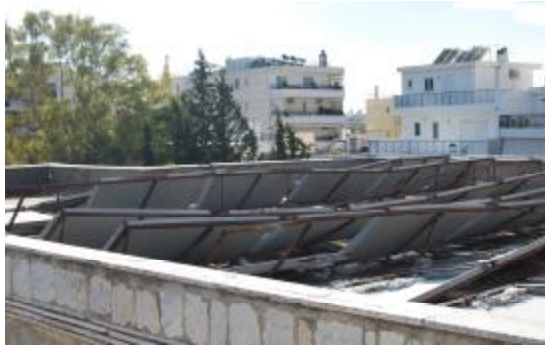
Εικόνα 28: Τα Μεταλλικά Αντικείμενα στο Δώμα
