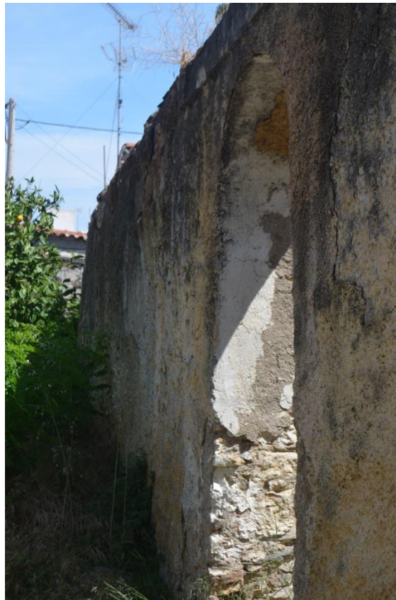
Γ.1 εικ.5 Όψη κτηρίου Γ αποσαθρωμένη τοιχοποιία και με σημάδια υγρασίας
