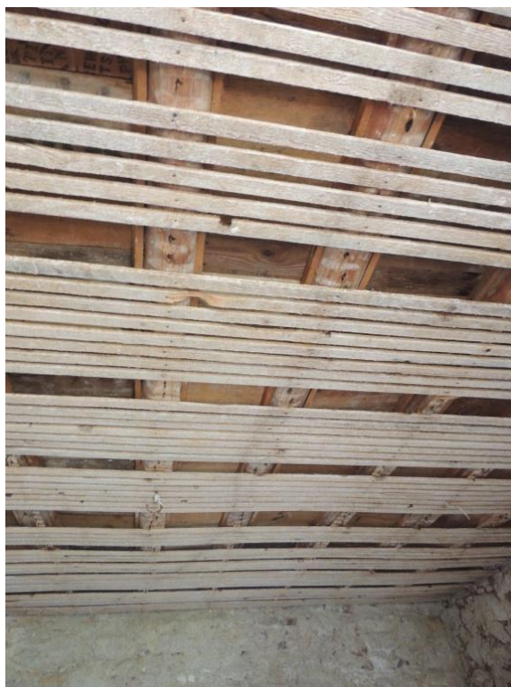
Α.2 εικ.1: Η ψευδοροφή στο δωμάτιο του ισόγειου. Καθαίρεση ξύλινου μαγαδάτι σε κάποια σημεία.
