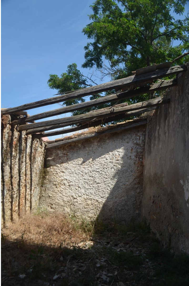
Κτι.Γ εικ.3: Τα απομεινάρια της μονόριχτης στέγης στο δωμάτιο των υποτακτικών στο κτίριο Γ.
