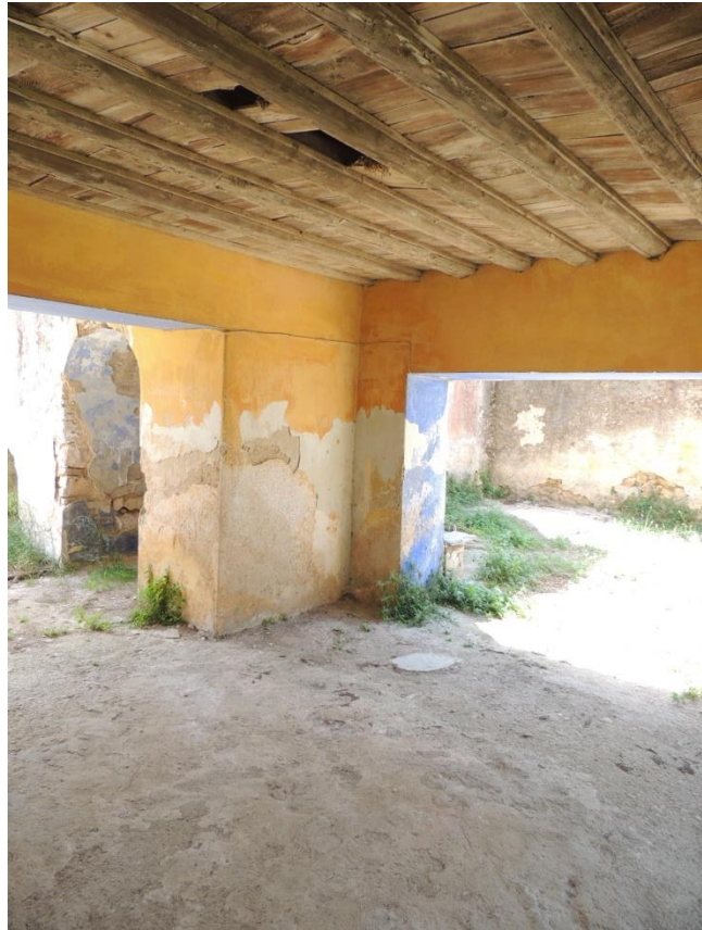
Α.3 εικ.26 Κατεστραμμένο πατητό δάπεδο και αποσάθρωση επιχρίματος
