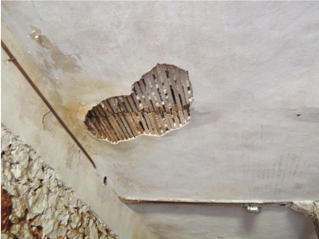
Β.1 εικ.7: Η ψευδοροφή του ημιυπόγειου. Έχουμε καθαίρεση επιχρίσματος και εμφάνιση ξύλινου μπαγδάτι.
