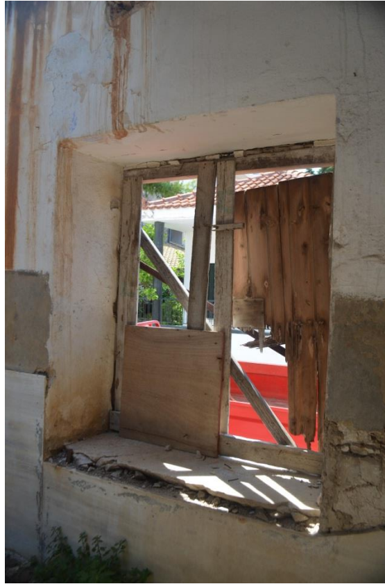
Γ.1 εικ.12 Κατεστραμμένο και σαπισμένο κούφωμα
