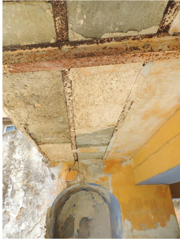
Α.3 εικ.13 Αποσάθρωση επιχρίσματος στην οροφή
