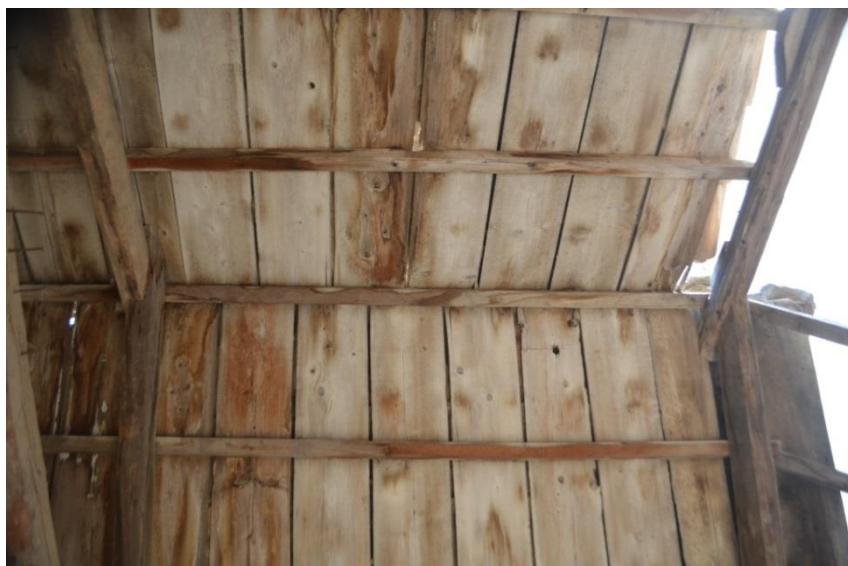
Γ.1 εικ.16 Άνοψη στέγης με έντονες τις φθορές από την εισχώρηση νερού
