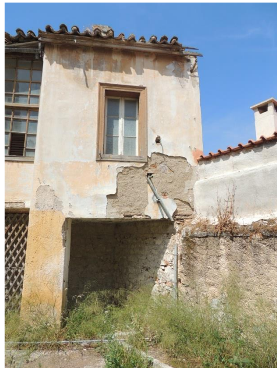
Α.1 εικ.24 Έντονη αποσάθρωση επιχρίσματος στην όψη
