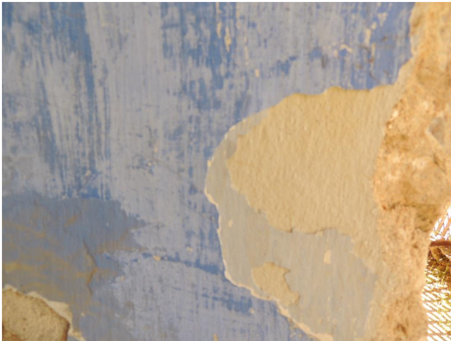
Α.3 εικ.23 Αποσάθρωση επιχρίσματος και χρώματος, εμφανή οι στρώσεις των επιχρισμάτων και των χρωμάτων
