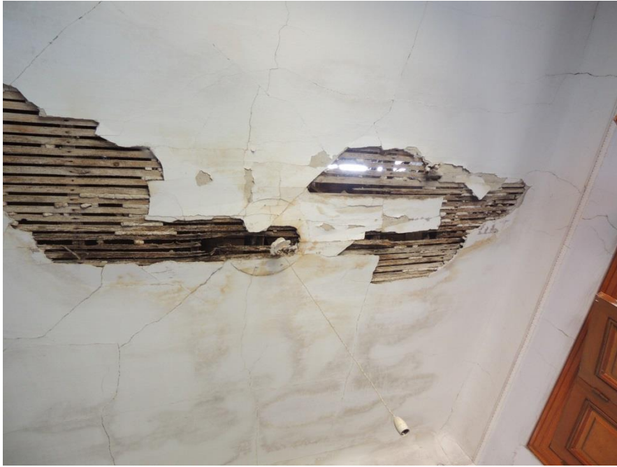
Α.3 εικ.36 Αποσάθρωση επιχρίσματος απ την ψευδοροφή και εμφάνιση ξύλινου μπαγδάτι
