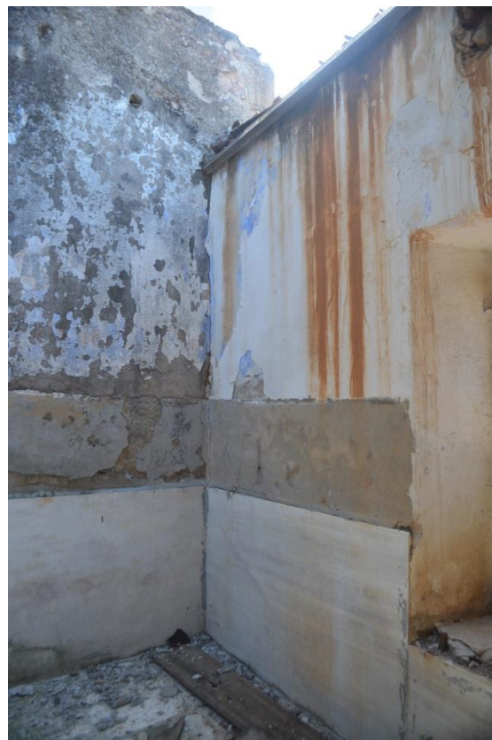
Γ.1 εικ.13 Έντονα σημάδια υγρασίας στην τοιχοποιία
