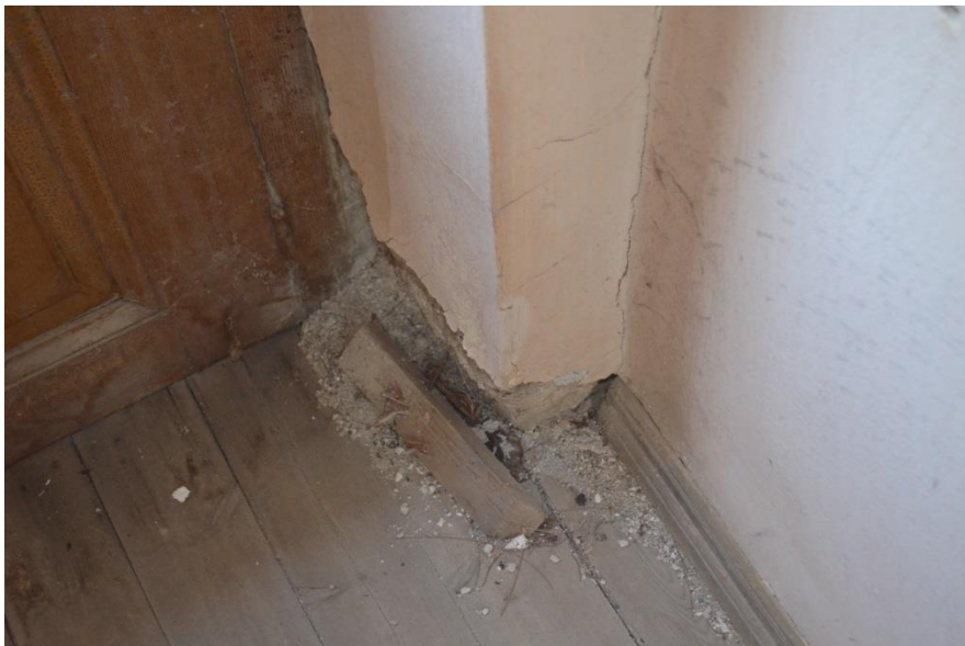
Α.4 εικ.6 Αποσάθρωση επιχρίσματος
