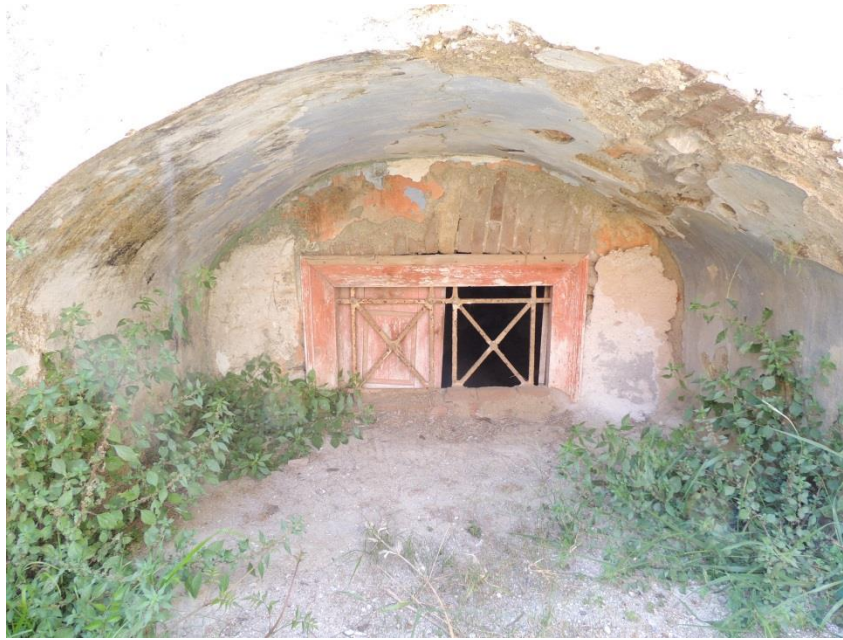
Β.2 εικ.22 Φεγγίτης ημιπλόγειου και τοιχοποιία αποσαθρωμένη από επίχρισμα και
