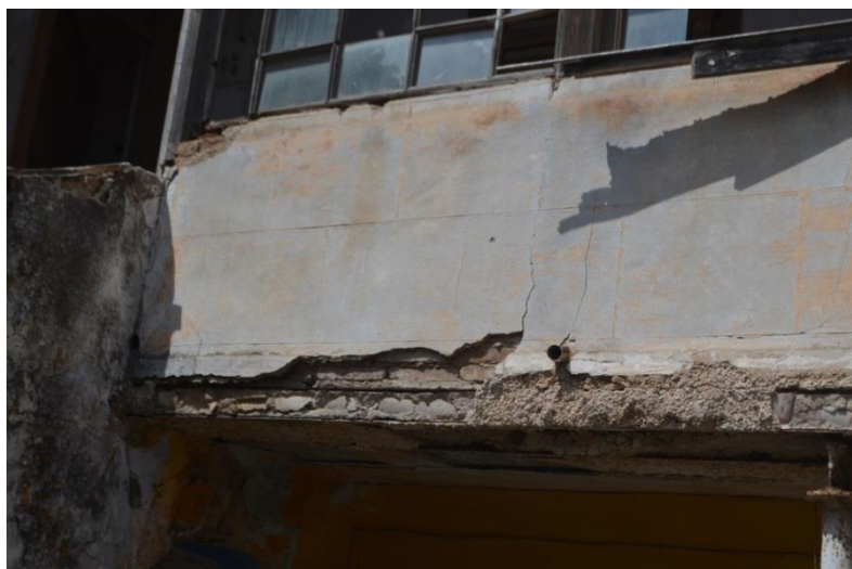
Α.1 εικ.9 Εξωτερική τοιχοποιία λιακτού. Αποσάθρωση επιχρίσματος.
