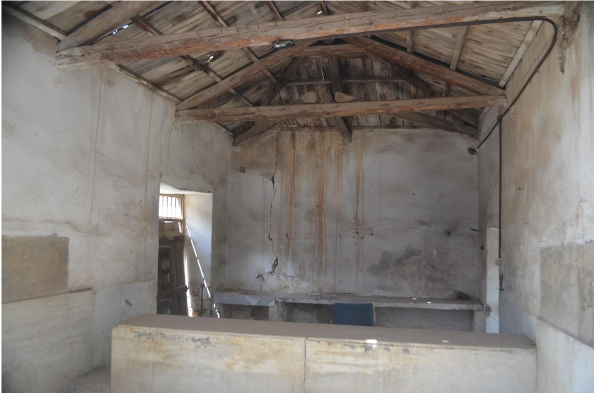
Γ.1 εικ.10: Το πατητήρι του κτιρίου Γ. Στον τοίχο στο βάθος φαίνεται η μεγάλη ρωγμή όπου έχει δημιουργηθεί από μηχανολογικούς παράγοντες.
