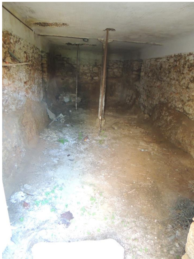
Β.1 εικ.3 Υπόγειο με καταστραμμένο δάπεδο και ξεγυμνωμένη τοιχοποιία
