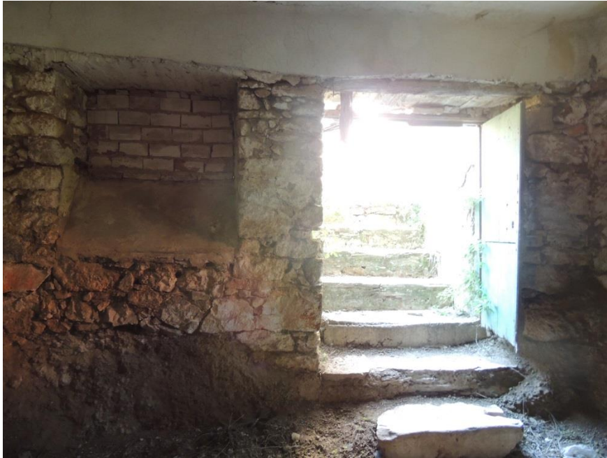
Β.1 εικ.10 Κλίμακα με έντονες φθορές και αποσαθρωμένη τοιχοποιία
