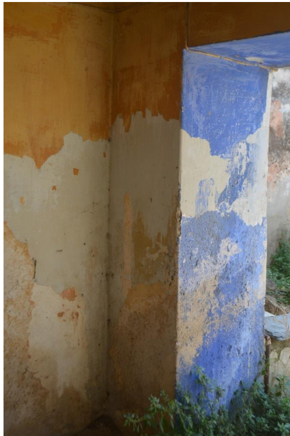
Α.3 εικ.7 Αποσάθρωση επιχρίσματος και χρώματος
