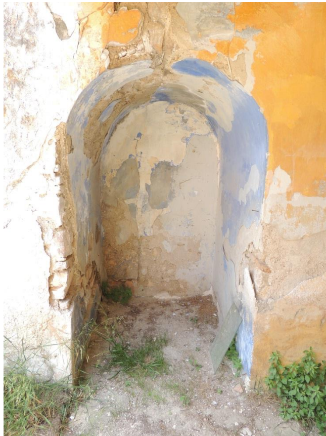
Α.3 εικ.12 Εσωχή στο κτίριο Α με αποσάθρωση επιχρίσματος
