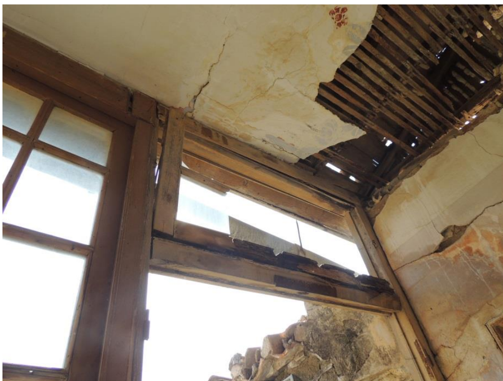
Α.4 εικ.10: Λεπτομέρεια απ το λιακωτό στον όροφο του κτιρίου Α. Βλέπουμε σπασμένα τζαμιλίκια, αποσάθρωση επιχρισμάτων, εμφάνιση υγρασίας και προσβολή των ξύλων του λιακωτού από μικροοργανισμούς (σάπισμα).
