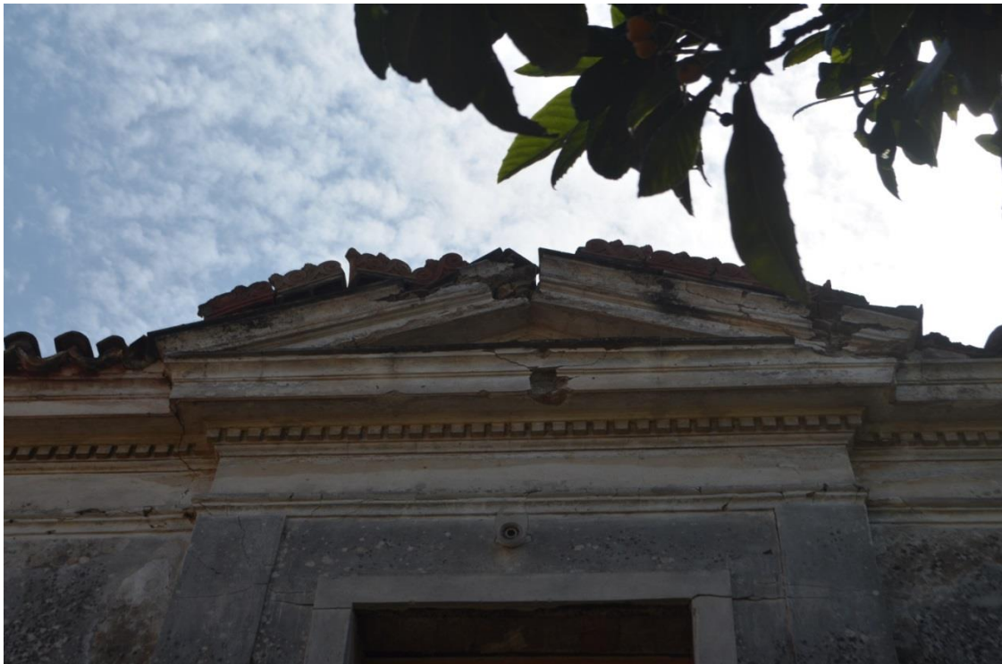
Α.1 εικ.3: Κομμάτι απ την πρόσοψη του κτιρίου Α. Φαίνεται, η φθορά των διακοσμητικών στοιχείων, αετώματα, ζωφόρος κτλ.
