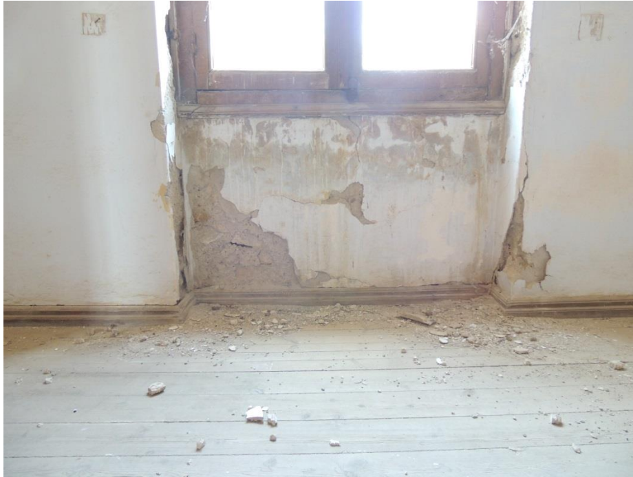
Α.4 εικ.41 Αποσάθρωση επιχρίσματος
