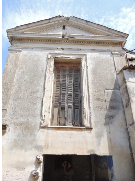
Α.1 εικ.30 Δυτική όψη με εμφανή έλλειψη εξώστη
