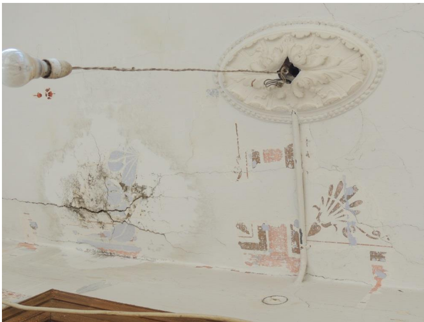
Α.4 εικ.17 Διακοσμητικός διάκοσμος και σκάσιμο επιχρίσματος ψευδοροφής
