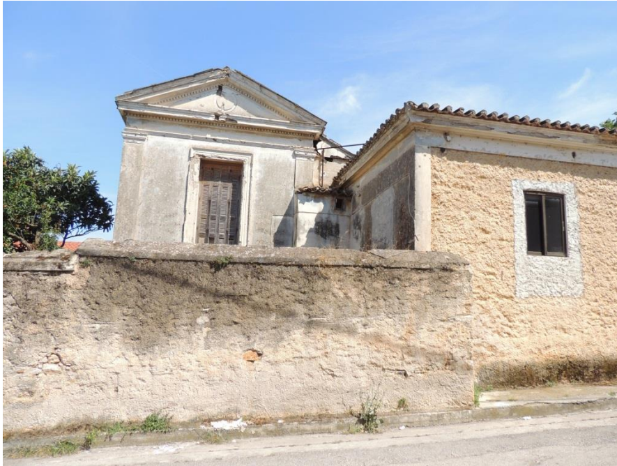
Α.1. εικ.29 Στο βάθος φαίνεται η όψη του κτηρίου Α και μπροστά ο μαντρότοιχος που έχει εμφανή σημάδια υγρασίας
