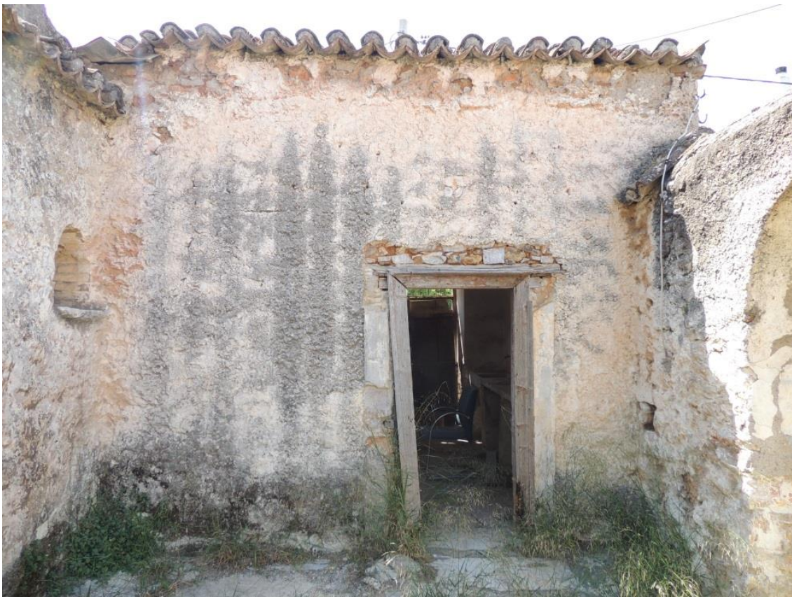
Γ.1 εικ.38: Εσωτερική όψη του κτιρίου Γ. Έντονη είναι η εμφάνιση της υγρασίας και η καταστροφή του ξύλινου κουφώματος, κυρίως έχει σκεβρώσει.
