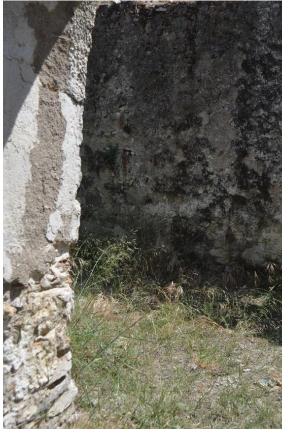
Γ.1 εικ.7 Εμφάνιση υγρασίας και αποσάθρωσης τοιχοποιίας
