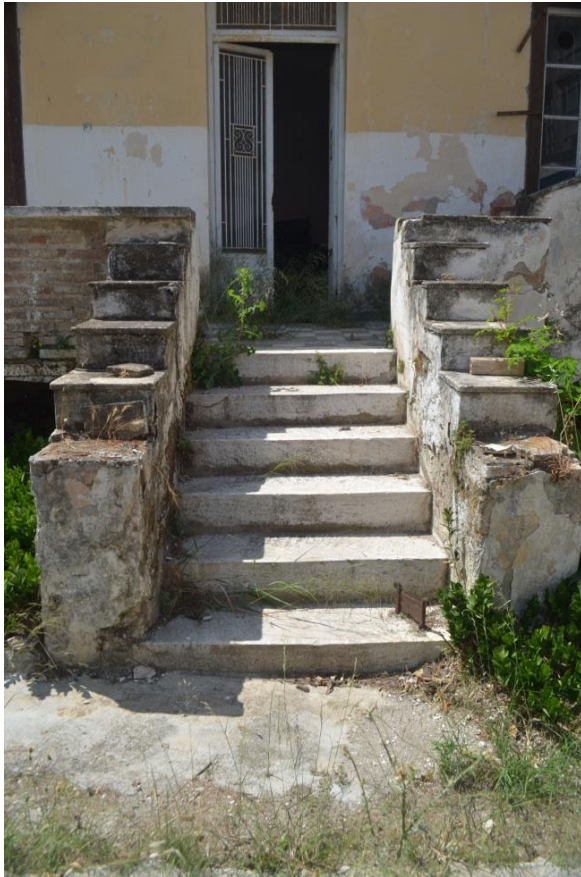
Β.2 εικ.7: Η κλίμακα ανόδου στο κτίριο Β. Φαίνονται, οι φθορές στις μαρμάρινες βαθμίδες της, καθώς και οι «θολούρα» και η αποσάθρωση της τοιχοποιίας δεξιά και αριστερά απ την κλίμακα, απ το επίχρισμα της. Στο βάθος φαίνεται ένα κούφωμα, μεταγενέστερης προσθήκης.
