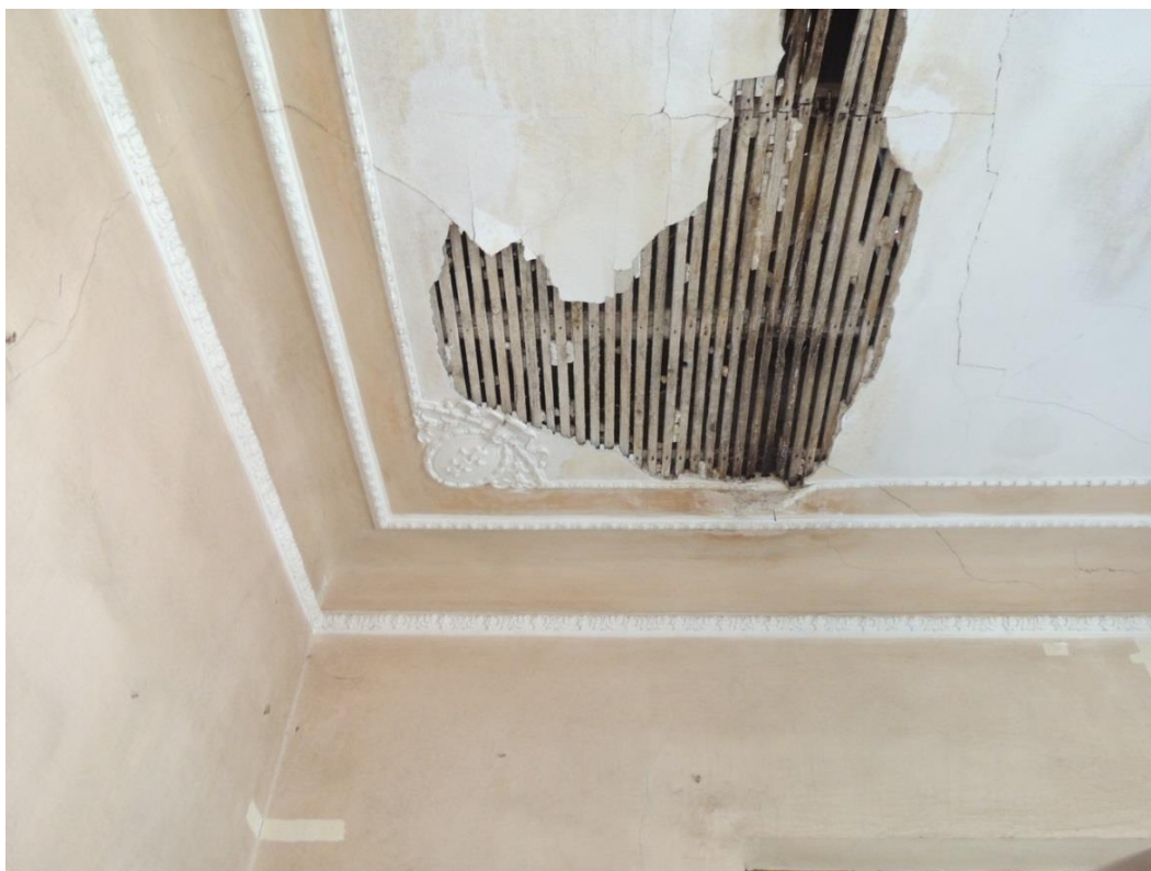
Α.4 εικ.22: Άνογη ορόφου κτιρίου Α. Έχουμε αποσάθρωση επιγρίσματος, διακοσμητικών ροζετών και χρώματος. Επίσης έχουμε και αποσάθρωση του ξύλινου μπαγδάτι.
