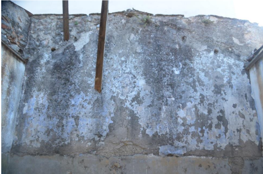
Γ.1 εικ.14 τοιχοποιία πατητηριού με αποσάθρωση επιχρίσματος και έντονη παρουσία
