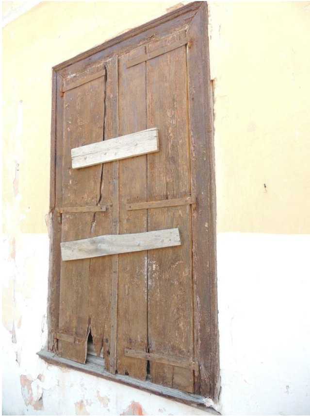
B.2 εικ.18: Εξωτερικό κούφωμα του κτιρίου Β. Φαίνεται έντονα η φθορά του στην πορεία των χρόνων.
