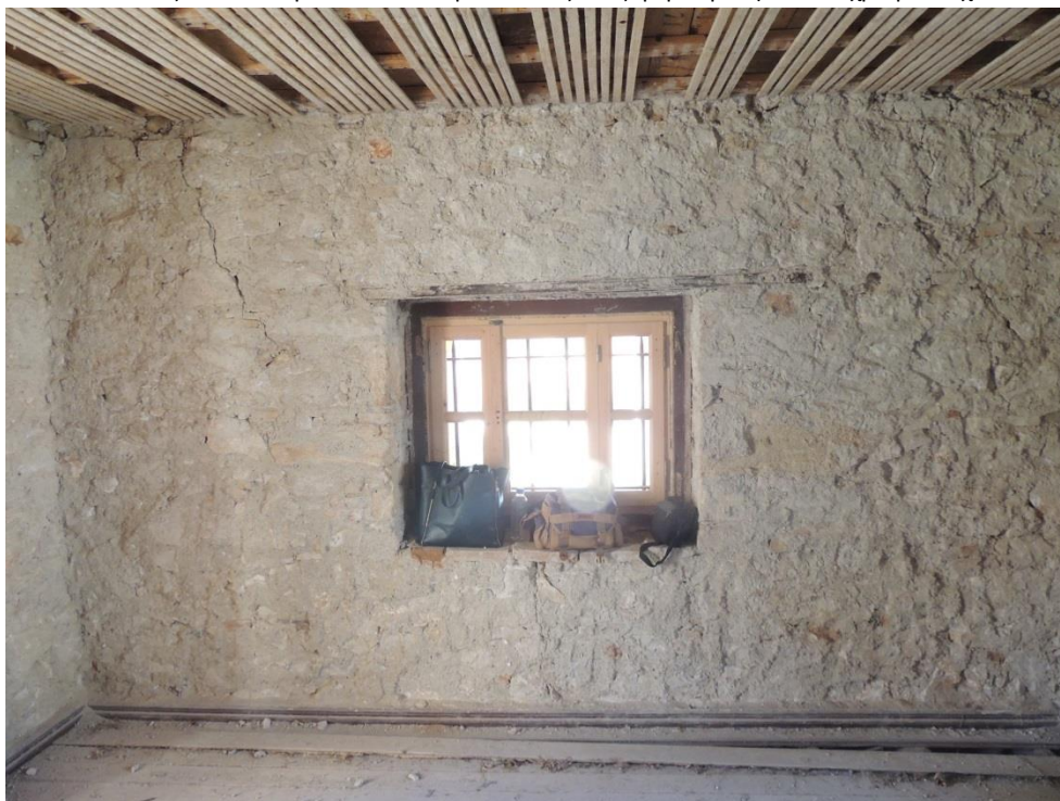
Α.2 εικ.5 Αποσαθρωμένη τοιχοποιία, ξύλινο πάτωμα κατεστραμμένο αν σημεία καθώς και η ψευδοροφή
