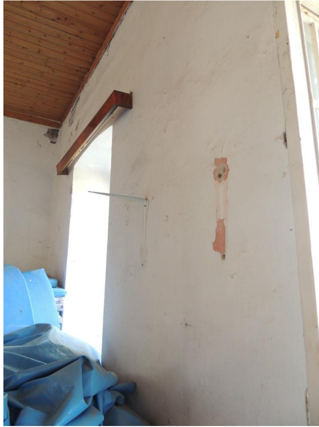
Β.2 εικ.15 Εμφανή υγρασία στην εσωτερική τοιχοποιία
