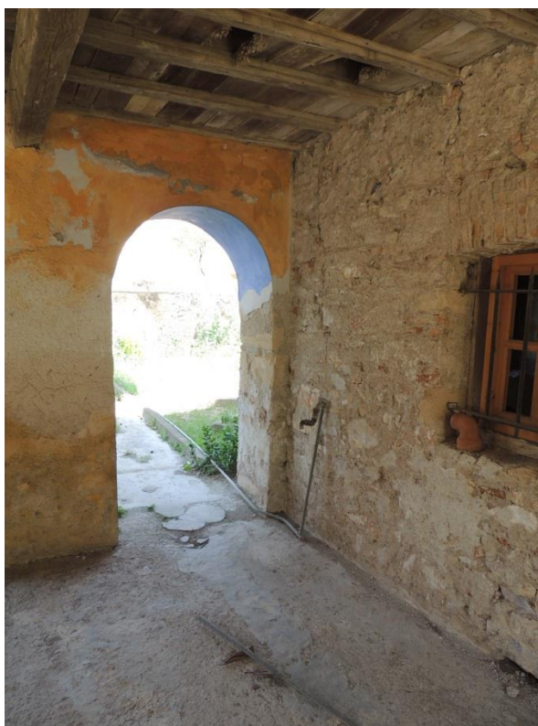
Α.3 εικ.22 Καταστραμμένο πατητό πάτωμα και αποσάθρωμένα επιχρίσματα
