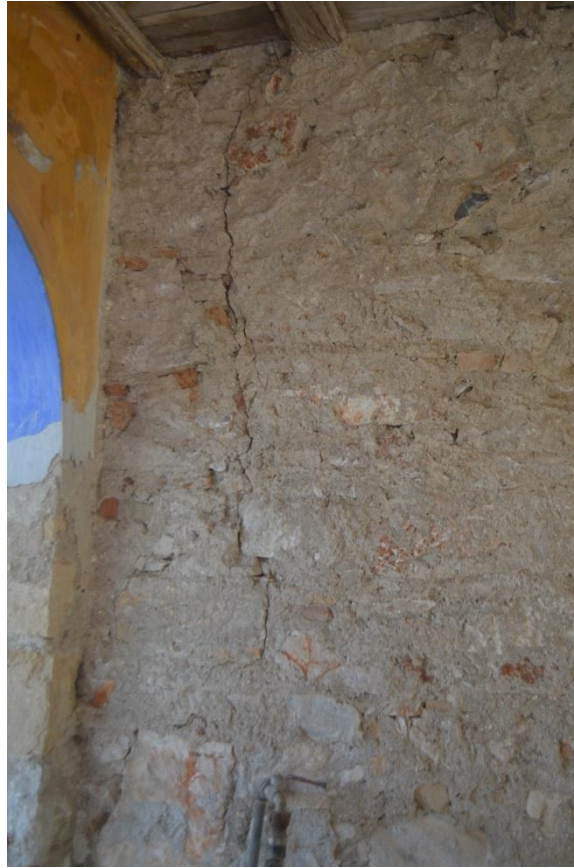
Α.3 εικ.8 Ξεγυμνωμένο μέρος της τοιχοποιίας με ρωγμή
