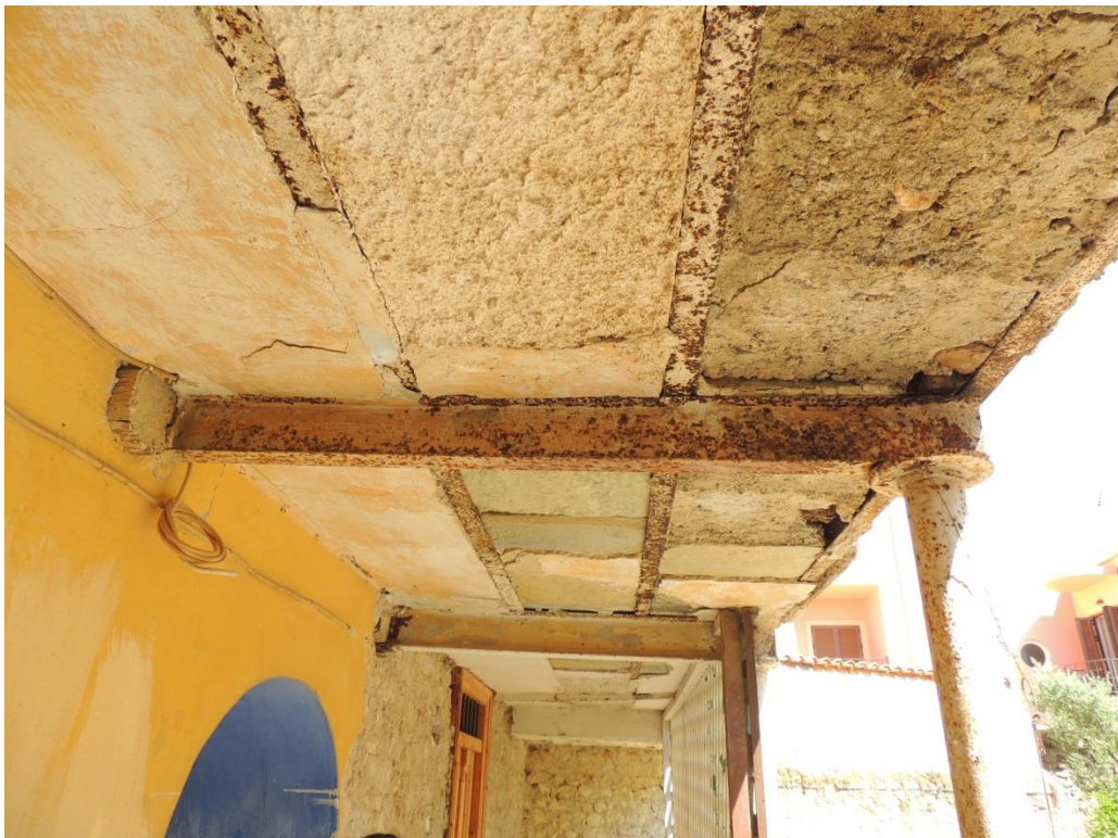
Α.3 εκ.20 Σιδηροδοκοί και μεταλλικά υποστυλώματα όπου στηρίζουν το κομμάτι του λακωτού, έχουν διαβρωθεί-σκουριάσει απ τα νερά. Βλέπουμε και αποσάθρωση επιχρίσματος.
