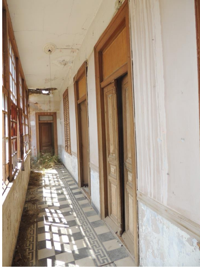
Α.4 εικ.15 Διάδρομος λιακτού, με σημάδια υγρασίας.
