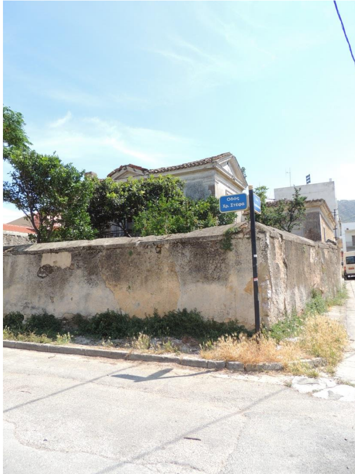
Γεν. εικ.19 Ο εξωτερικός μαντρότοιχος με έντονα τα σημάδια υγρασίας
