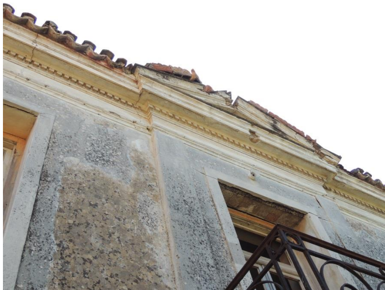
Α.1 εικ.28 Έντονη φθορά στο επίχρισμα και στα διακοσμητικά στοιχεία.
