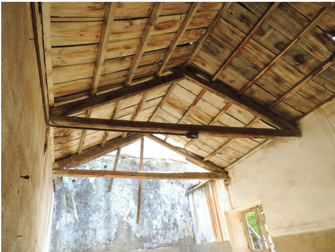
Γ.1 εικ.41: Το εσωτερικό του κτιρίου Γ, ο χώρος όπου βρίσκεται το πατητήρι. Η στέγη βλέπουμε να είναι καταστραμμένη κατά το 35%.
