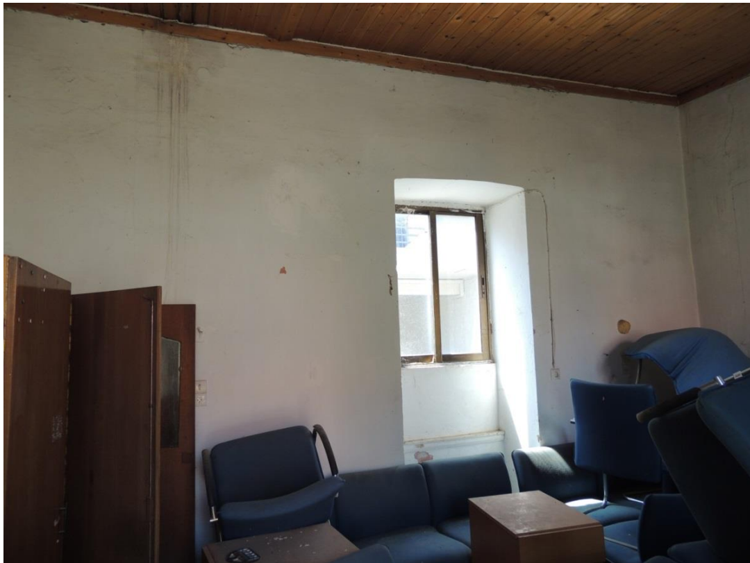
B.2 εικ.16: Το εσωτερικό του υπερυψωμένου ισογείου του Β κτιρίου. Πάνω αριστερά παρατηρούμε υγρασία.
