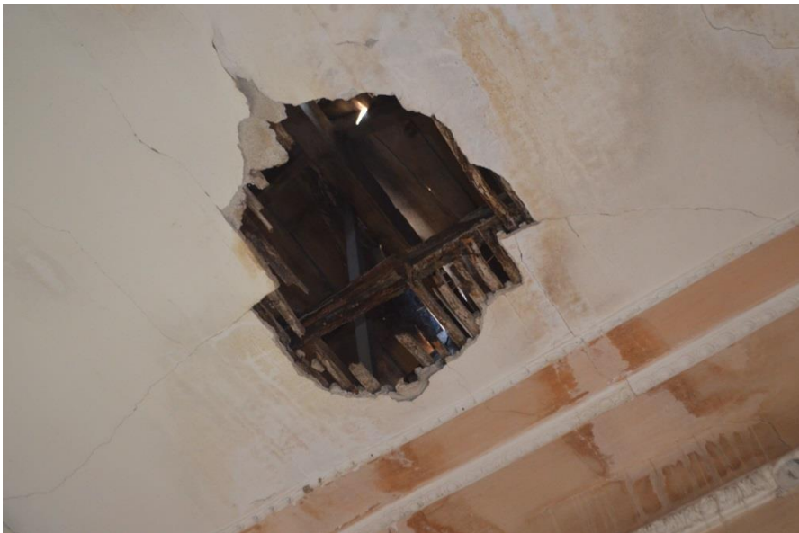
Α.4 εικ.3 Ψευδοροφή, αποσάθρωση επιχρίσματος και καταστροφή ξύλινου μπαγδάτι
