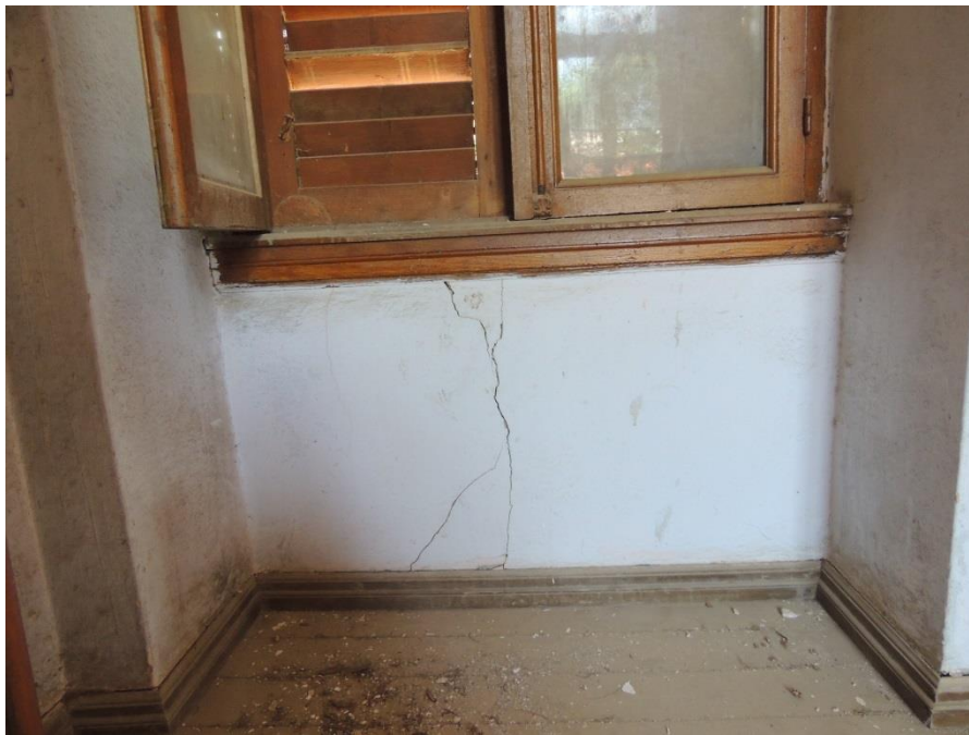
Α.4 εικ.39 Ρωγμή στην τοιχοποιία, στην ποδιά του παραθύρου
