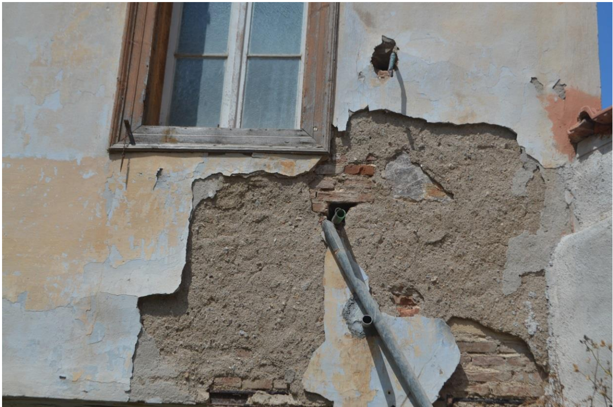
Α.1 εκ.14: Κομμάτι απ την όψη του κτιρίου Α. Έχουμε έντονη αποσάθρωση επιχρίσματος.
