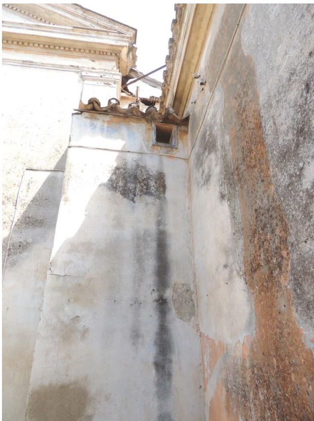
Α.1 εκ.33: Η δυτική πλευρά του κτιρίου Α. Φαίνεται έντονη η προσβολή της τοιχοποιίας απ την υγρασία
