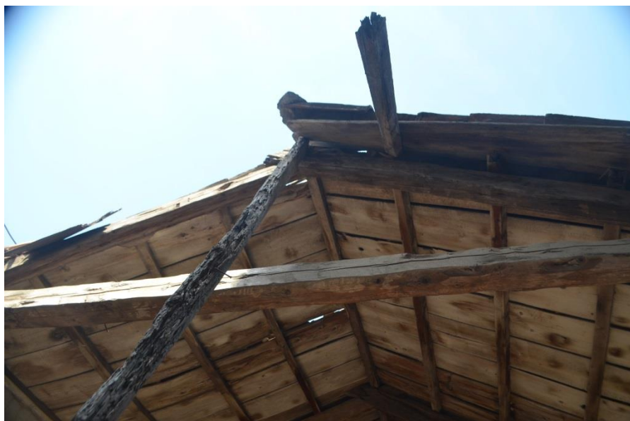
Γ.1 εικ.11 Λεπτομέρεια στέγης με σαπισμένα ξύλα
