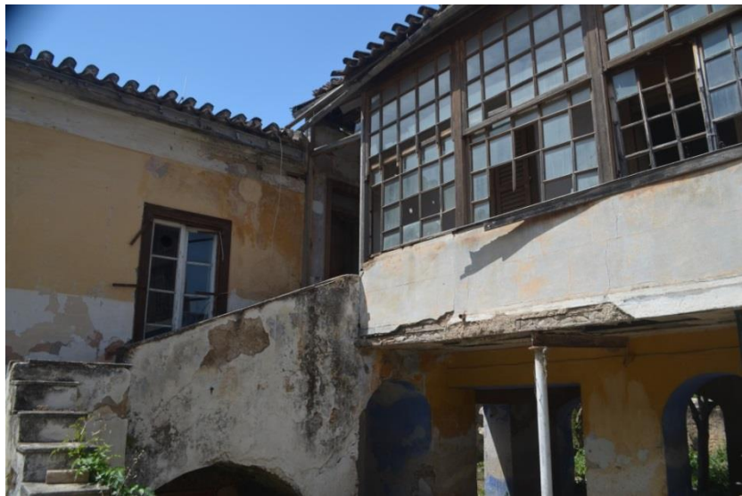
Α.1 εικ.21 Αποσάθρωση επιχρίσματος, υγρασία και σάπισμα ξύλου
