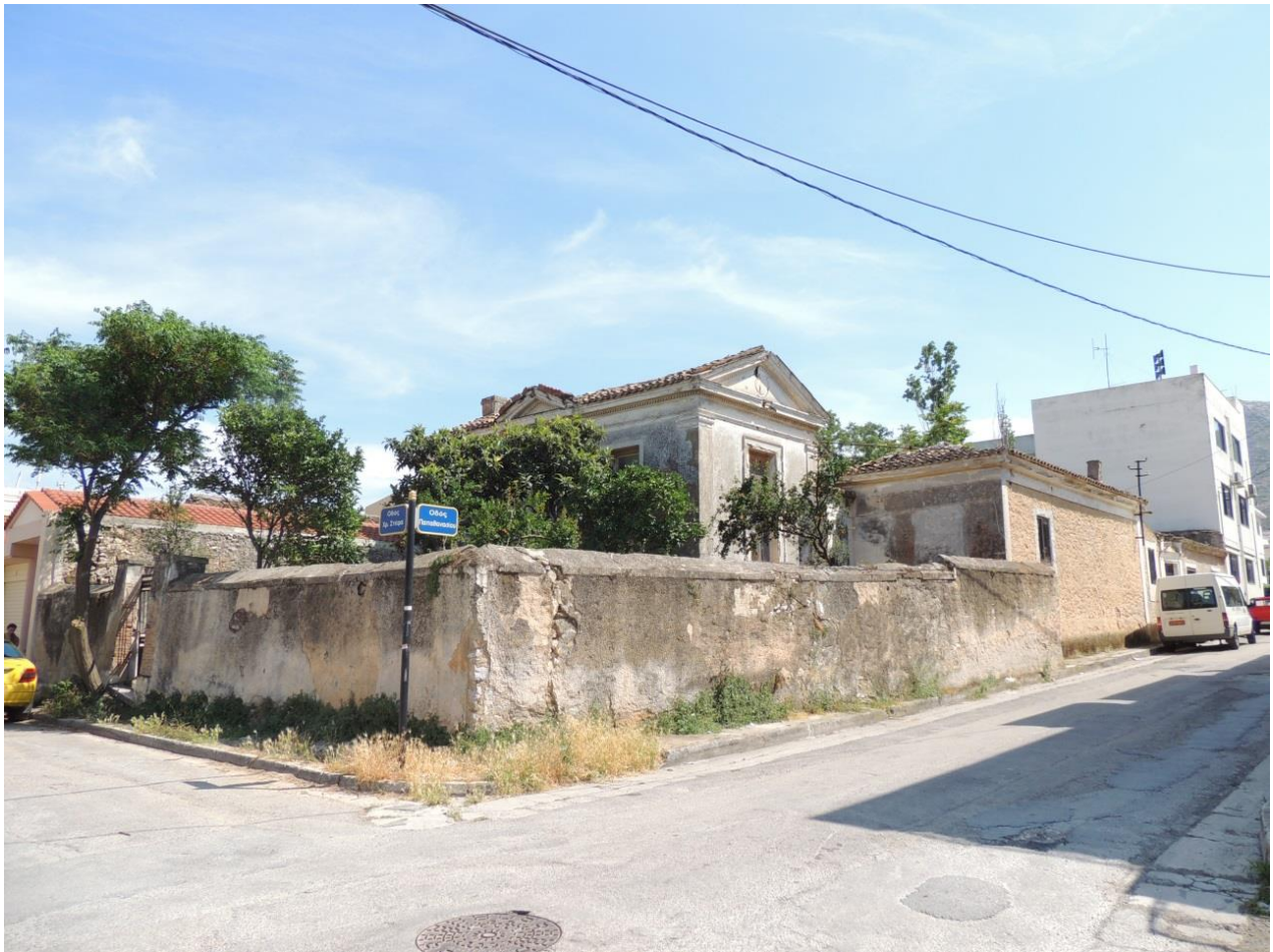
Γεν. εικ.20: Όπως φαίνεται εξωτερικά το κτιριακό μας συγκρότημα. Ο μαντρότοιχος του έχει έντονο υδροφόρο ορίζοντα και αποσάθρωση επιχρίσματος.
