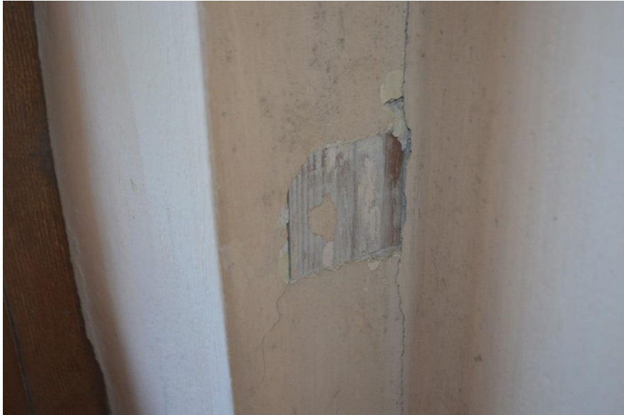
Α.4 εικ.5 Λεπτομέρεια τοιχοποιίας με αποσάθρωση επιχρίσματος (τριπτό- τριβιδιστό)
