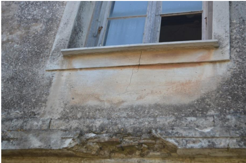
Α.1 εικ.5 Εξωτερική τοιχοποιία με εμφανή μικρό-ρωγμή
