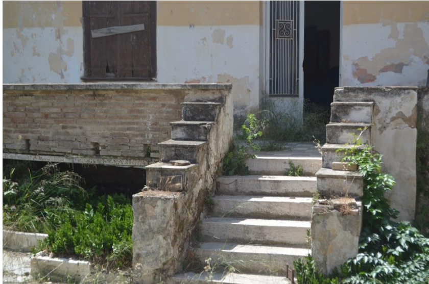
Β.2 εικ.6 Έντονες φθορές στην κλίμακα και στο τοιχίο της
