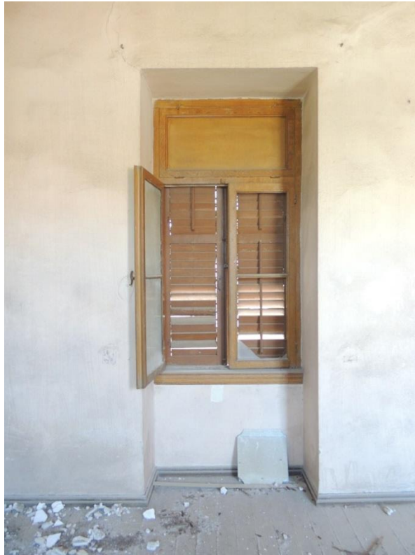
Α.4 εικ.19 Παράθυρο στον όροφο με σπασμένα τζαμλίκια
