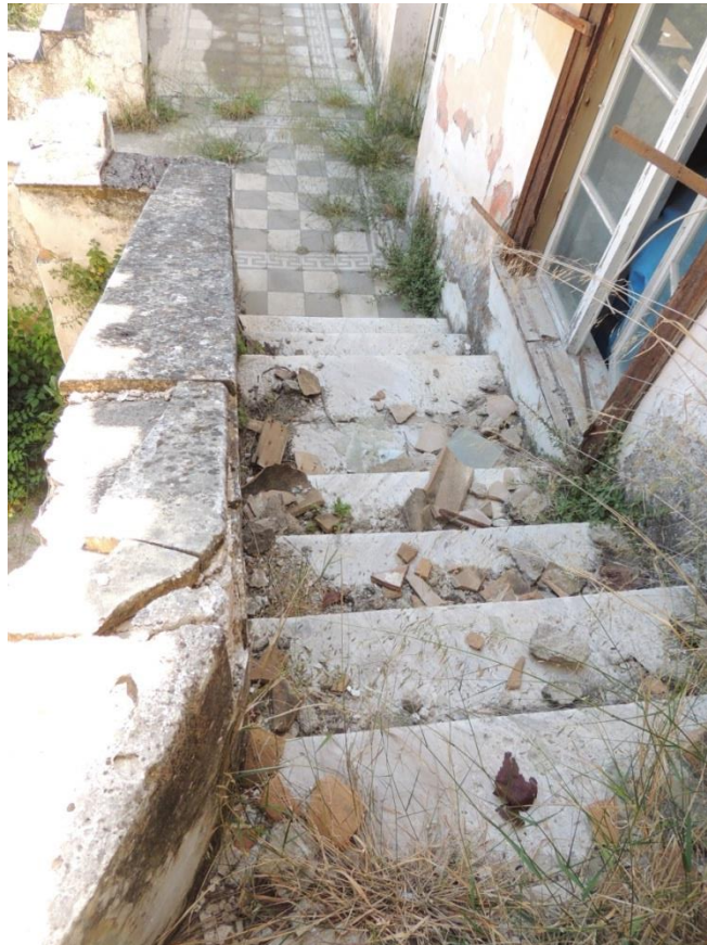
Α.4 Εξωτερική κλίμακα, με έντονες φθορές στο μάρμαρο καθώς και θολούρα
