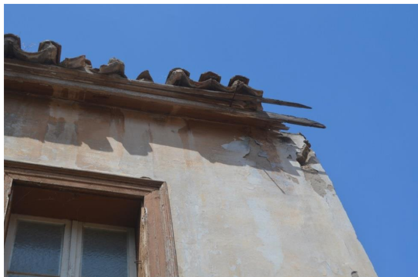
Α.1 εκ.19 Εξωτερική τοιχοποιία με αποσάθρωση επιχρίσματος
