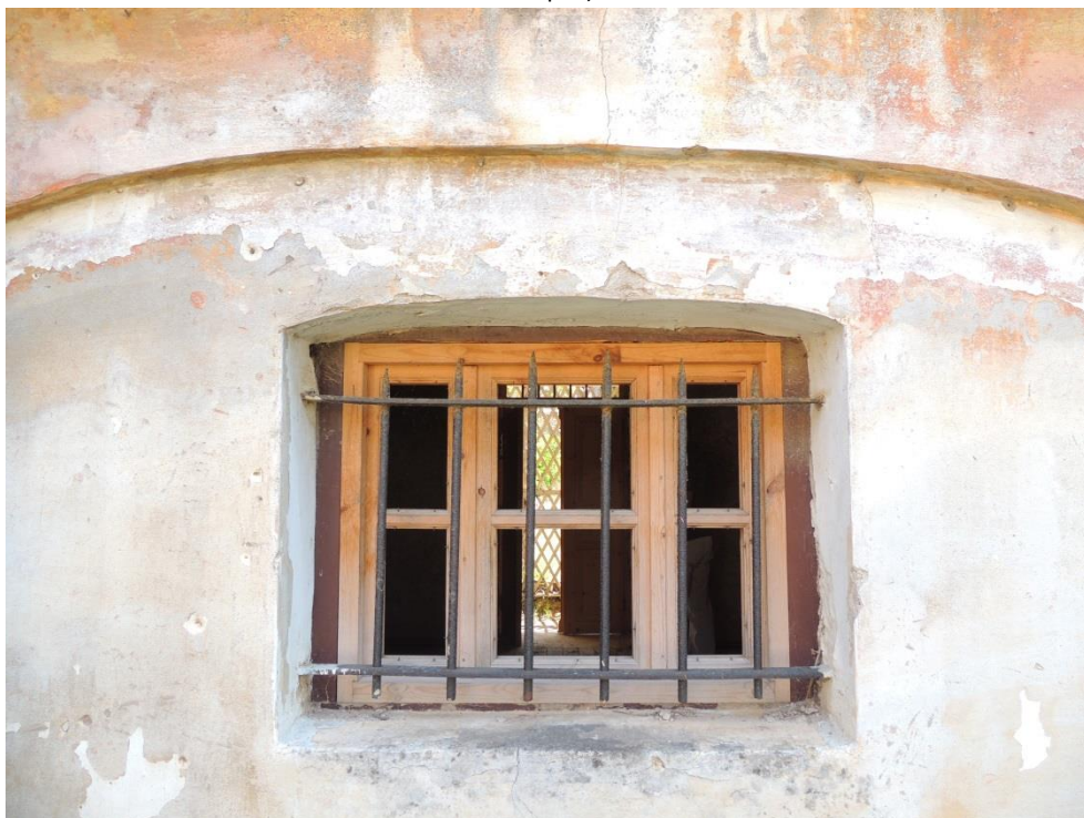
Α.3 εικ.8 Αποσαθρωμένη εξωτερική τοιχοποιία από επιχρίσματα και χρώμα και κούφωμα από ξύλο, χωρίς τζαμλίκι
