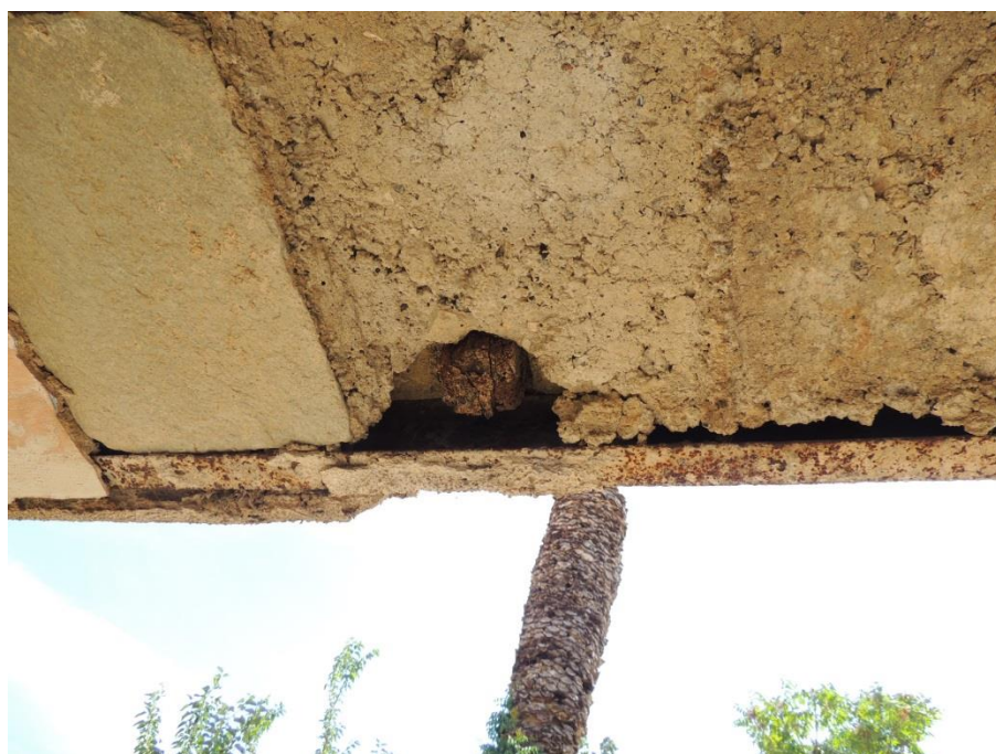
A.3 εικ.21 Σκουριά στους σιδηροδοκούς και στα μεταλλικά υποστυλώματα του λιακτού
