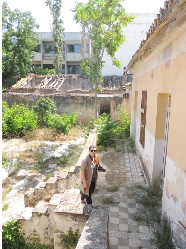
Β.2 εικ.11 Πλακάκια με έντονες φθορές (ανάπτυξη βλάστησης κ.α.)
