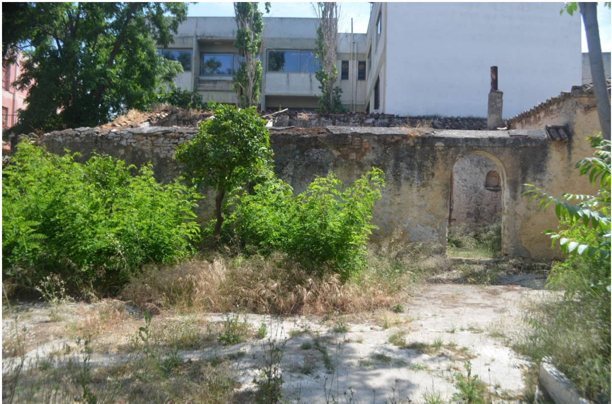
Γ.1 εικ.3: Η όψη του κτιρίου Γ. Έντονη είναι η υγρασία.
