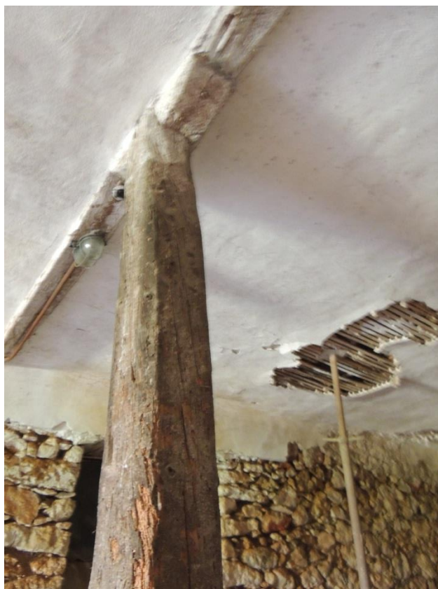
Β.1 εικ.11 Ξύλινα υποστυλώματα (σαπισμένα) και αποσάθρωση επιχρίσματος στην ψευδοροφή με αποτέλεσμα να φαίνεται το ξύλινο μπαγδάτι. ξύλινο μπαγδάτι.
