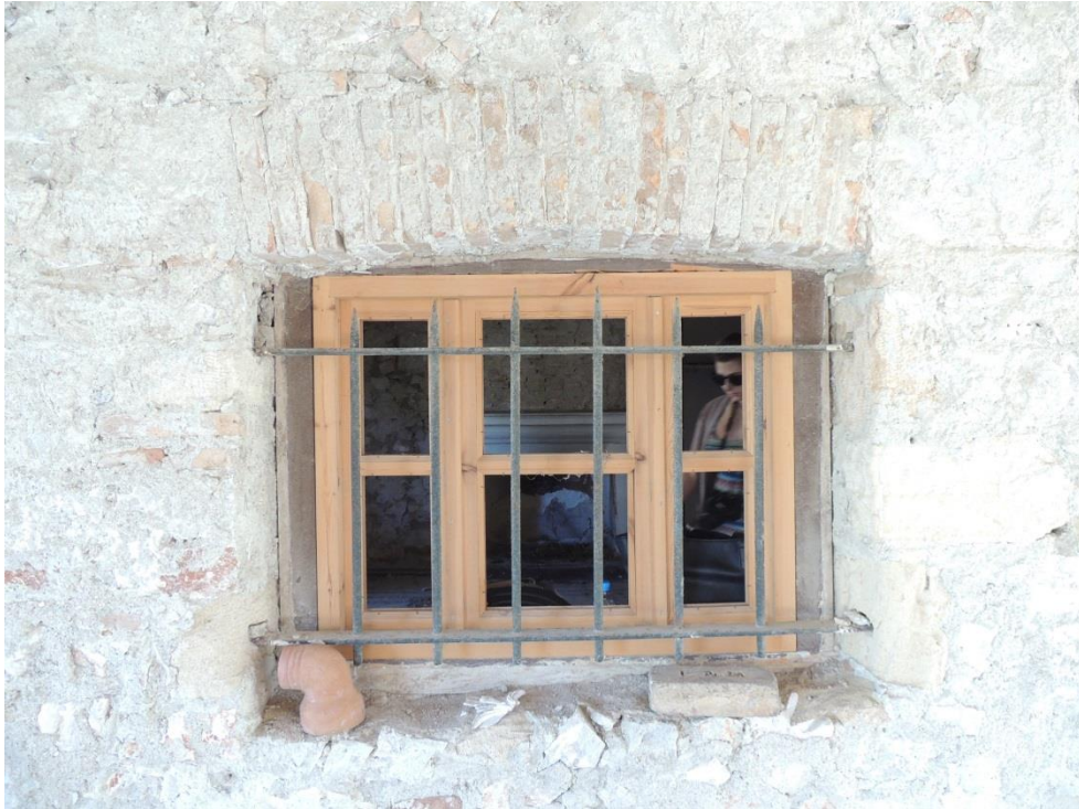
Α.2 εικ.7 Εξωτερική τοιχοποιία ξεγυμνωμένη από επιχρίσματα, μεταγενέστερα ξύλινα κουφώματα και σκουριασμένες σιδεριές.
