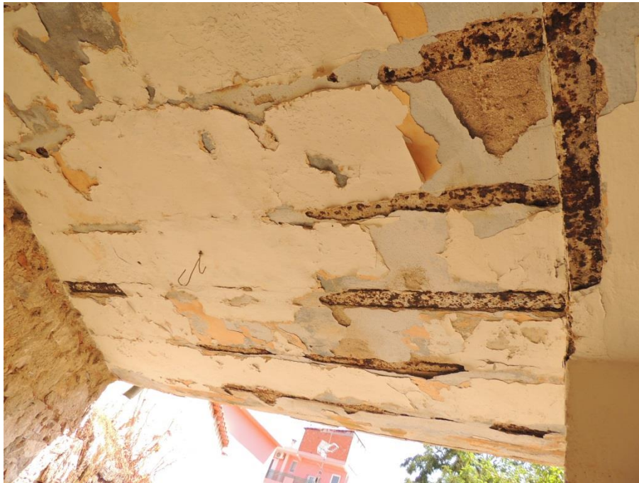
Α.3 εικ.16 Αποσάθρωση επιχρίσματος και χρώματος στην οροφή
