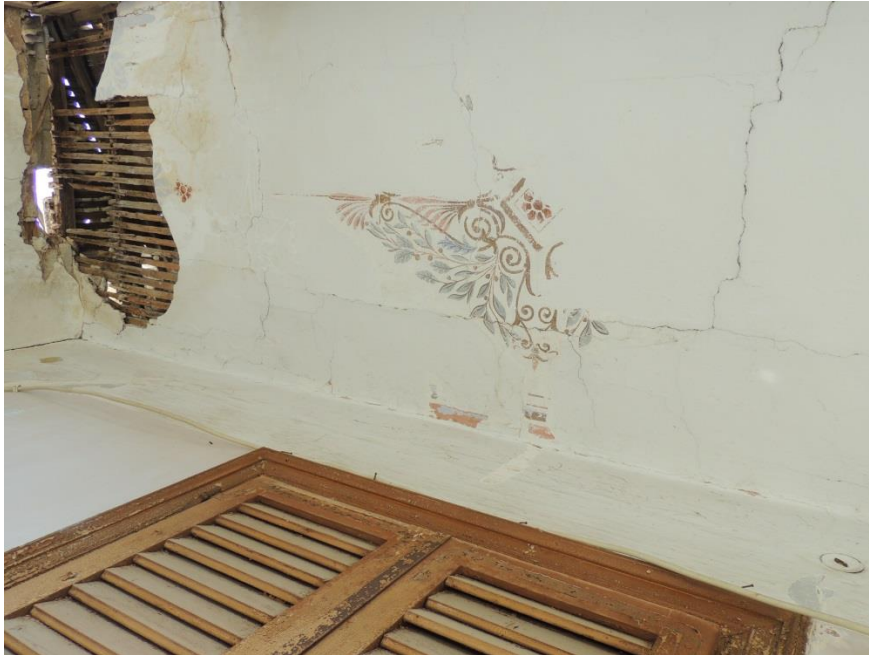
Α.4 εικ.8 Αποσάθρωση επιχρίσματος ψευδοροφής και διακοσμητικός διάκοσμος
