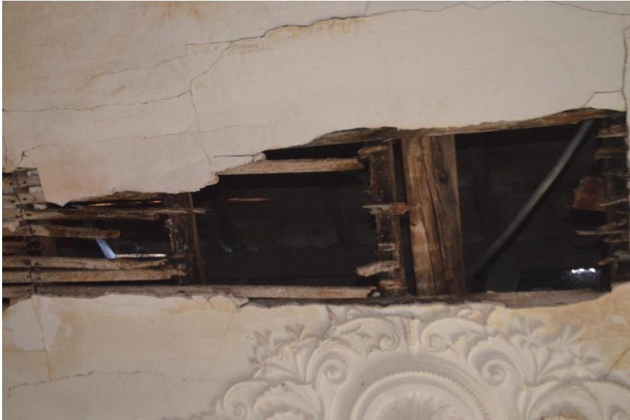
Α.4 εικ.1 Ψευδοροφή ορόφου, με καταστροφή ξύλινου μπαγδάτι
