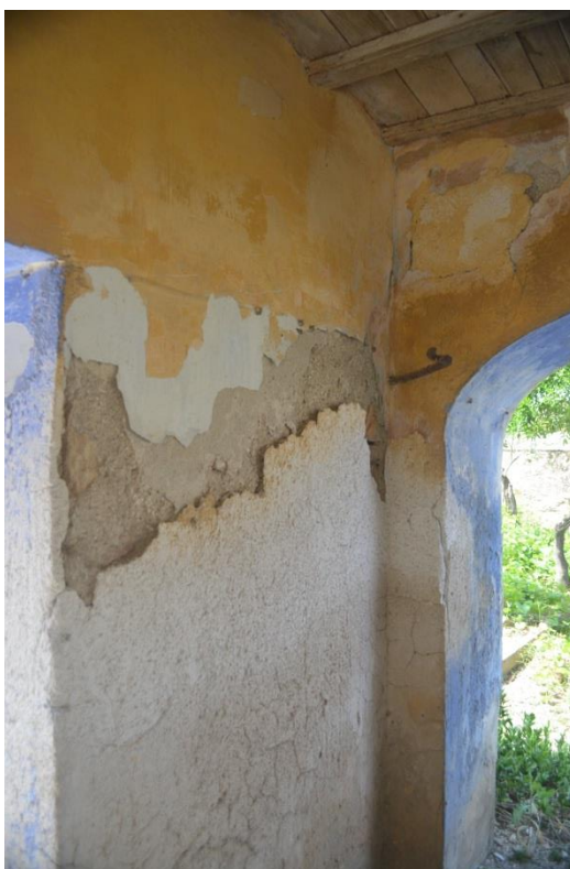
Α.3 εικ.4 Αποσάθρωση επιχρίματος και χρώματος
