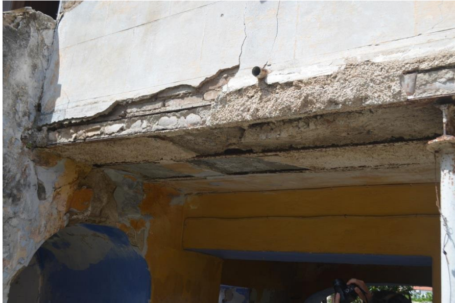
Α.3 εικ.9 Αποσάθρωση επιχρίσματος και φαίνεται και η σκουριά στους σιδηροδοκούς.
