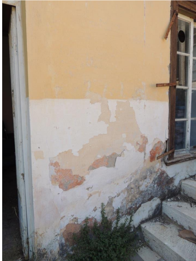
Β.2 εικ.13: Εξωτερική πρόσοψη κτιρίου Β. Αποσάθρωση τοίχου και εμφανής υγρασία.
