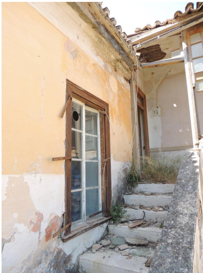
Β.2 εικ.12 Σαπισμένο κούφωμα και αποσαθρωμένος τοίχος
