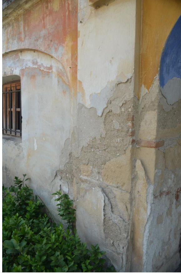
Α.3 εικ.6 Αποσάθρωση επιχρίσματος στην τοιχοποιία
