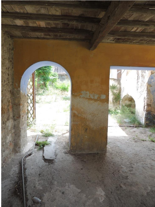
Α.3 εικ.25 Κατεστραμμένο πατητό δάπεδο και αποσάθρωση επιχρίματος
