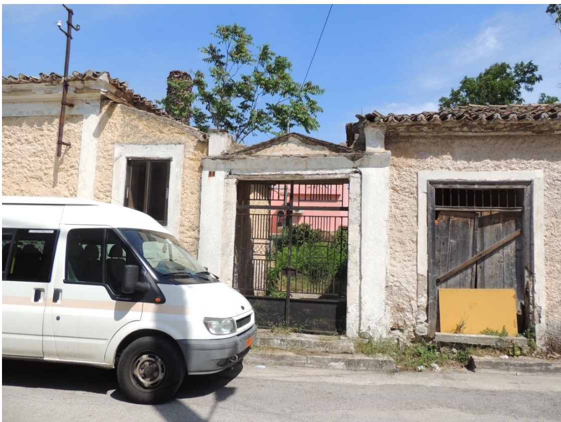
Γεν. εικ.21: Η δεύτερη κύρια είσοδο στον κτιριακό συγκρότημα. Βρίσκεται σε καλύτερη κατάσταση απ την πρώτη μας είσοδο, αλλά και αυτή έχει προβλήματα σκουριάς.
