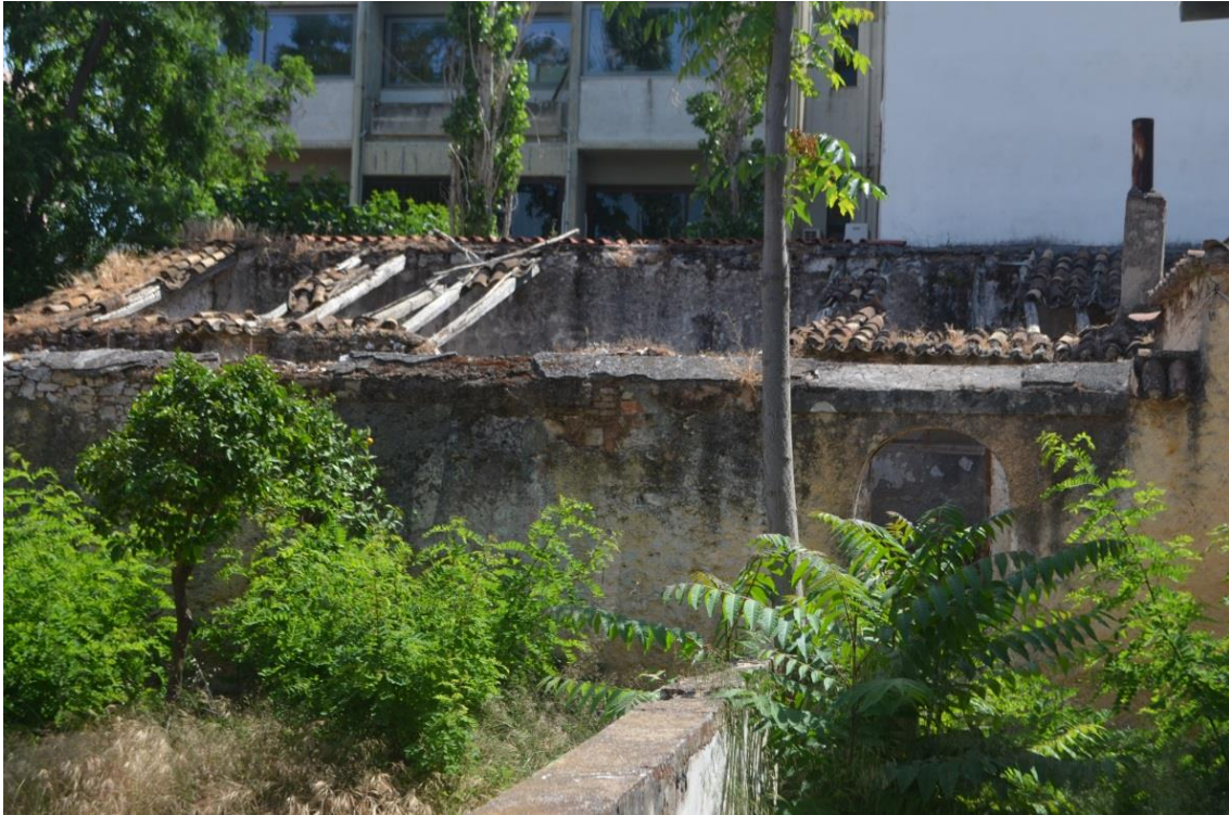
Γ.1 εικ.2: Η πρόσοψη του κτιρίου Γ, στην οποία βλέπουμε το πόσο έχει καταστραφεί η στέγη.
