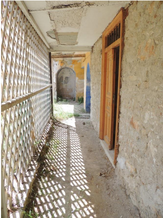
Α.3 εικ.17: Βλέπουμε τον διάδρομο στο χώρο του ισόγειου, όπου το δάπεδο είναι σχεδόν ανύπαρκτο και έχουμε και τον ξύλινο καφασωτό ανεμοφράκτη, που έχει προσβληθεί από μικροοργανισμούς.
