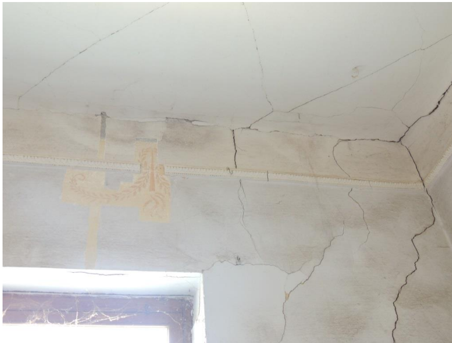
Α.4 εικ.42 Εμφανές ρωγμές στο επίχρισμα της τοιχοποιίας
