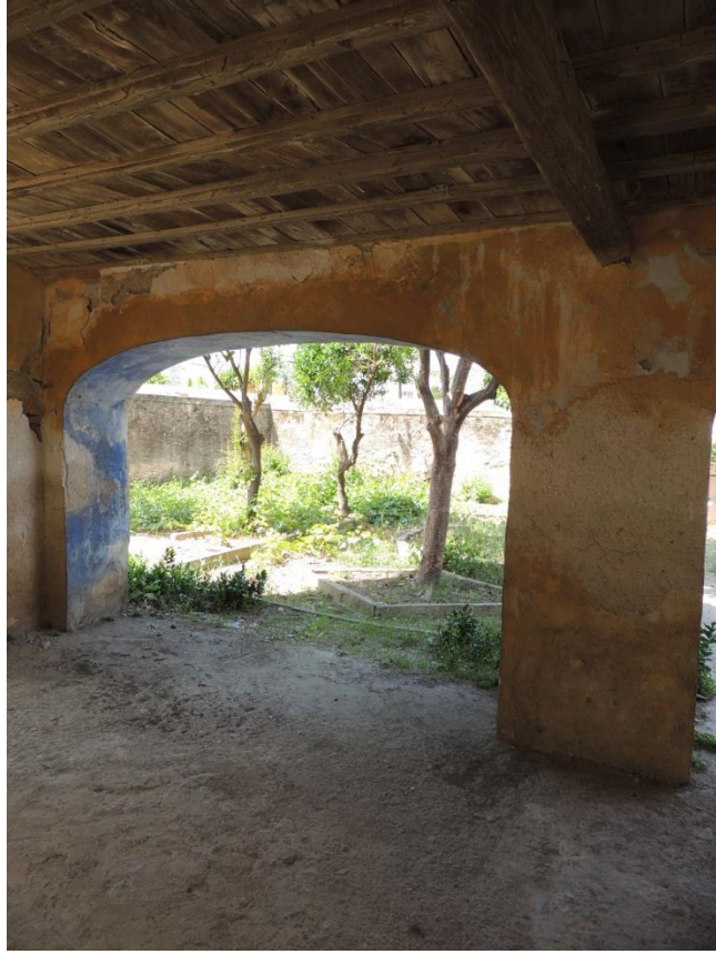
Α.3 εικ.28 Αποσάθρωση επιχρίσματος σε τοιχοποιία και οροφή και εμφάνιση υγρασίας
