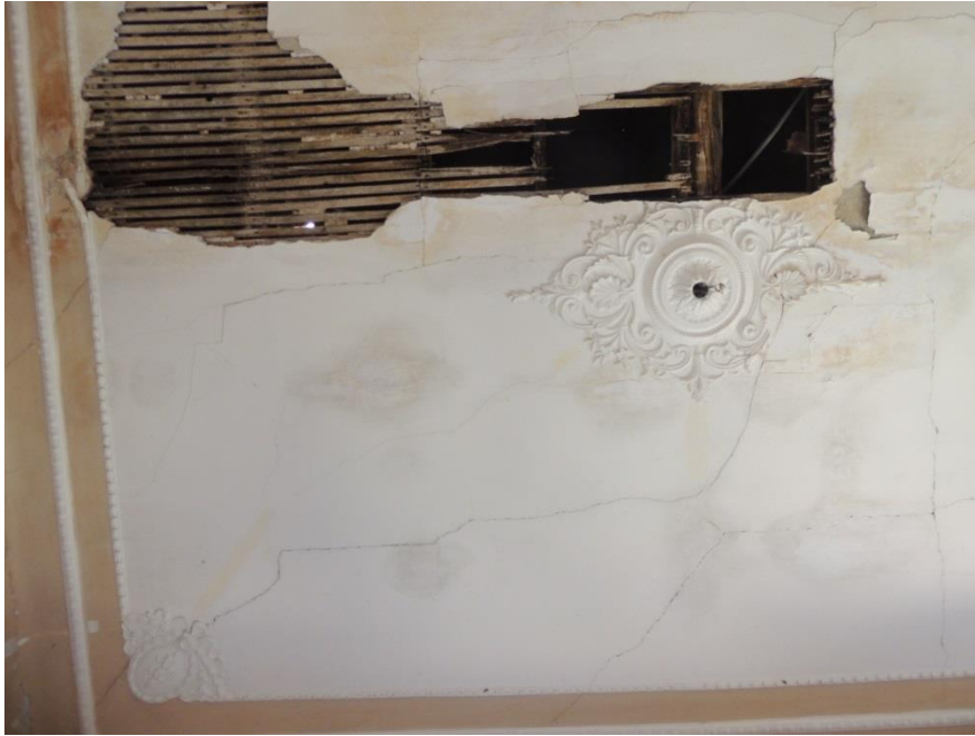
Α.4 εικ.29 Ψευδοροφή με αποσάθρωση επιχρίσματος και καταστροφή ξύλινου μπαγδάτι
