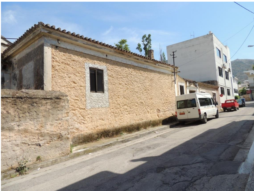
Β.2 εικ.23: Η όψη του κτιρίου Β προς την οδό Ε. Παπαθανασίου. Έντονη η εμφάνιση υδροφόρους ορίζοντα.
