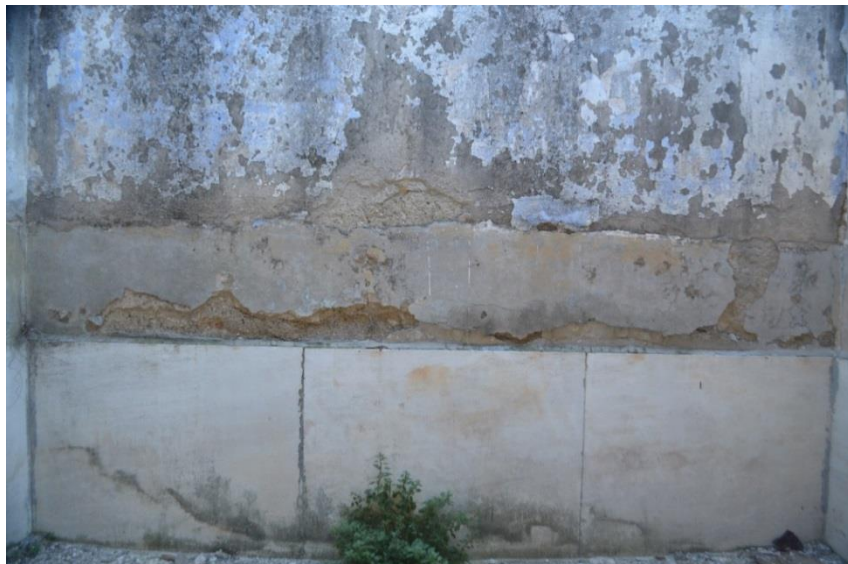
Γ.1 εικ.15 Αποσάθρωση τοιχοποιίας, εμφάνιση υγρασίας και θόλωση μαρμάρου
