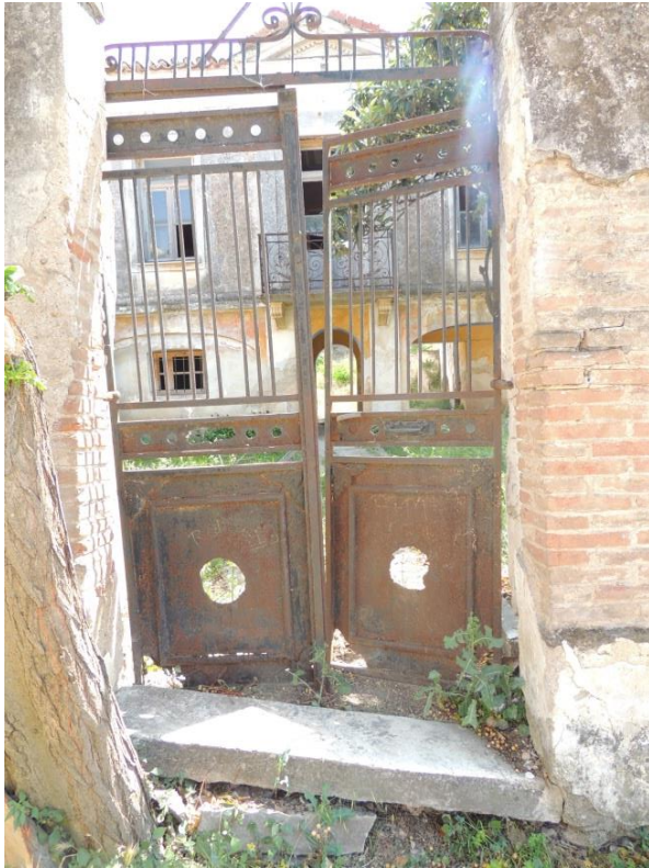
Γεν. εικ.18: Η θύρα στη κεντρική είσοδο της κατοικίας. Φαίνεται έντονα η σκουριά και το πλατύσκαλο όπου έχει ανέβει απ τις ρίζες του δέντρου.
