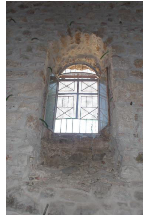
Μούχλα εσωτερικά στην Βόρεια όψη.
