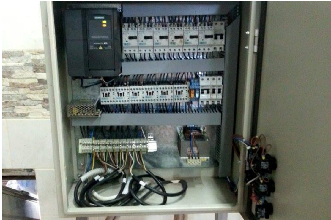
Εικόνα23:Υποπίνακας κίνησης στο ελαιοτριβείο ξανθός
