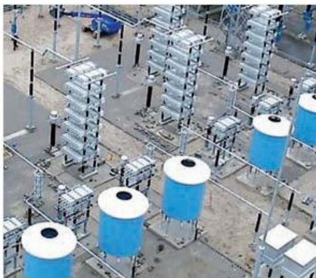
Εικόνα 3.16: Συστοιχία πυκνωτών υψηλής τάσης. [10]
