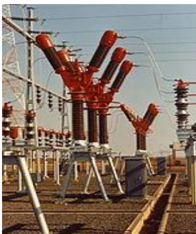
Εικόνα 3.9: Διακόπτες ισχύος υψηλής τάσεως τύπου πτωχού ελαίου. [1]
