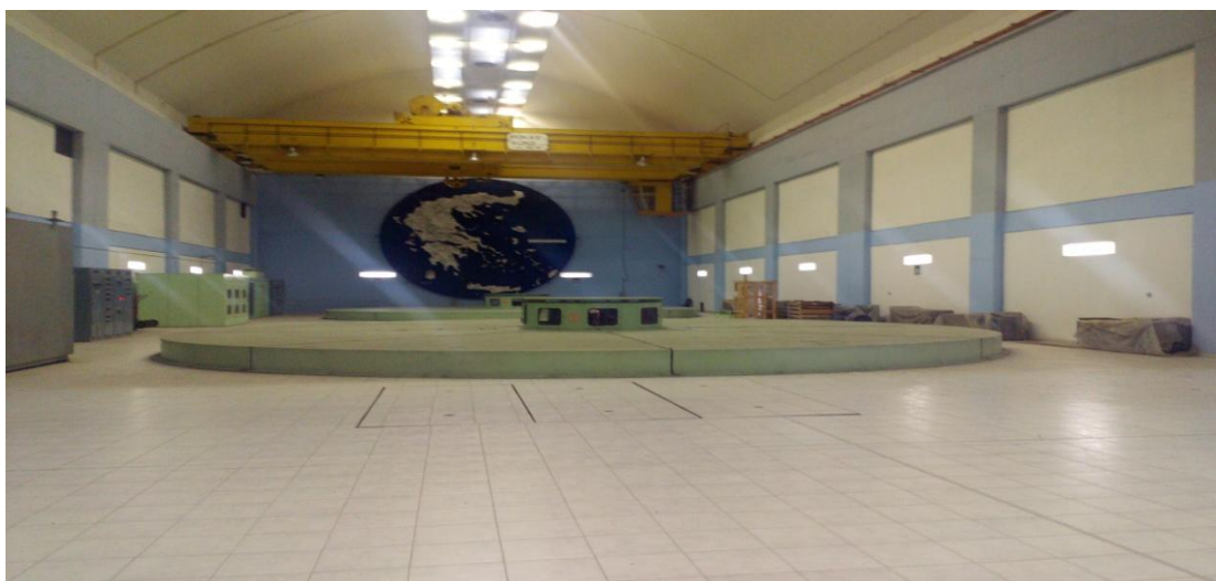
Εικόνα 3. Υπόγειος σταθμός παραγωγής
