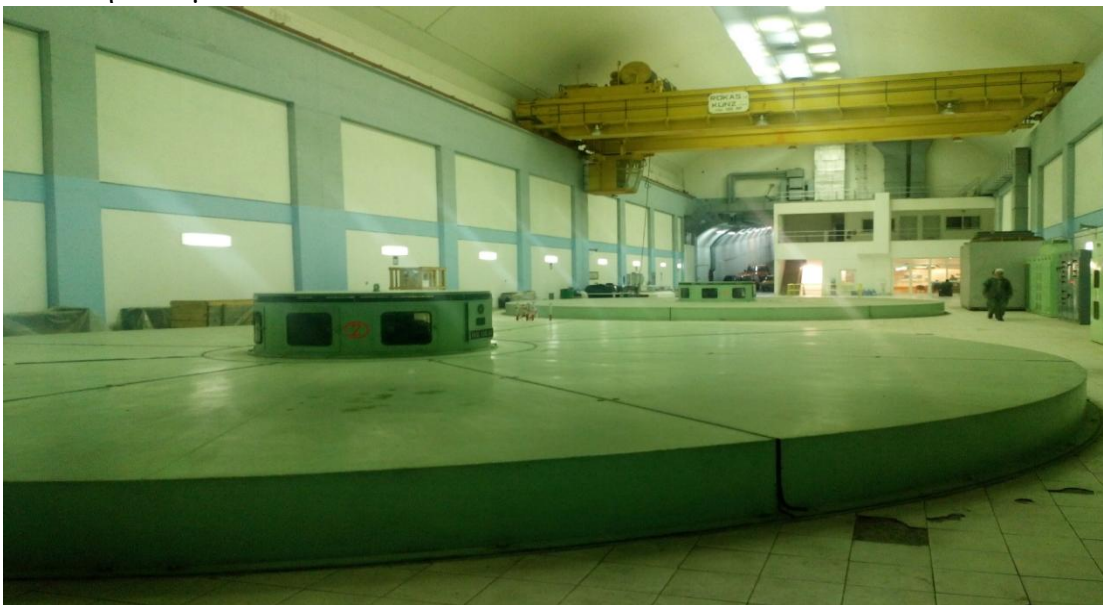
Εικόνα 3.7 Επάνω μέρος ηλεκτρικής γεννήτριας
