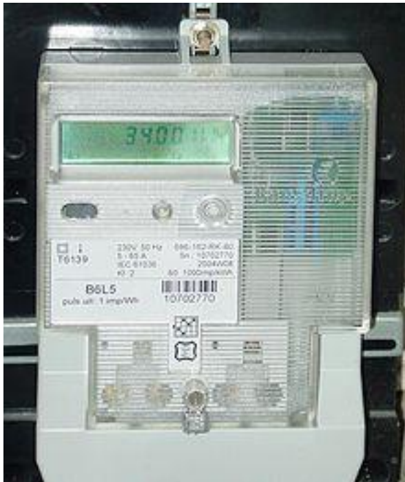
Εικόνα 28. Μετρητής ηλεκτρικής ενέργειας στερεάς κατάστασης.
