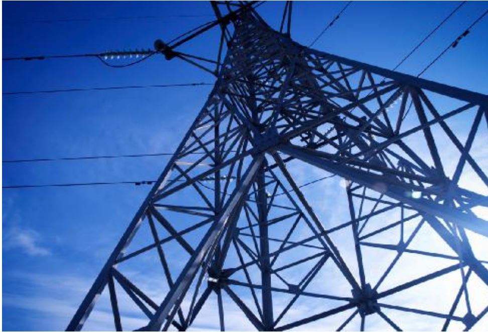
Εικόνα 3. Γραμμές υψηλής τάσεως στο συμβατικό δίκτυο
