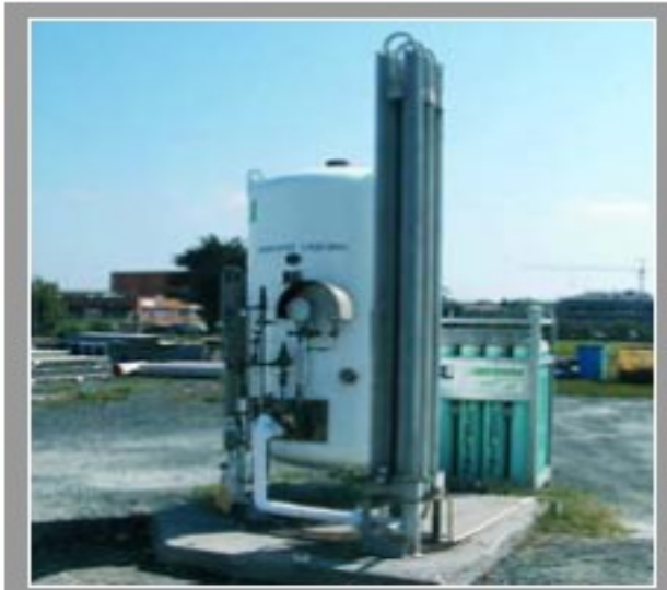
Σχήμα 3.21- Υγρή δεξαμενή οξυγόνου και μπουκάλες οξυγόνου
