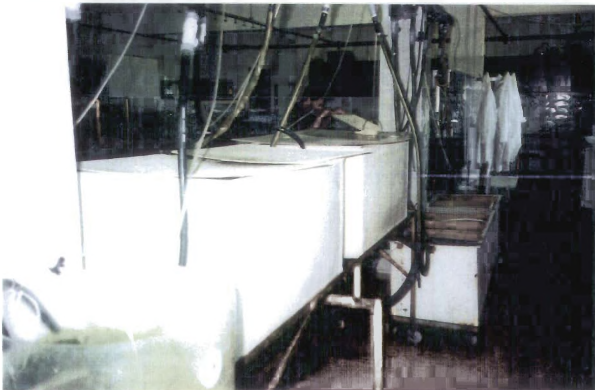
Φωτογραφία 1. - 2. Δεξαμενές κλειστού κυκλώματος στο ΤΕΙ Μεσολογγίου
