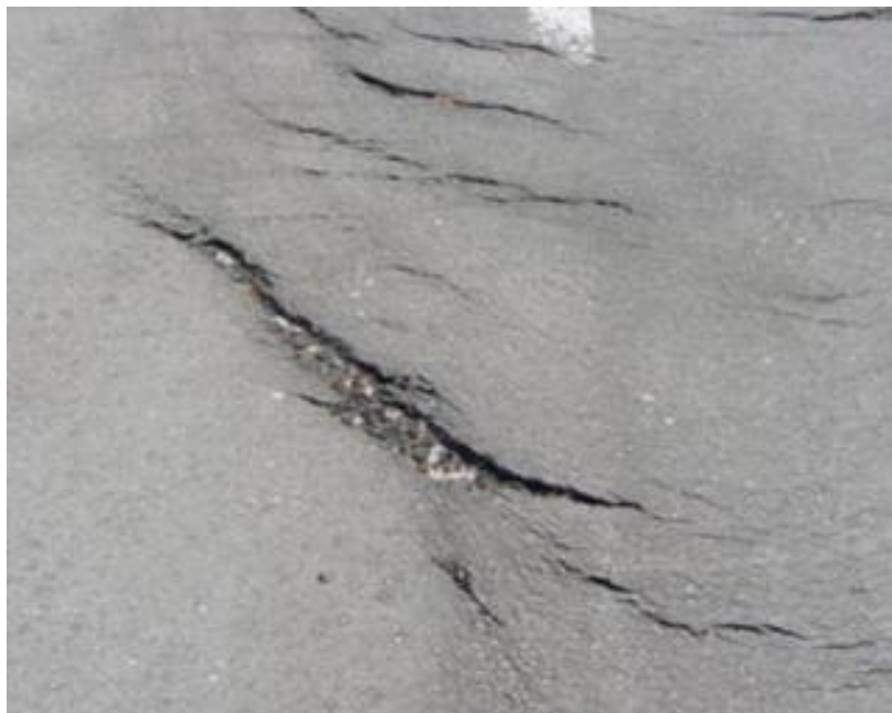
Εικόνα 3-8: Ρωγμές από ολίσθηση ταπήτων.
