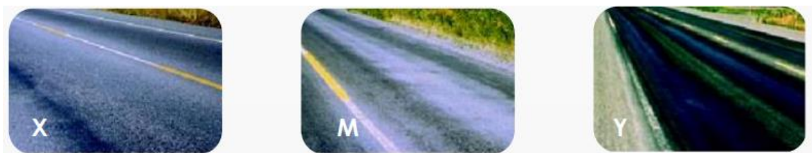
Εικόνα 3-16: Εξίδρωση οδοστρώματος- ανάδυση ασφαλτικού υλικού.
