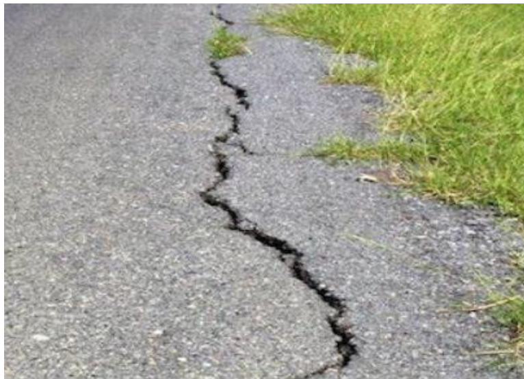
Εικόνα 3-6: Ρωγμές στα άκρα του οδοστρώματος.
