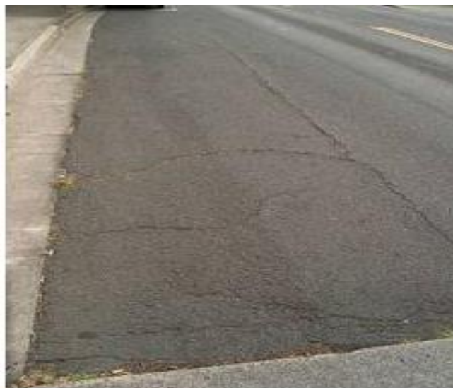
Εικόνα 3-5: Χαρακτηριστικές ρωγμές συρρίκνωσης.
