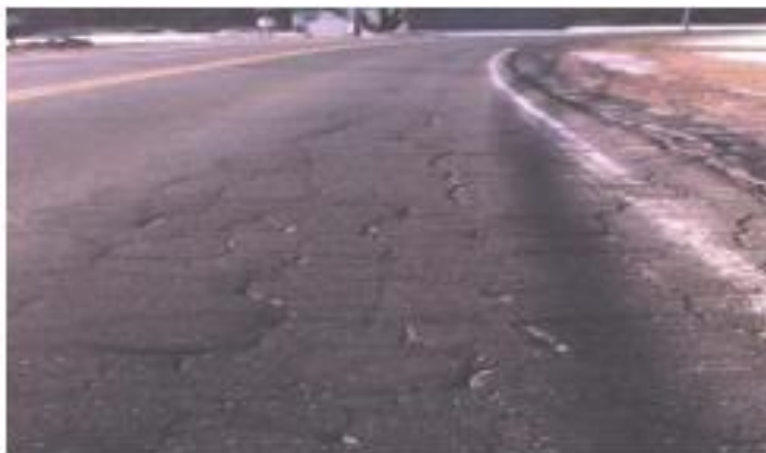
Εικόνα 3-1: Ρωγμές τύπου αλιγάτορα .
