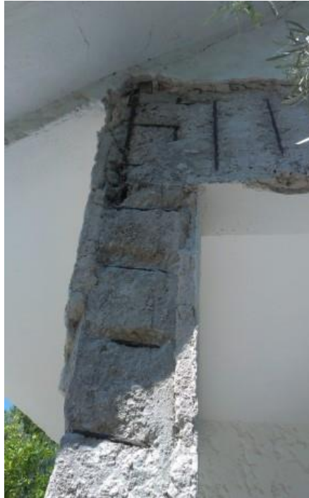
Εικόνα 19: Βλάβη από ενανθράκωση σε οπλισμένο σκυρόδεμα σε προχωρημένο βαθμό. (Σιώμος)
