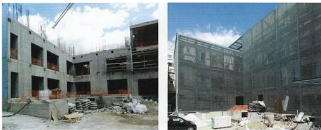
Εικόνα 190: Τοποθέτηση συνεχούς μανδύα στην εξωτερική - μη διατηρητέα όψη του ακάλυπτου χώρου, ο οποίος χρησιμοποιήθηκε για στήριξη της δεύτερης μεταλλικής όψης - φίλτρου ηλιοπροστασίας. (ΚΤΙΡΙΟ 2022, σελ.98)
