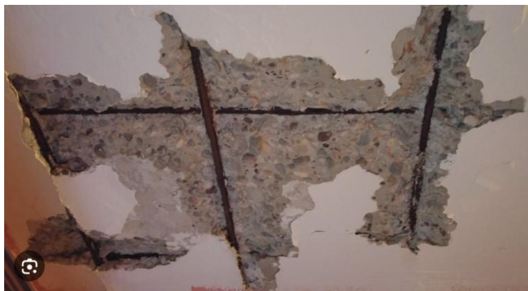
Εικόνα 17: Οξειδωμένοι ράβδοι οπλισμού σε πλάκα. (αρχείο Μπισκίνη Δ.)
