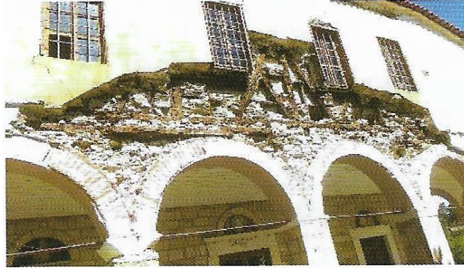
Εικόνα 139: Βλάβη σε ξυλόπηκτη τοιχοποιία. (Σπυράκος 2019, σελ.46)
