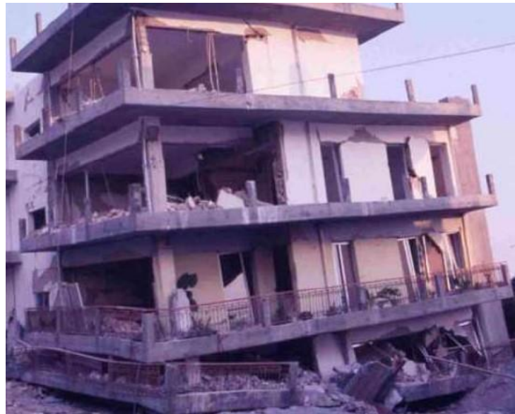
Εικόνα 5: Αστοχία σε εύκαμπτο όροφο - κτίριο τύπου pilotis. (αρχείο Μπισκίνη Δ.)
