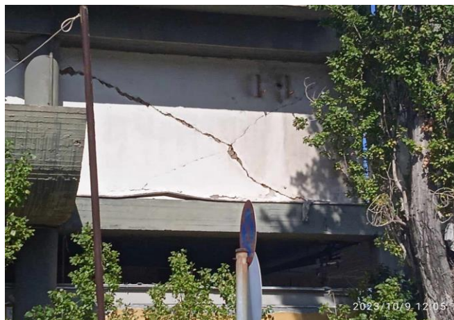
Εικόνα 43: Διατμητική ρηγματώση σε τοιχοπλήρωση. (προσωπικό αρχείο)
