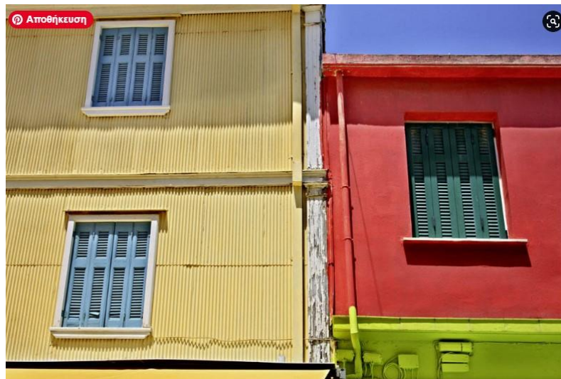
Εικόνα 15: Ύπαρξη αντισεισμικού αρμού ανάμεσα σε γειτονικά κτίρια. (Ροββά 2015)
