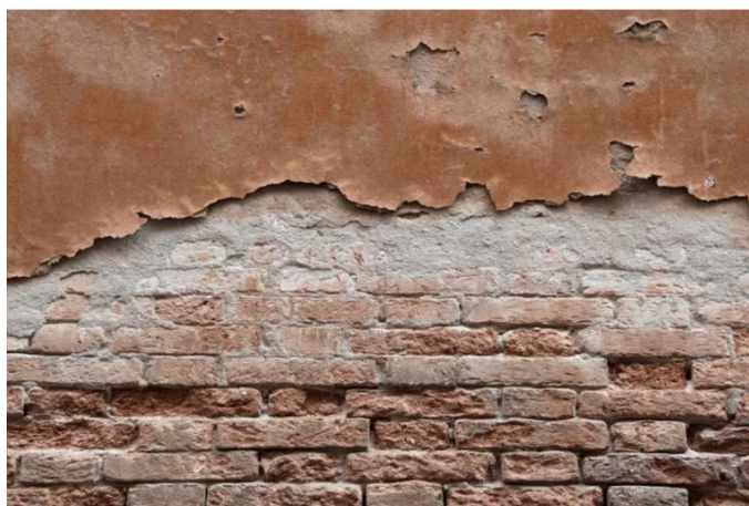
Εικόνα 137: Διάβρωση επιχρίσματος και κονιάματος από ανερχόμενη υγρασία. (SIKA Hellas)
