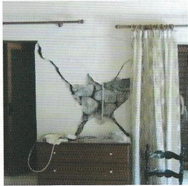
Εικόνα 109: Διάτμηση πεσσού. Εμφάνιση χιαστί ρωγμής. (Σπυράκος 2019, σελ.44)
