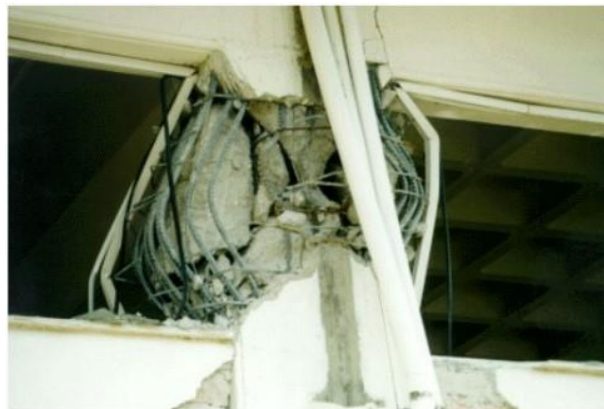
Εικόνα 27: Βλάβη σε κοντό υποστυλώμα. (αρχείο Μπισκίνη Δ.)
