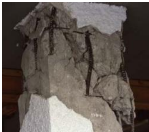
Εικόνα 47: Πλήρης αποδιοργάνωση του σκυροδέματος και λυγισμός των ράβδων. (αρχείο Μπισκίνη Δ.)
