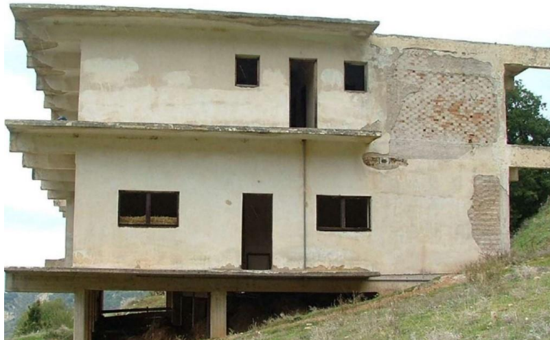
Εικόνα 18: Αποσάθρωση και αποκόλληση επιχρίσματος. (αρχείο Μπισκίνη Δ.)
