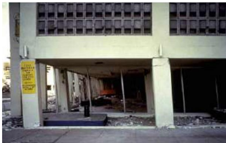
Εικόνα 6: Αστοχία σε εύκαμπτο όροφο - κτίριο τύπου pilotis. (αρχείο Μπισκίνη Δ.)
