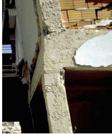
Εικόνα 12: Αστοχία στη σύνδεση δοκού - υποστυλώματος. (αρχείο Μπισκίνη Δ.)
