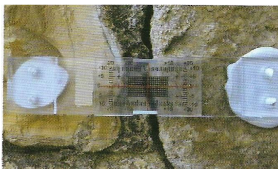
Εικόνα 141: Μέτρηση ρωγμής με ρωγμόμετρο. (Σπυράκος 2019, σελ.51)
