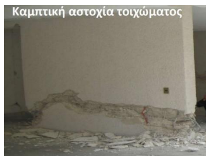
Εικόνα 31: Βλάβη φέροντος τοιχώματος λόγω κάμψης και θλίψης. (αρχείο Μπισκίνη Δ.)
