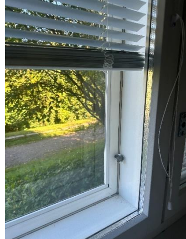
Εικόνα 2.2: Ξύλινο παράθυρο με διπλό τζάμι για λόγους θερμομόνωσης.
