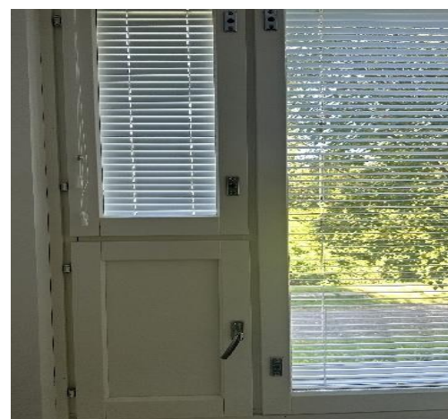
Εικόνα 2.4: Ξύλινα παράθυρα με διπλό τζάμι για λόγους θερμομόνωσης.
