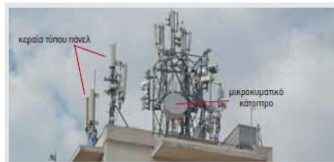
Σχήμα 4.1. Κεραίες από τις οποίες αποτελείται ένας χαρακτηριστικός σταθμός βάσης
