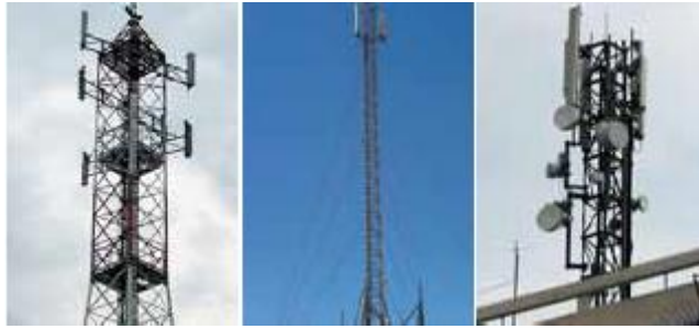
Σχήμα 4.3. Τυπικοί σταθμοί βάσης
