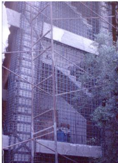
Εικόνα 41: Κατασκευή μανδυών Ο.Σ. μαζί με την εφαρμογή της τεχνικής του μεταλλικού κλωβού.
