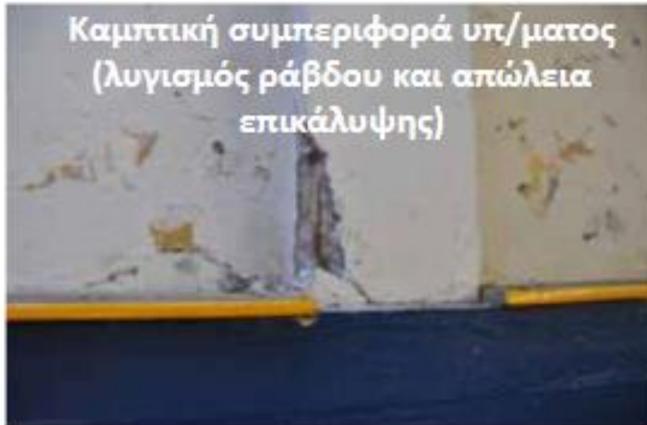
Εικόνα 14: Καμπτική βλάβη υποστυλώματος.
