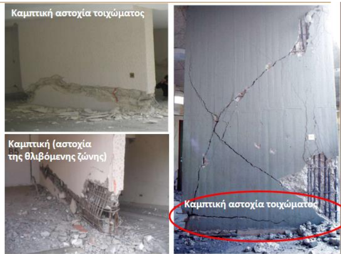
Εικόνα 16: Καμπτική Αστοχία Τοιχώματος.
