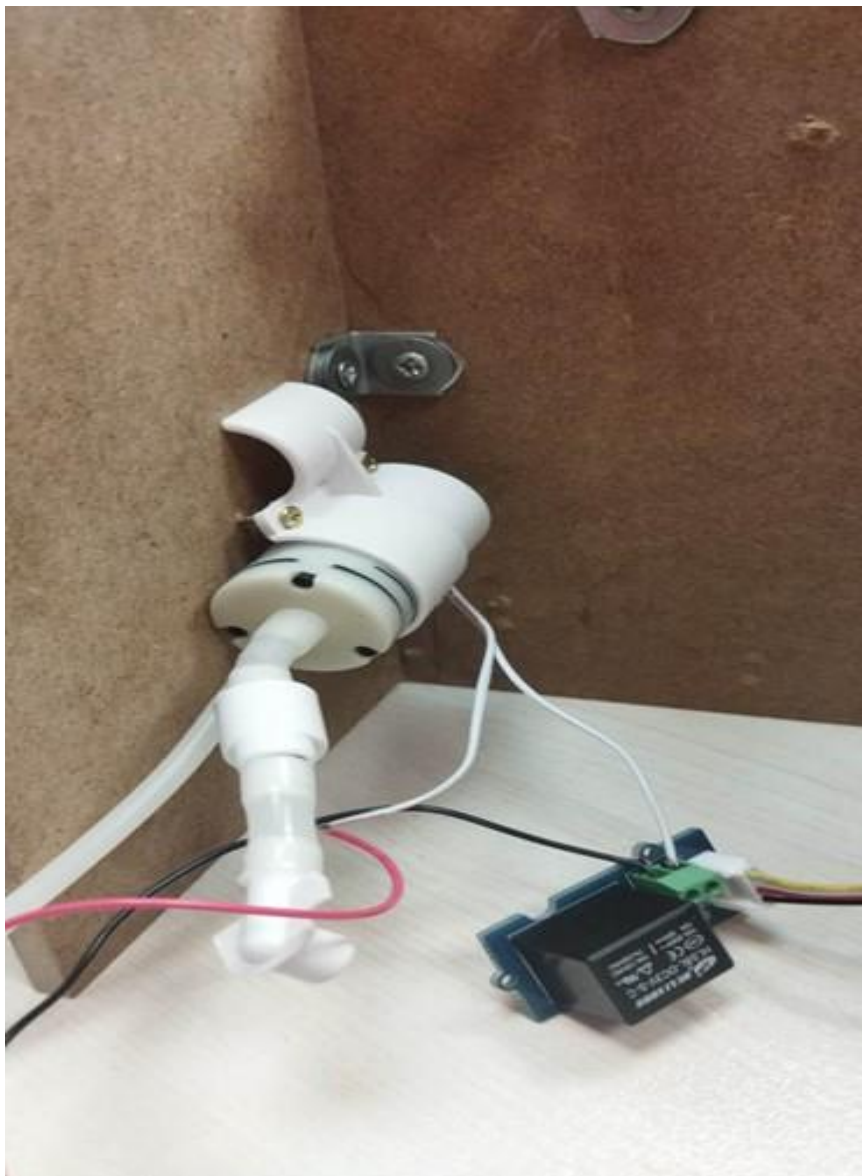
Εικόνα 3.3: Απεικονίζονται η αντλία η οποία έπρεπε να τοποθετηθεί μακριά από τα ηλεκτρονικά μέρη ώστε να μην προκληθεί οποιαδήποτε ζημιά (π.χ. βραχυκύκλωμα) και στηρίζεται από μια κυλινδρική βάση, λόγω του σχήματός της.
