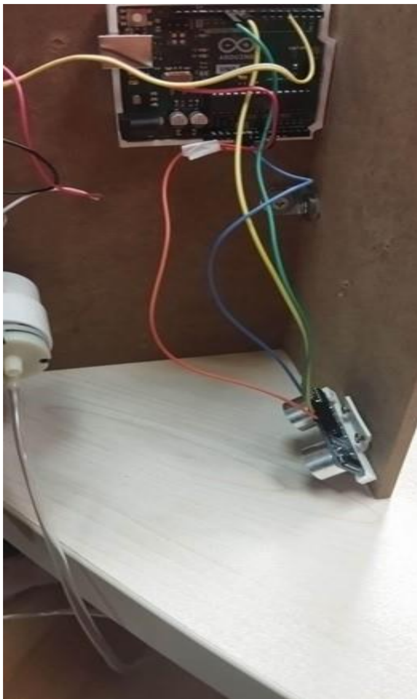
Εικόνα 3.8: Παρουσιάζεται ο αισθητήρας κίνησης ο οποίος τοποθετήθηκε στο κάτω μέρος της κατασκευής ώστε να λαμβάνει σωστές μετρήσεις.
