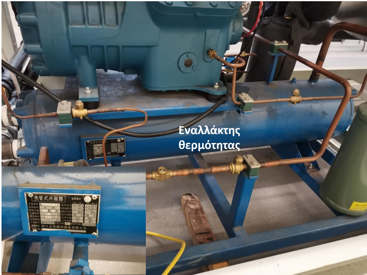
Εικόνα 3.14: Εναλλάκτης θερμότητας φρέον - νερού υδρόψυκτου συμπυκνωτή
