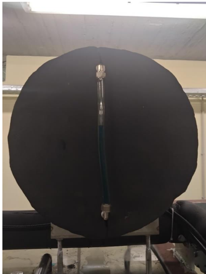
Εικόνα 3.19: Δοχείο πλήρωσης γλυκόλης
