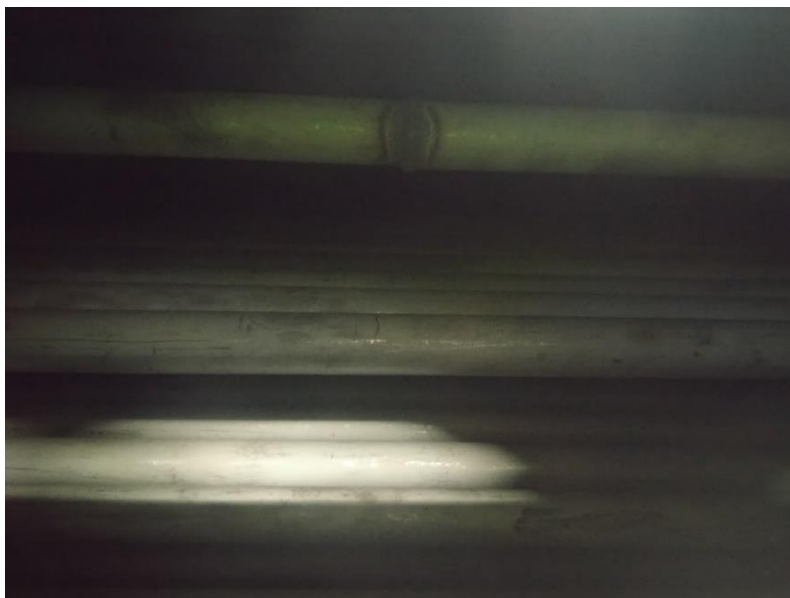
Εικόνα 3.24: Σωληνώσεις συμπύκνωσης νερού (παγοπαγίδα)
