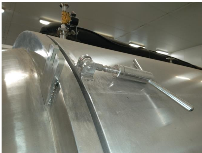
Εικόνα 3.3 Φωτογραφία Περικοχλίων Ασφαλείας Πόρτας Κενού
