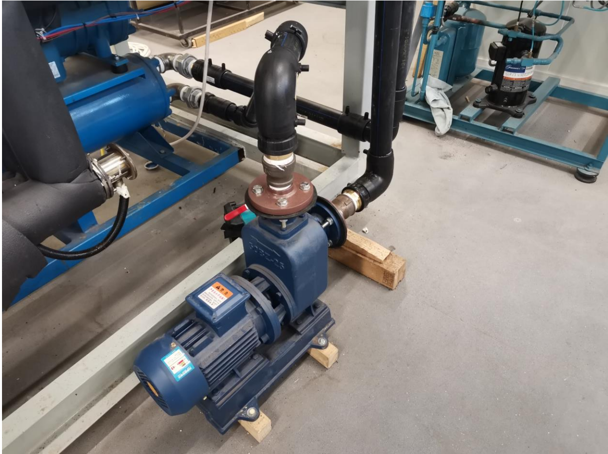
Εικόνα 3.15: Αντλία κυκλοφορίας νερού εναλλάκτη θερμότητας και πύργου ψύξης
