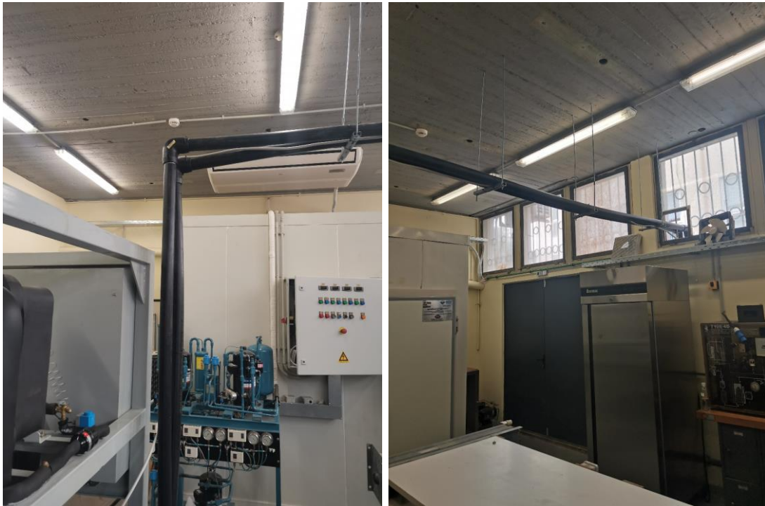
Εικόνα 3.16: Δίκτυο σωληνώσεων νερού
