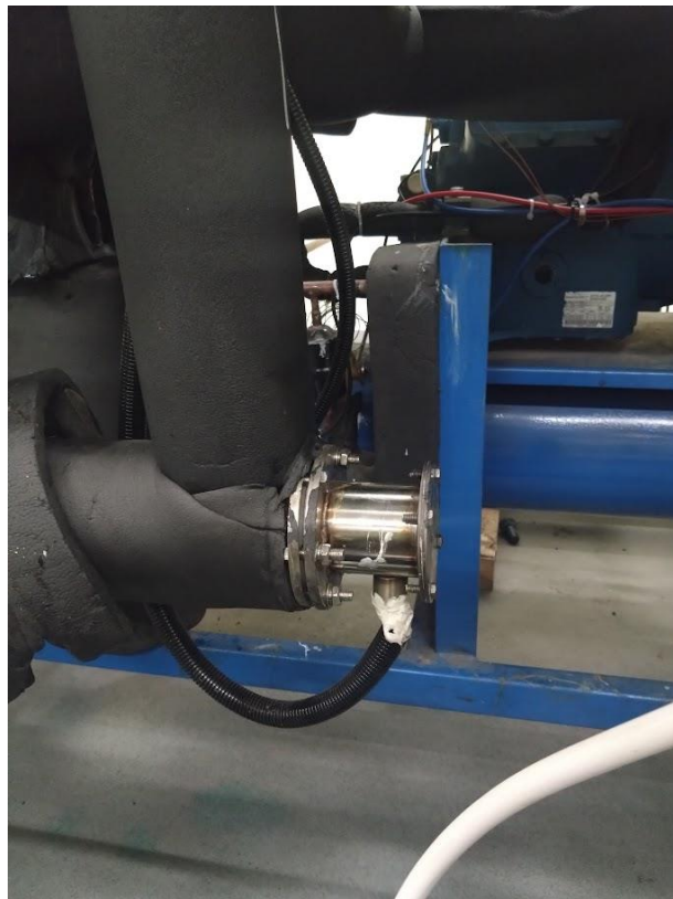
Εικόνα 3.22: Αντίσταση θέρμανσης γλυκόλης
