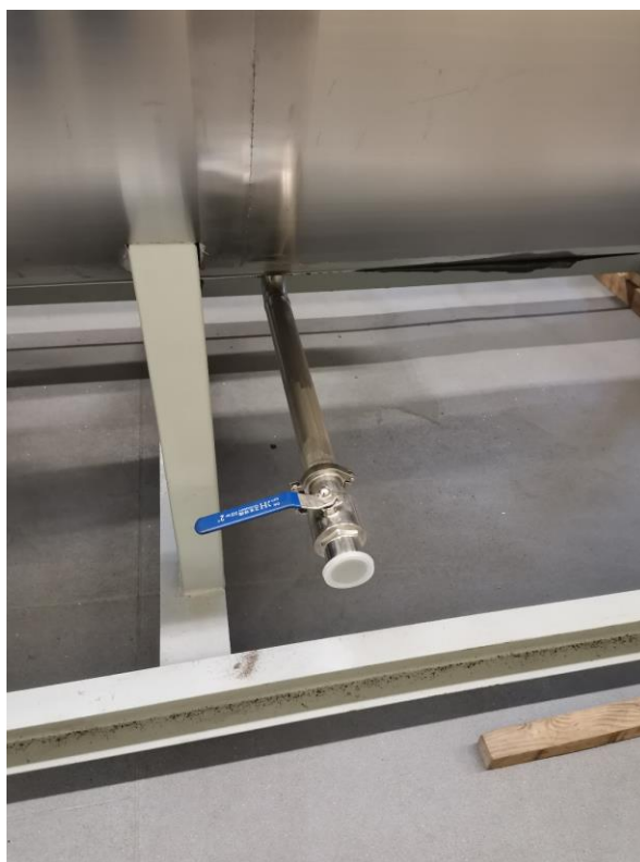
Εικόνα 3.7 Αγωγός απορροής νερού τροφίμων
