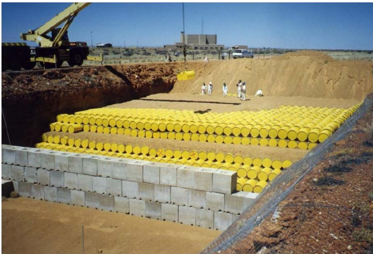
Εικόνα 3.8: Προσωρινή αποθήκευση πυρηνικών καταλοίπων
