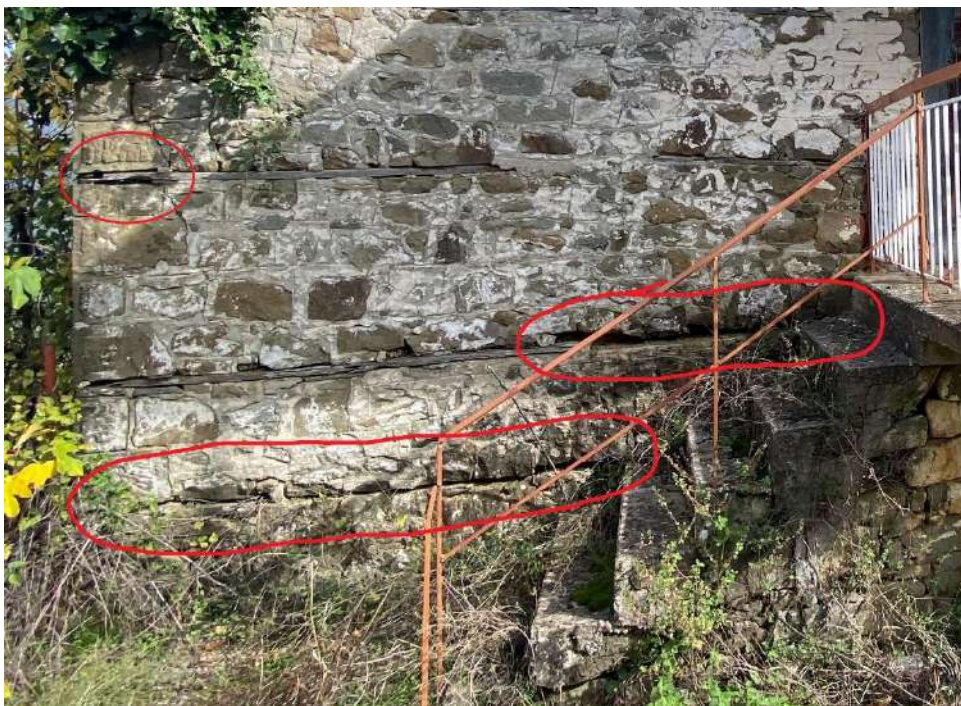
Εικόνα 24. Φθορά ξύλινων στοιχείων τοιχοποιίας.
