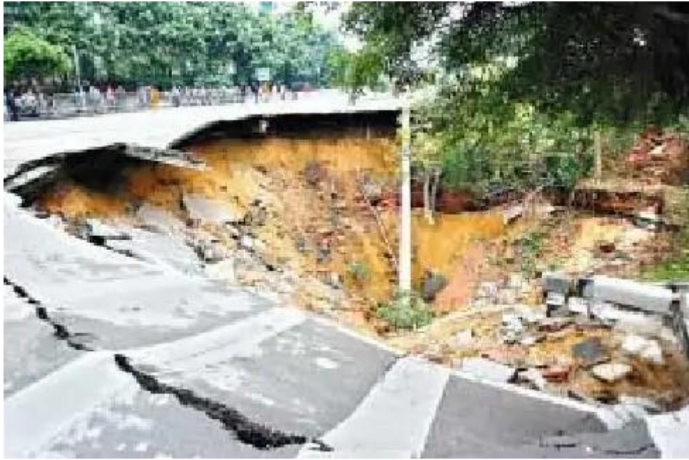
Εικόνα 4.46: Κατασκευαστική αστοχία που προκάλεσε η κατάρρευση της Γραμμής 5 – Ιανουάριος 2008
