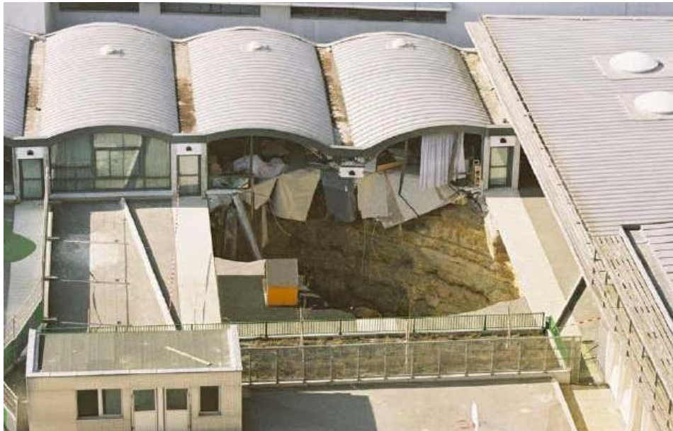
Εικόνα 4.28: Κατασκευαστική αστοχία μετρό σήραγγας Μετέωρο
