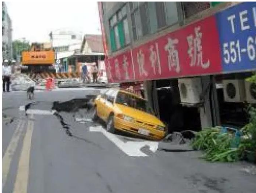
Εικόνα 4.35: Κατάρρευση σήραγγας μετρό Καοσιούγκ – Αύγουστος 2004
