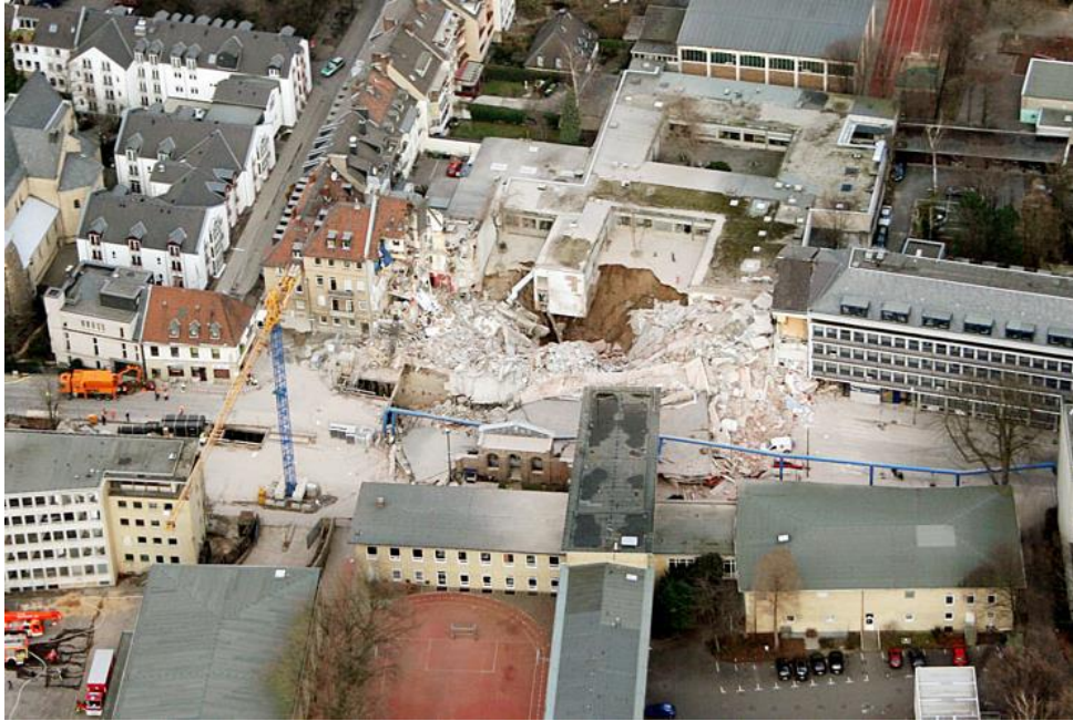
Εικόνα 4.50: Κατασκευαστική αστοχία που προκάλεσε η Γραμμή Μετρό Βορρά-Νότου – Μάρτιος 2009
