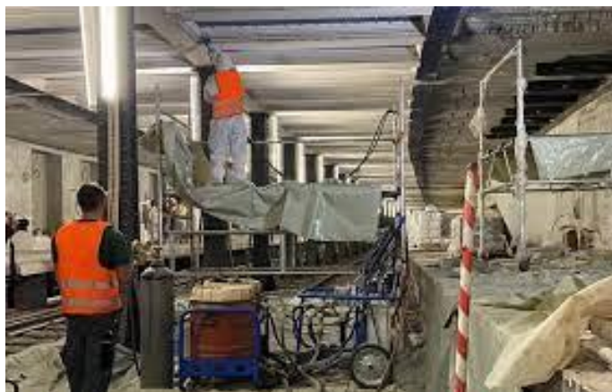
Εικόνα 4.61: Κατασκευαστική αστοχία που προκάλεσε το μετρό του Ρίου – Μάιος 2014
