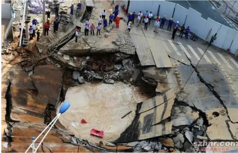
Εικόνα 4.57: Κατασκευαστική αστοχία που προκάλεσε ο Σιδηρόδρομος Σέντζεν
