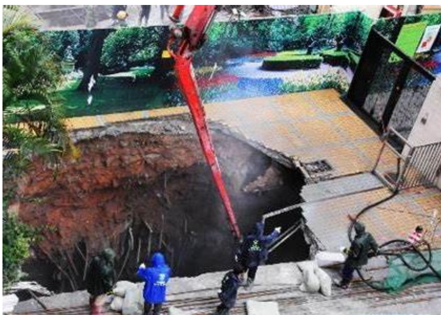
Εικόνα 4.30: Κατασκευαστική αστοχία μετρό Σανγκάη – Κίνα 2003
