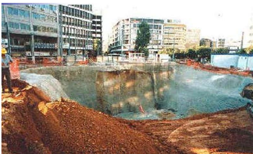
Εικόνα 4.21: Κατασκευαστική αστοχία μετρό Αθήνας
