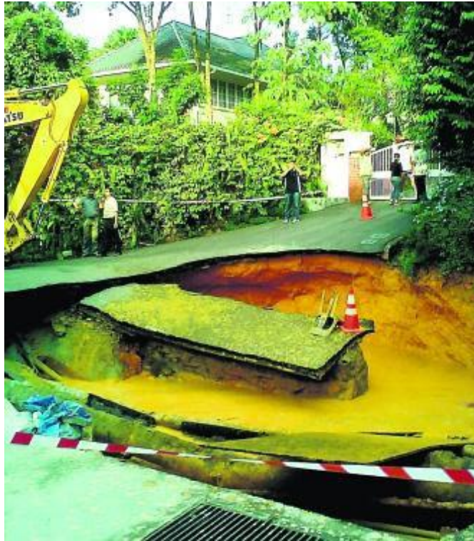
Εικόνα 4.48: Κατασκευαστική αστοχία που προκάλεσε η σήραγγα – Μάιος 2008
