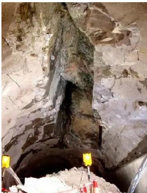
Εικόνα 4.43: Κατάρρευση σήραγγας Χάνεκλειβ – Δεκέμβριος 2006
