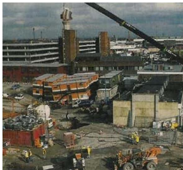
Εικόνα 4.17: Κατασκευαστική αστοχία σήραγγας Χίθροου Εξπρές – Οκτώβριος 1994
