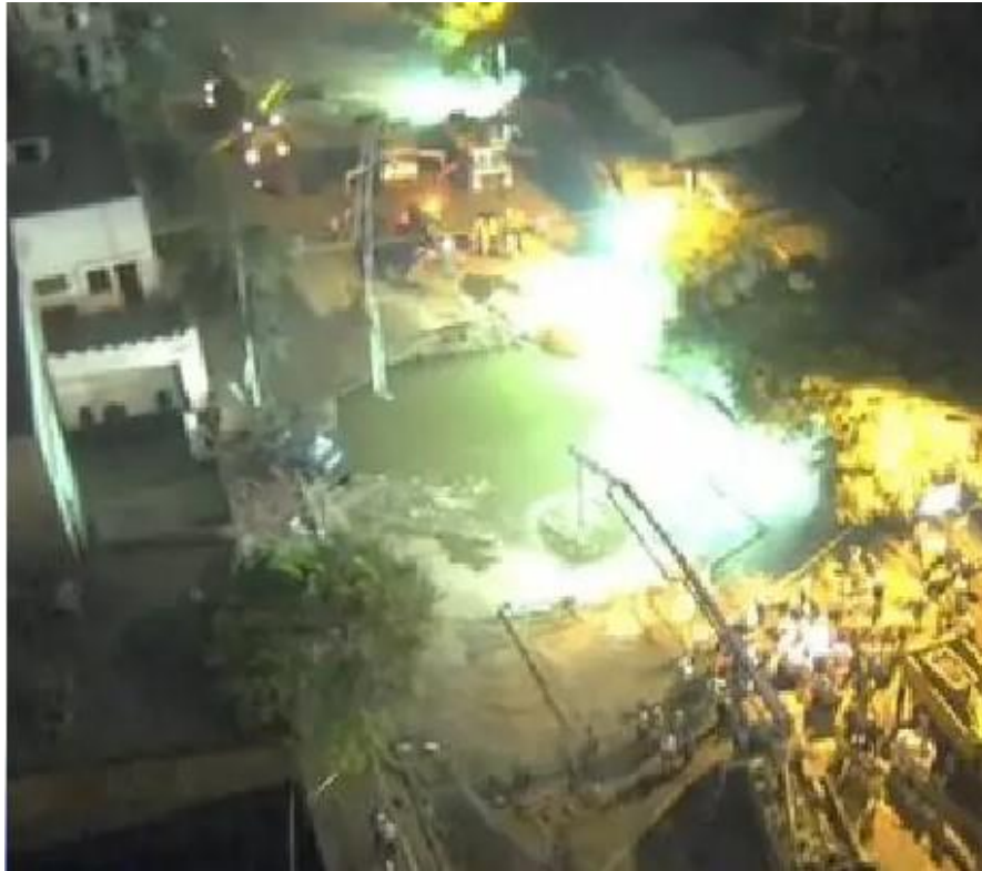
Εικόνα 4.54: Κατασκευαστική αστοχία που προκάλεσε η σήραγγα μετρό του Κάιρο – Σεπτέμβριος 2009
