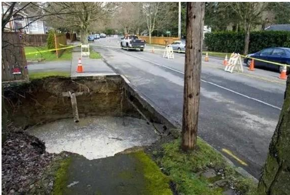
Εικόνα 4.51: Κατασκευαστική αστοχία που προκάλεσε η σήραγγα – Μάρτιος 2009
