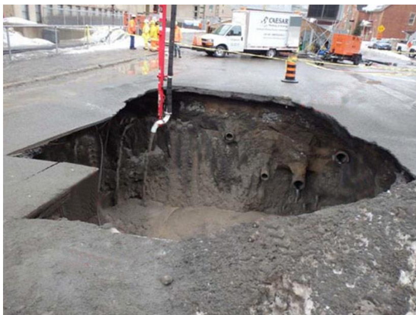
Εικόνα 4.60: Κατασκευαστική αστοχία που προκάλεσε το έργο του σιδηροδρόμου της Οκτάβας – Φεβρουάριος 2014
