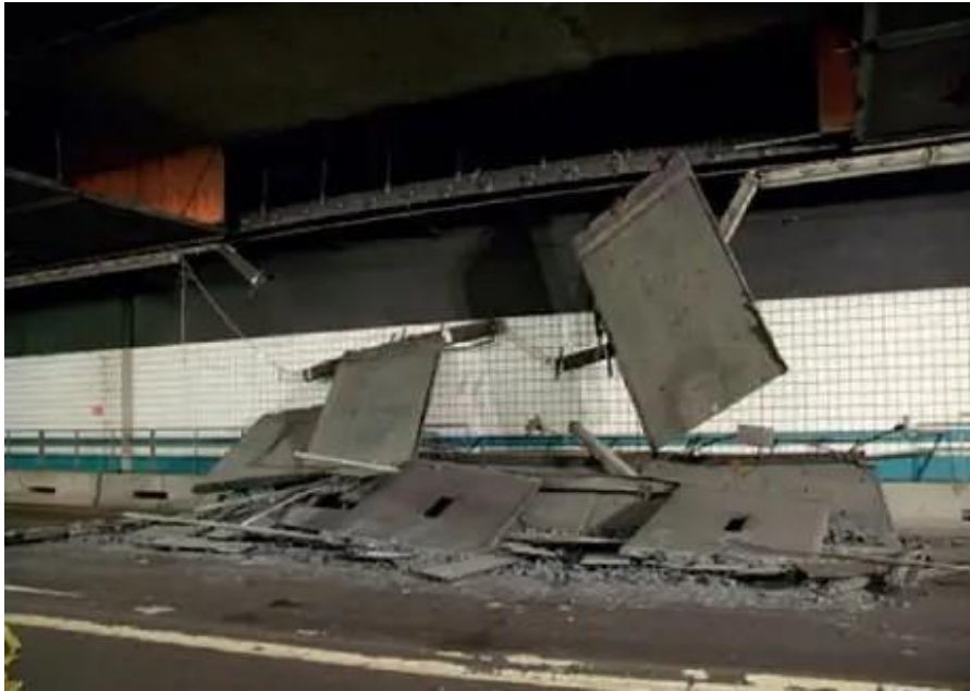
Εικόνα 4.42: Κατάρρευση οροφής σήραγγας σύνδεση 90 – Ιούλιος 2006
