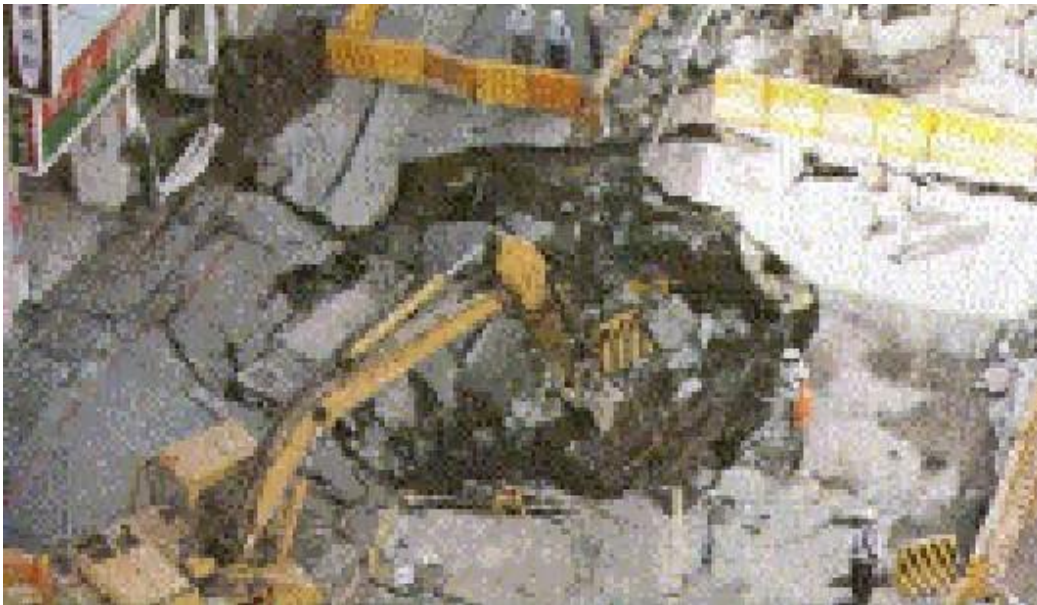
Εικόνα 4.33β: Κατάρρευση Μετρό Καοσιούγκ – Ταιβάν 2004
