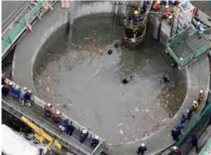
Εικόνα 4.58: Κατασκευαστική αστοχία που προκάλεσε η υποθαλάσσια σήραγγα Μιζουσίμα – Φεβρουάριος 2012
