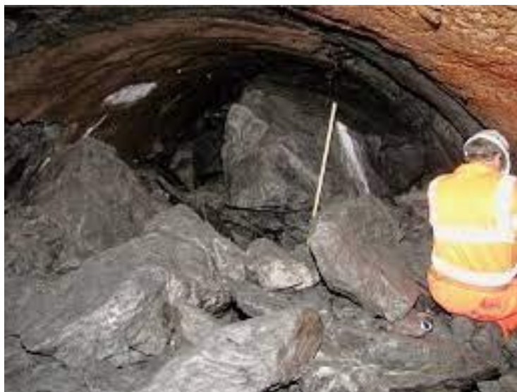
Εικόνα 4.53: Κατασκευαστική αστοχία που προκάλεσε η σήραγγα Γκλέντοου Χέντρεις – Αύγουστος 2009
