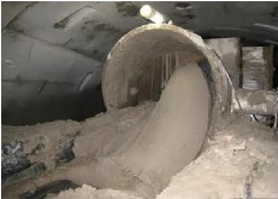
Εικόνα 4.47: Κατασκευαστική αστοχία που προκάλεσε η αποχέτευση δρόμου Λάνγκσταφ – Μάιος 2008
