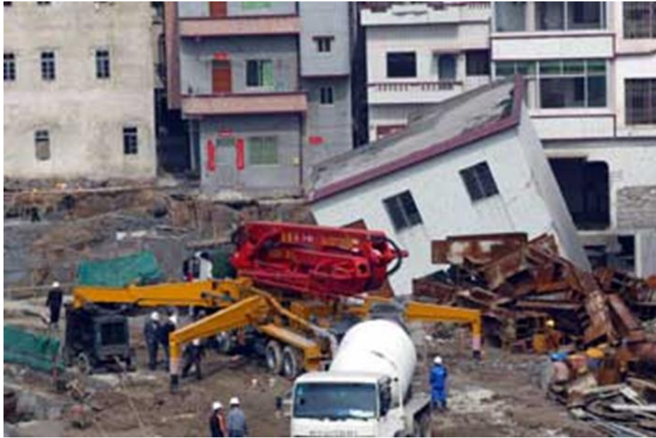
Εικόνα 4.32: Κατάρρευση Μετρό Γκουανγκοτσόου (Γραμμή 3) – Κίνα 2004
