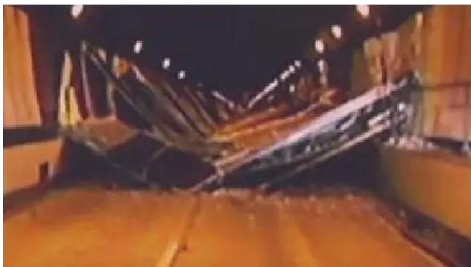
Εικόνα 4.59: Κατασκευαστική αστοχία που προκάλεσε η σήραγγα Σασάγκο – Δεκέμβριος 2012
