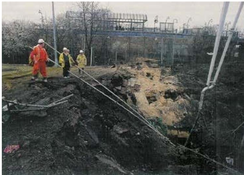
Εικόνα 4.20: Κατασκευαστική αστοχία μετρό Ντόγκλαντ – Φεβρουάριος 1998
