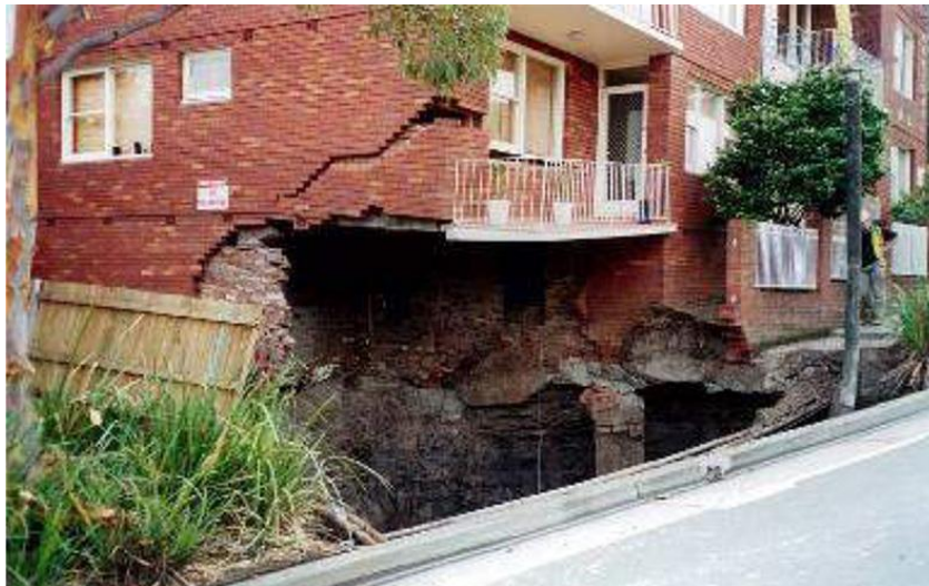
Εικόνα 4.39: Ζημίες που προκλήθηκαν από την κατάρρευση σήραγγας – Νοέμβριος 2005
