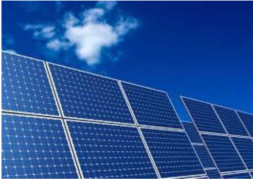
Εικόνα Ε8: Φωτοβολταϊκή εγκατάσταση για εκμετάλλευση ηλιακής ενέργειας και παραγωγή ηλεκτρικής ενέργειας
