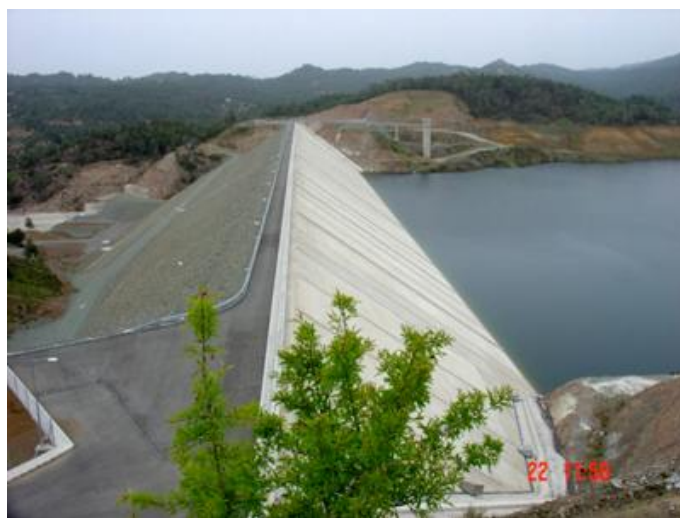
Εικόνα 3: Το φράγμα Κανναβιού στη Κύπρο με εξελιγμένη τεχνολογία
