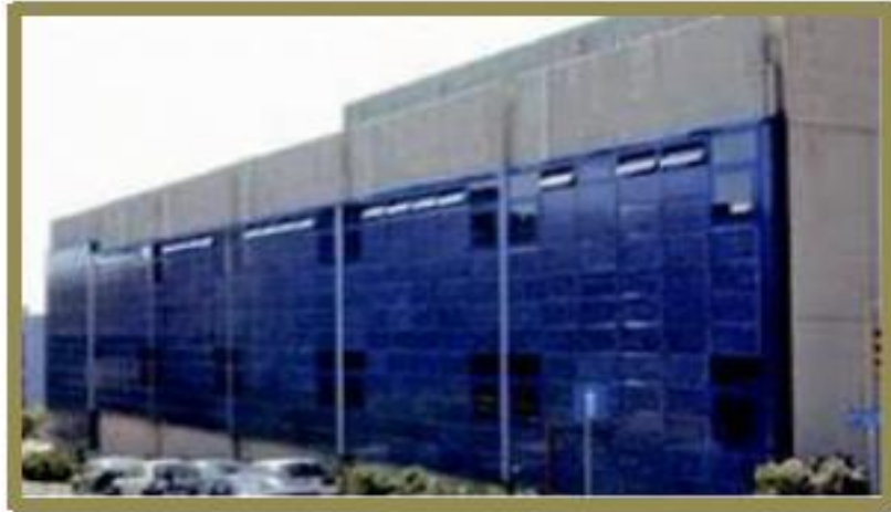
Εικόνα 28: Φωτοβολταϊκά σε πρόσοψη κτιρίου (Γερμανός – Sunlight).
