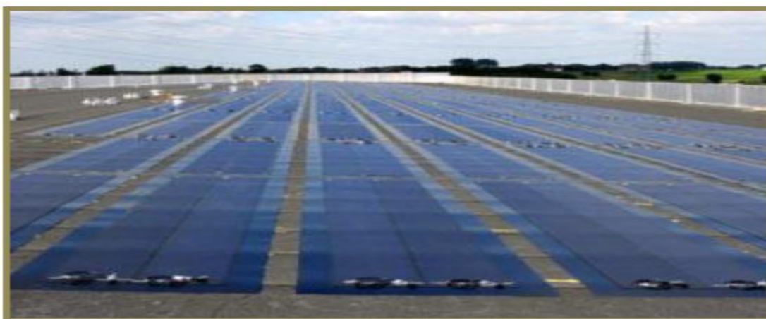
Εικόνα 18: Εγκατεστημένα εύκαμπτα φωτοβολταϊκά συστήματα (Πηγή: www.solarserver.com )
