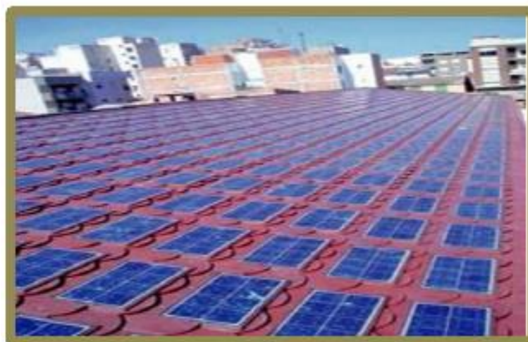
Εικόνα 24: Φωτοβολταϊκά σε κεκλιμένη στέγη με κεραμίδια (Πηγή: Solsureste).
