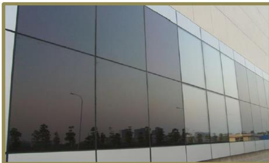
Εικόνα 17: Ημιαδιαφανή φωτοβολταϊκά στοιχεία σε πρόσοψη κτιρίου (Πηγή: www.ecotimes.gr ).
