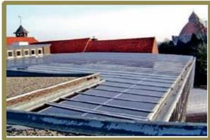
Εικόνα 25: Φωτοβολταϊκά σε επίπεδη στέγη (Πηγή: SSG).
