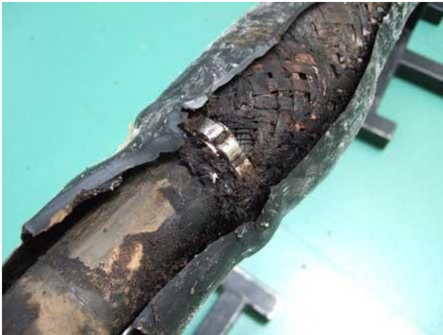
Εικόνα 1.12 Αστοχία σε μια εγκατεστημένη μάτιση δύο καλωδίων. [24]
