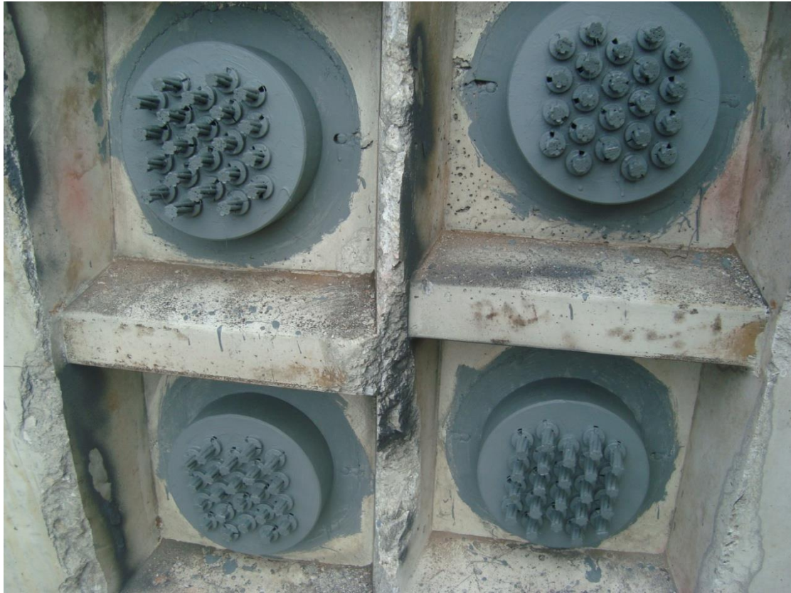
Φωτογραφία 5.19 Προστασία τενόντων από διάβρωση.
